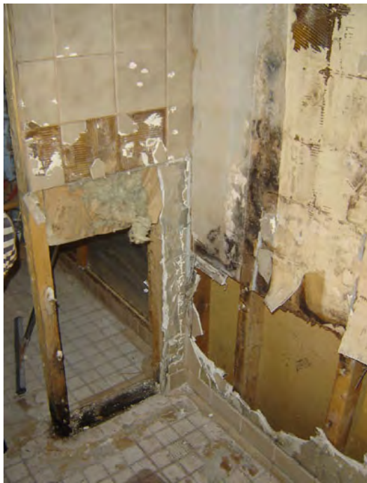
Puutteellinen vesieristys kylpyhuoneessa voi aiheuttaa pahoja kosteus- ja homevaurioita ja johtaa mittaviin korjauksiin
