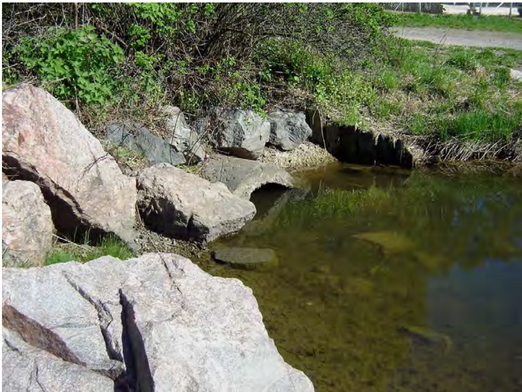
Kuva 6. Sekaviemärin ylivuotopaikka Taivallahdessa. Kuva: Paula Nurmi.
