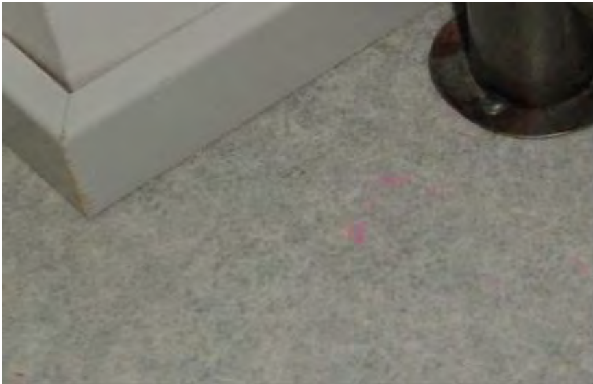
Kuva 13. Eräissä kohdeyhtiön asunnoissa todettiin lattian muovimatoissa värjäytymiä.
