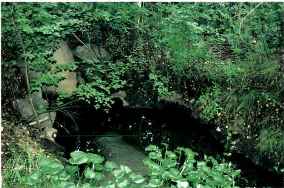
Kuva 69. Likavettä laskeva sadevesiviemäri Reimarlanojassa.
