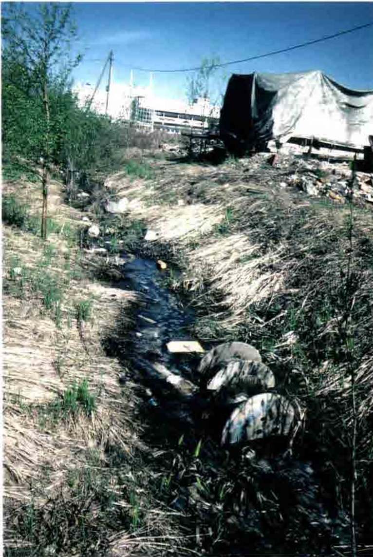
Kuva 68. Ruosilantienojan pahasti roskaantunut ojauoma. Kyseisellä kohdalla veden pH alenee nopeasti.
