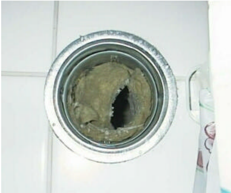
Kuva 6. Kohteen KP-15 poistoilmaventtiilissä ollut vaimennuskappale
