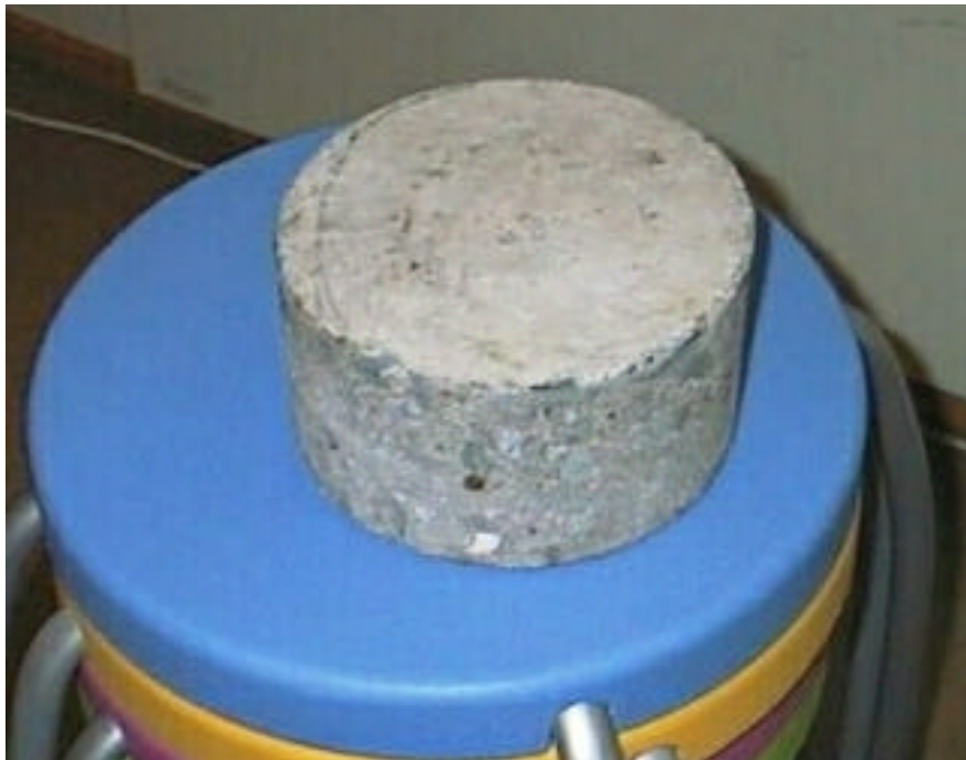
Kuva 5. Kohteen KP-13 korvausilmaventtiilissä ollut betonipala
