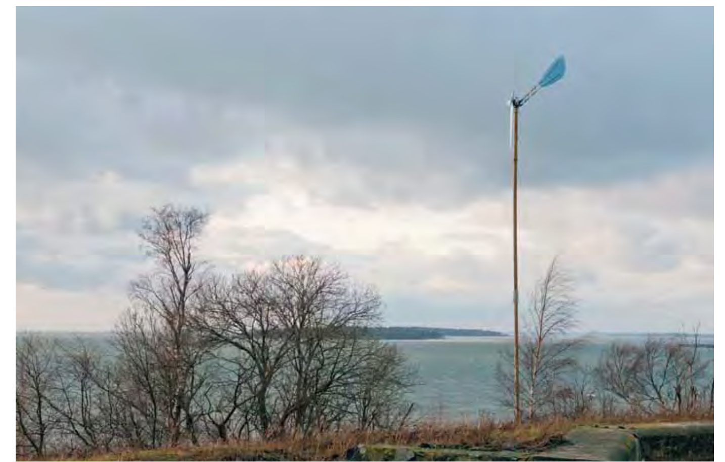
Neljän kilowatin tehoinen pientuulivoimala pystytettiin Harakan saarelle 16.12.2011. Se vähentää luontokeskuksen hiilijalanjälkeä noin 16 %.
