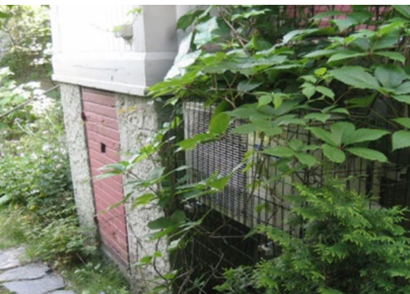
(Alla) Ilmalämpöpumpun huomaamaton sijoitus ja laitteen yksinkertainen suojaus köynnösrtilän avulla Tapanilassa sijaitsevan pientalon pihajulkisivun sokkelissa.
