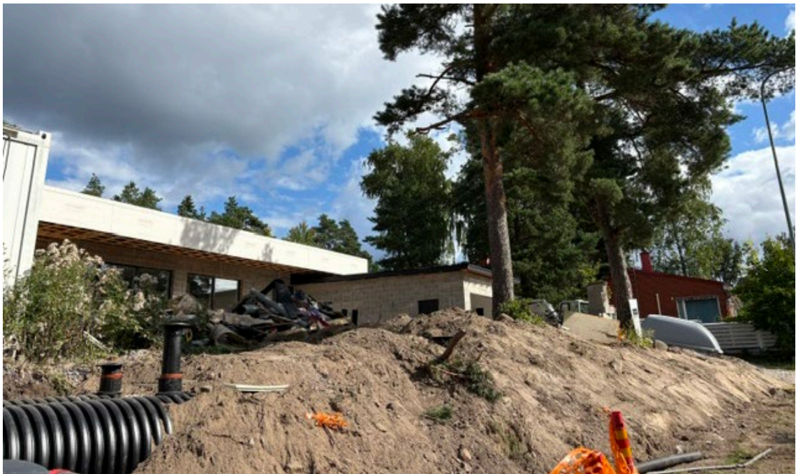
Kuva 1. Puiden juuristoalue ei ole tarkoitettu työmaan varastointialueeksi tai kaivumassojen välisijoituspaikaksi. Tällä työmaalla tontin arvokkaimmat puut on valitettavasti jätetty täysin suojaamatta.
