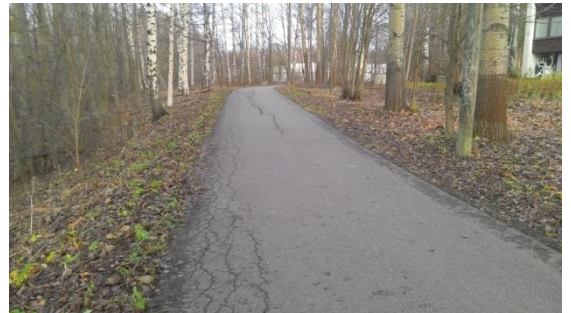
Kuva 34. Mustapuronpolku, väylä on paikoin huonokuntoinen ja sijaitsee nykyisellään "baanan" tavoiteverkolla, kunnostustarve.
