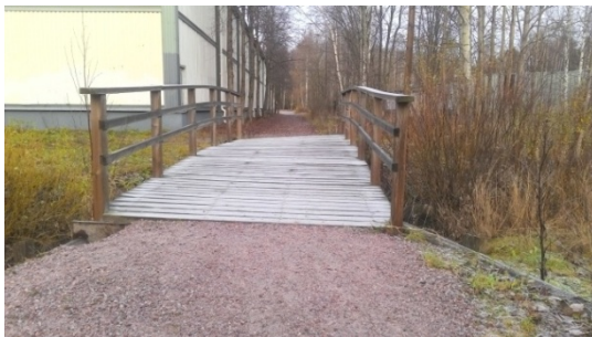
Kuva 27. Mustapuronpolku, peruskorjettava tai purettava silta.
