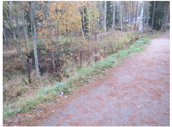
Kuva 44 Korkeakallion puiston ruosteen suoja-aita on uusimisen tarpeessa.
