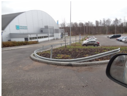
Kuva 40. Pikajuoksijan kujan kaide on vaurioitunut.
