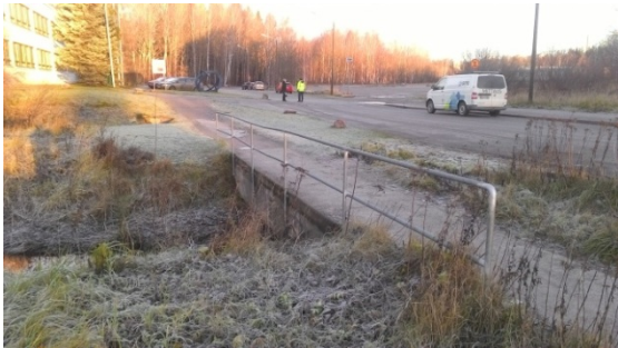
Kuva 33. Kajaaninlinnantien jalkakäytävä, joka on yhteys lukiolle, on kapea ja huonokuntoinen. Sitä voisi levenittää kadun puolelle.
