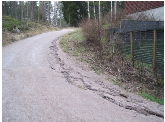
Kuva 17. Hallainvuorentien päässä ulkoilupolun eroosioauriot pitää korjata ja hu- levedet ottaa hallintaan. Muuten kunto- luokka on 4.
