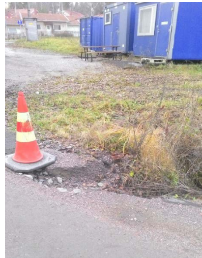
Kuva 28. Viikintien ja Viilarintien välinen polku, kunnostettava rumpu. Raitti on romahtanut rummun kohdalta.
