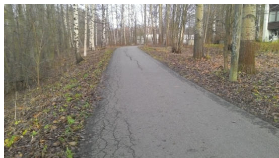
Kuva 30. Mustapuronpolku, väylä on paikoin huonokuntoinen ja sijaitsee nykyisellään "baanan" tavoiteverkolla, kunnostustarve.
