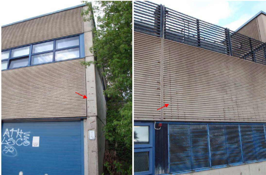
Kuvat 3 ja 4. Paikallisia julkisivuelementtien teräskorroosioaurioita.
