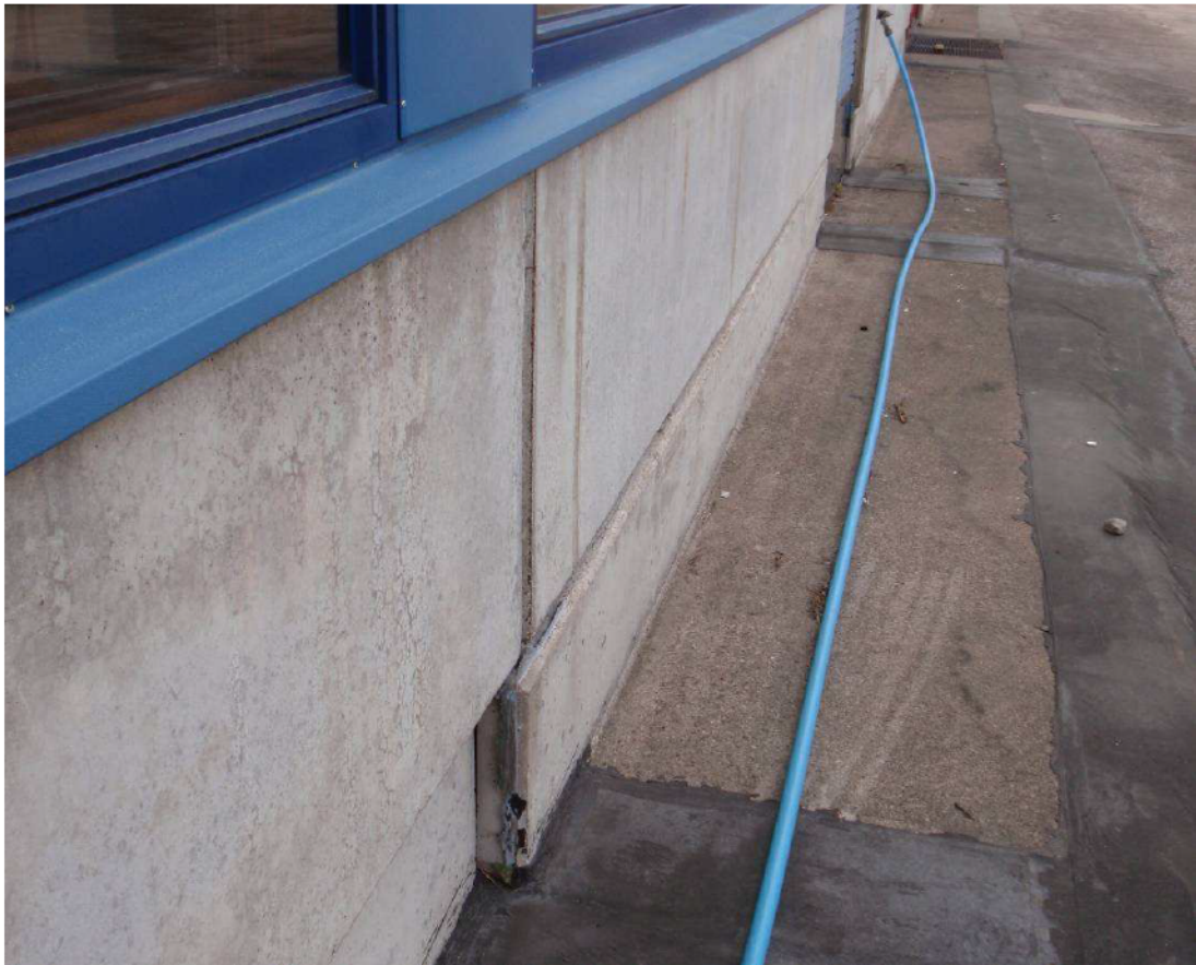
Kuva 5. Sokkelin kuorielementin siirtymää jääradan puoleisella julkisivulla.
