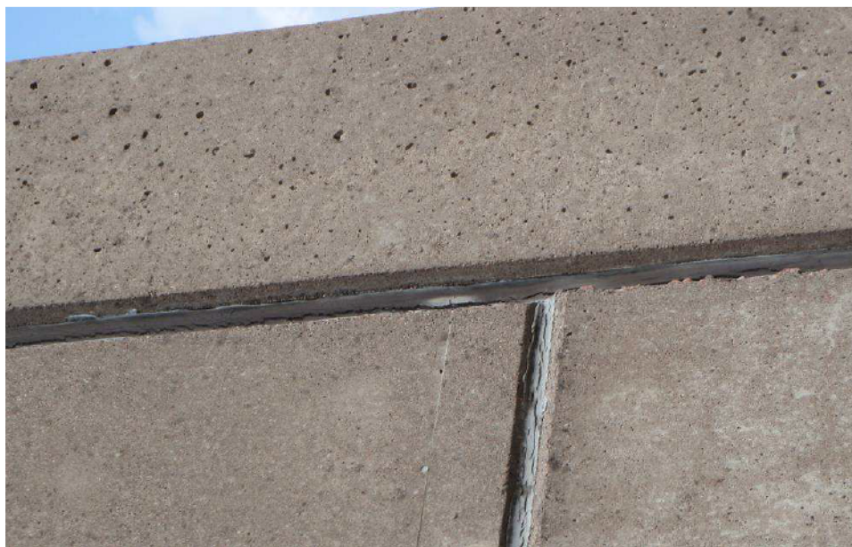
Kuva 6. Julkisivuelementtien saumat ovat monin paikoin halkeilleet ja osin irti.
