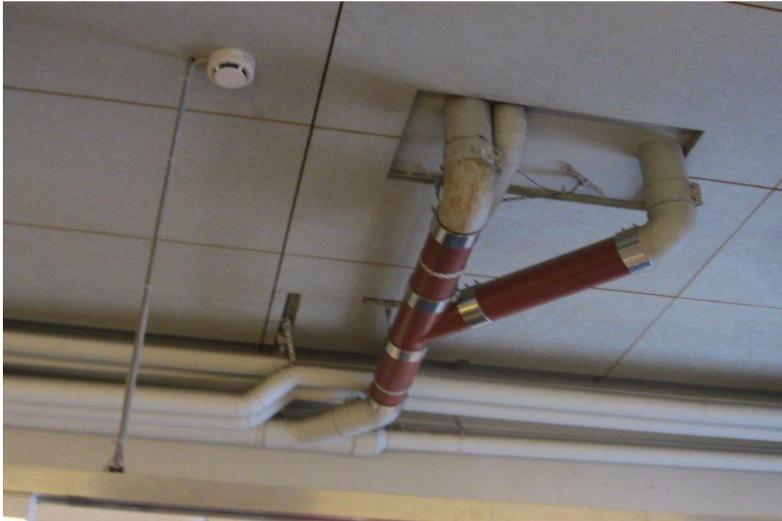
Kuva 5: Rakennuksessa on jätevesiviemärit ovat valurautaa pantaliitoksin. Verkosto on alkuperäinen lukuun ottamatta paikallisia korjauksia. Verkostolle ehdotetaan tehtäväksi peruskorjaus.
