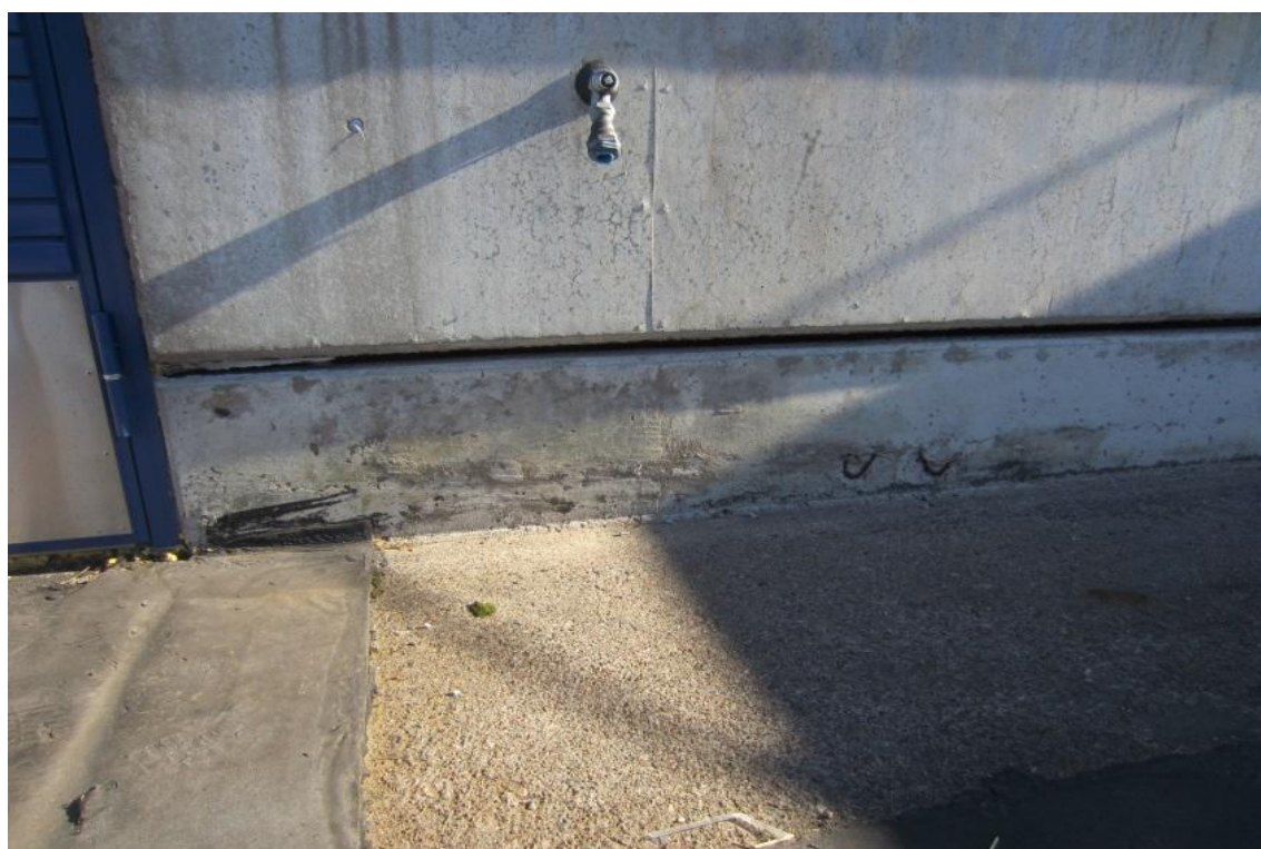
Kuva 3: Julkisivun ja sokkelin saumat olivat monin paikoin epätiivit ja puutteelliset.
