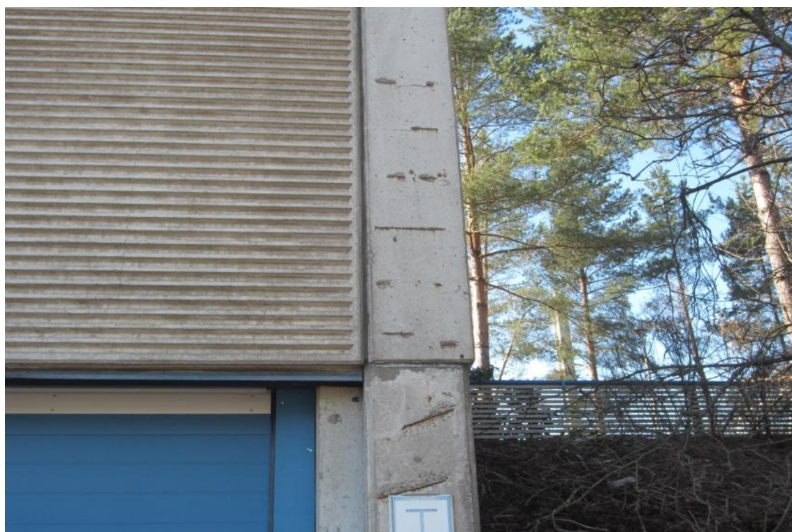
Kuva 4: Julkisivun betoniosissa havaittiin terästen korroosiota monin paikoin.
