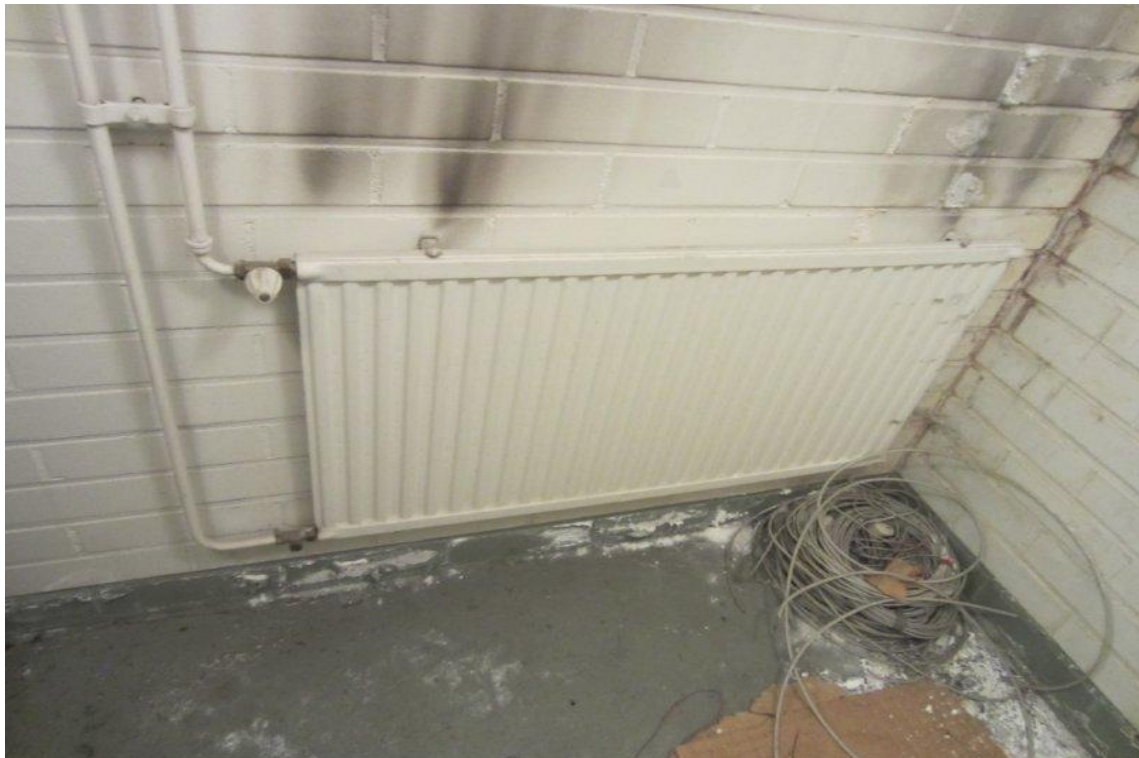
Kuva 3: Rakennusta lämmitetään pääosin vesipattereilla. Patterien kunto tulee tarkastaa ja käsikäyttöiset sekä termostaattiset patteriventtiilit ehdotetaan uusittavaksi.
