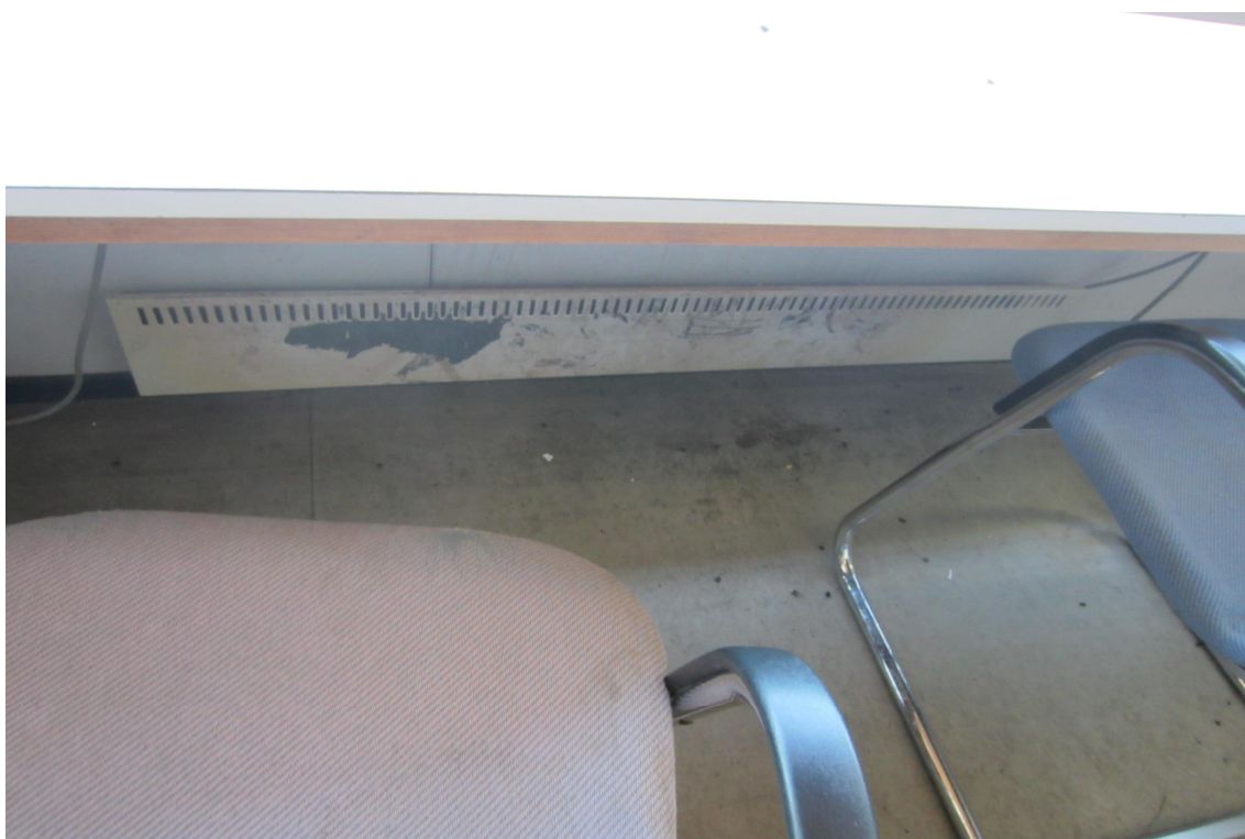
Kuva 5: Selostamossa on vanhoja sähkölämmittimiä.
