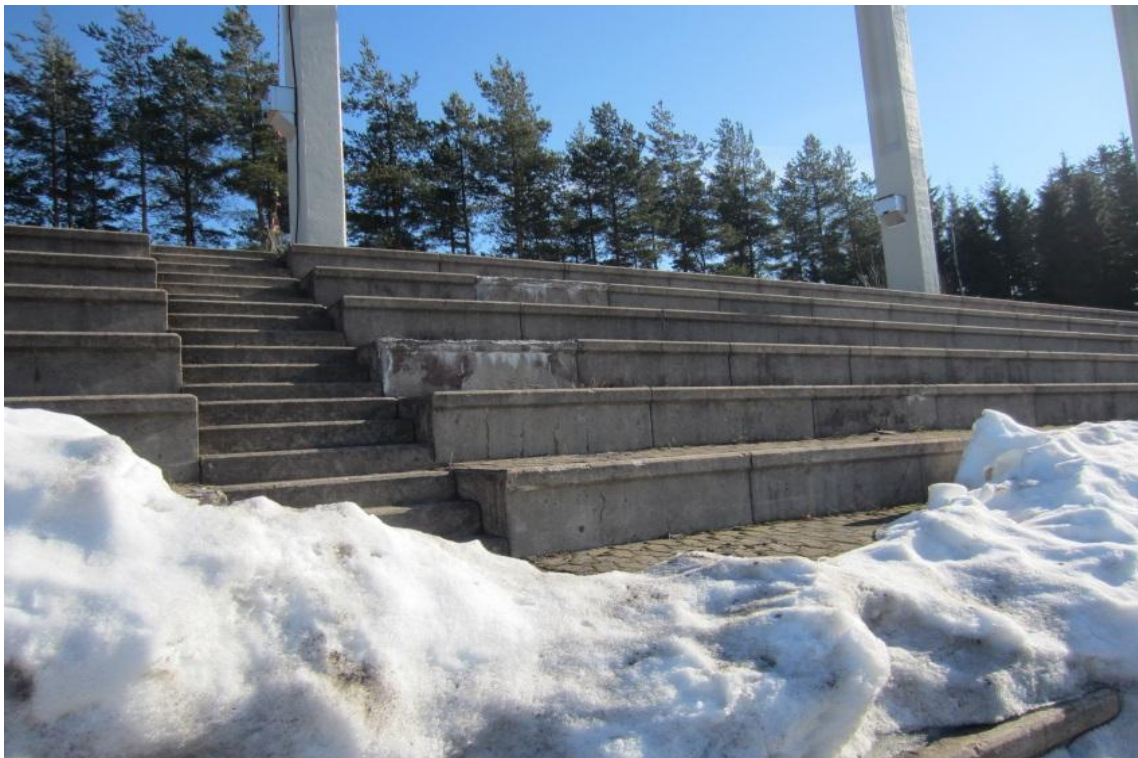
Kuva 2: Betonilaattapintaaisessa katsomon osassa havaittiin vaurioita sekä painumia.
