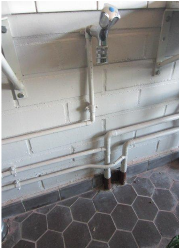
Kuva 7: Käyttövesijohdot ovat kuparia kapillaariiliitoksien. Verkostolle ehdotetaan tehtäväksi peruskorjaus.
