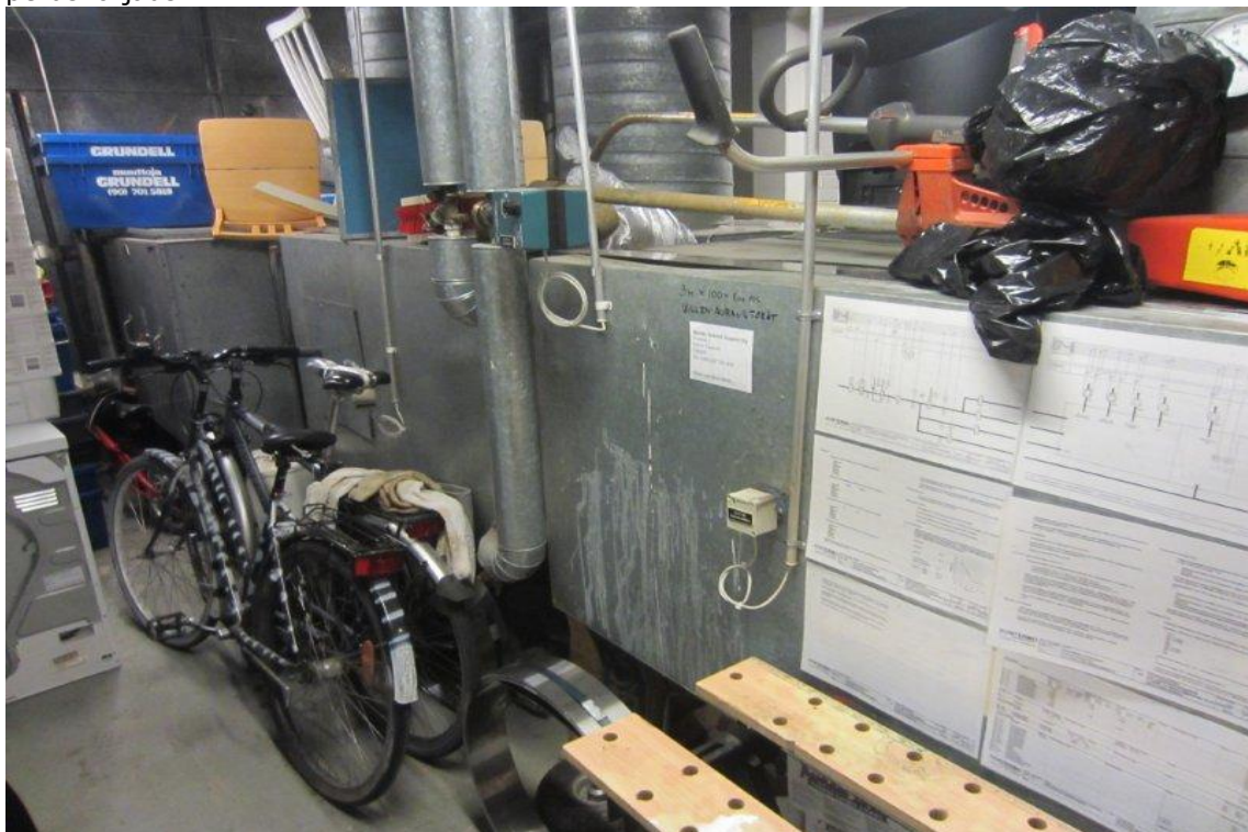
Kuva 8: Rakennuksessa on kaksi pääilmanvaihtokojetta vuodelta 1976. Kojet varaudutaan uusimaan tarkastelujaksolla alkuosalla. Tekninen tila tulee tyhjentää ylimääräisestä tavarasta pikimmiten.
