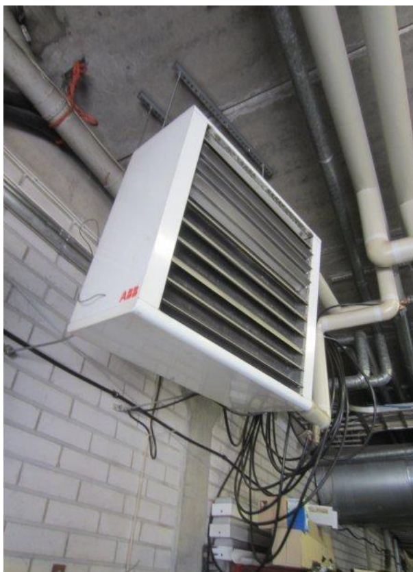
Kuva 4: Rakennuksessa on kiertoilmapuhaltimia sekä 1970-luvulta että 2000-luvulta. Kuvassa huoltohallin kiertoilmapuhallin 2000-luvulta. 1970-luvun puhaltimet ehdotetaan uusittavaksi tarkastelujaksolla.
