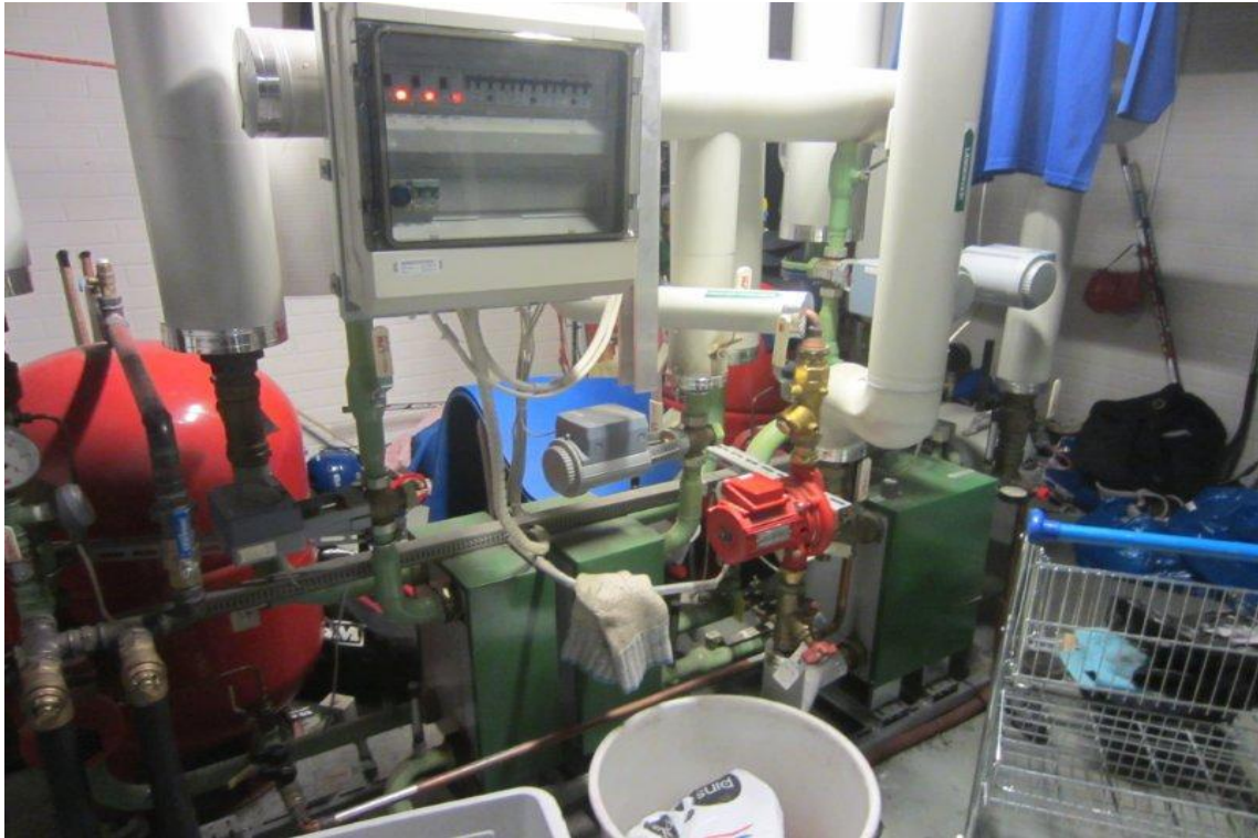
Kuva 1: Kaukolämpöalakeskuksen uusiminen on ajankohtaista tarkastelujakson lopussa tai pian sen jälkeen sen teknisen elinkaaren umpeutuessa. Lämmönjakohuoneen ylimääräinen tavara tulee siirtää muihin tiloihin paloturvallisuussyistä.
