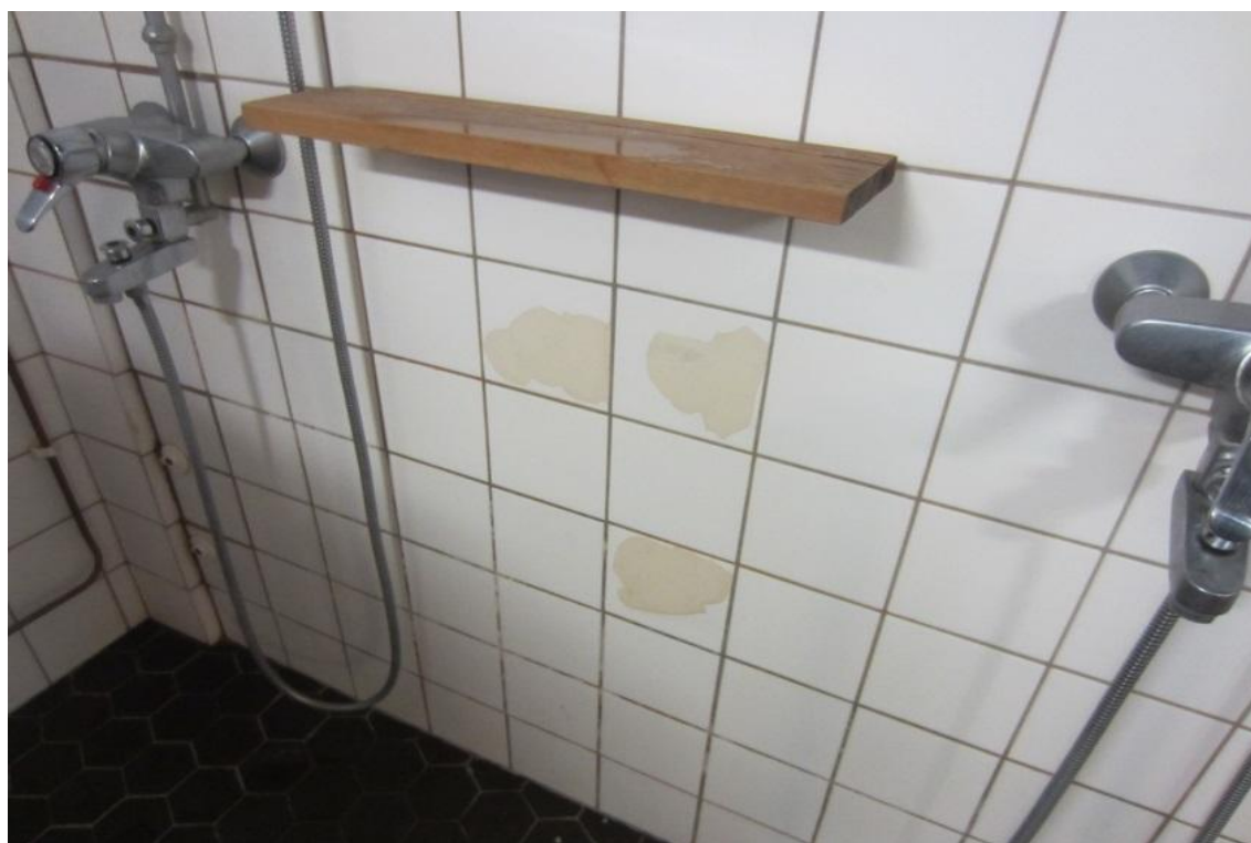
Kuva 8: Märkätilojen pintarakenteissa havaittiin vaurioita.
