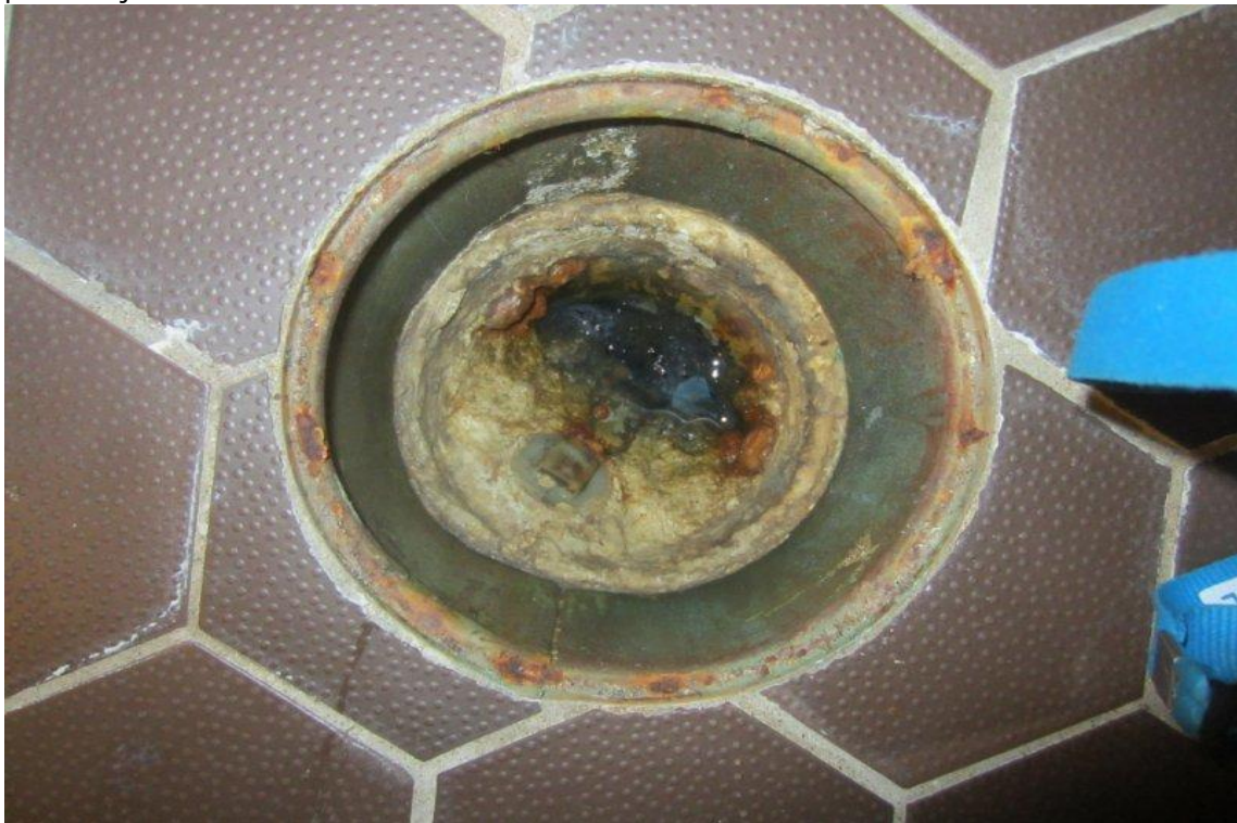
Kuva 6: Lattiakaivot ovat terästä ja osittain käyttöikänsä lopussa. Lattiakaivot uusitaan märkätilojen peruskorjausten yhteydessä.
