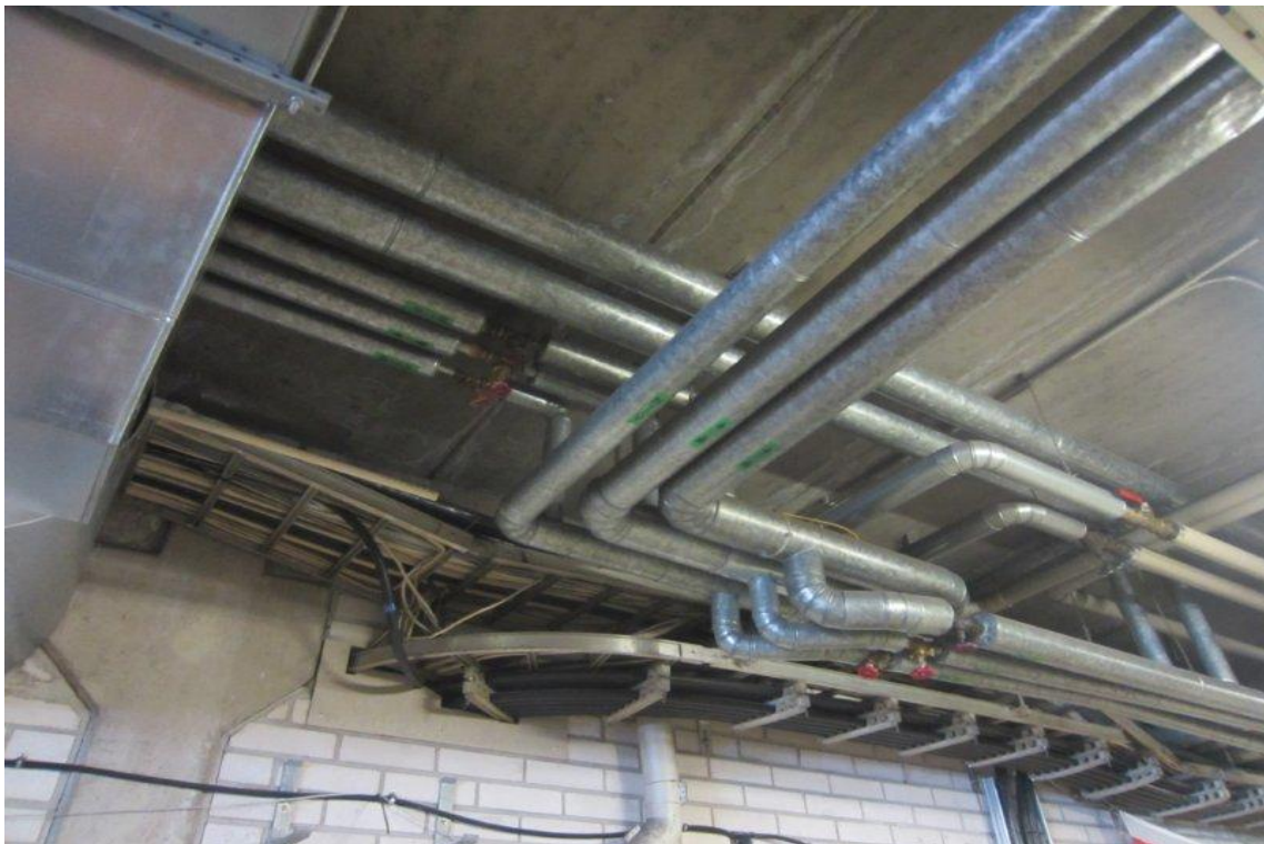
Kuva 2: Lämmitys- ja käyttövesi- ja viemäriverkostot ovat alkuperäisiä vuodelta 1976. Verkostojen peruskorjauksiin varaudutaan.
