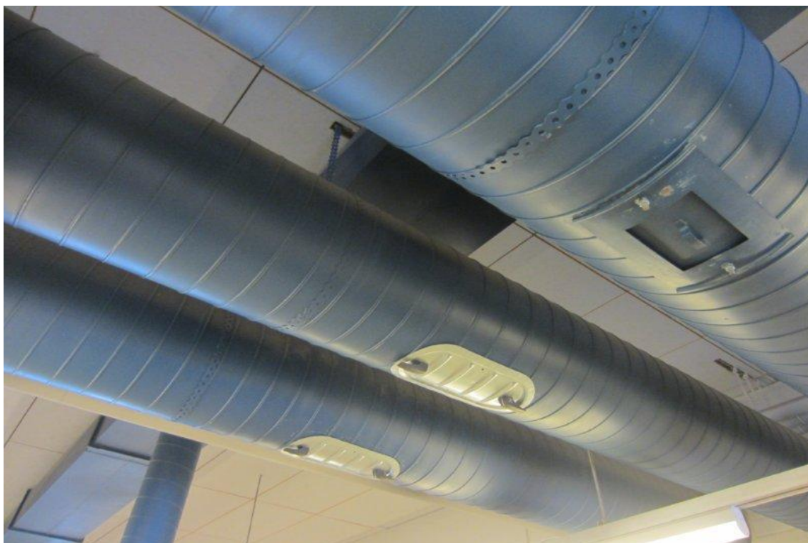
Kuva 9: Ilmanvaihtokanavisto on puhdistettu vuonna 2012. Kanavisto varaudutaan puhdistamaan seuraavan kerran tarkastelujakson loppuosalla.
