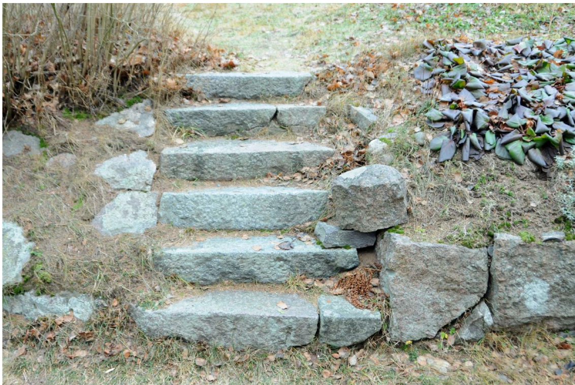
Kuva 5 Askelmat puhdistettava ja siirtyneet kivet asennettava paikoilleen.
