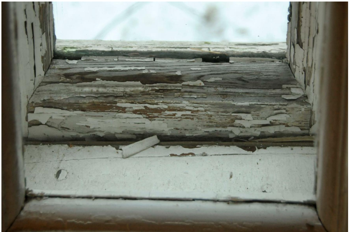
Kuva 10 Esimerkki huonokuntoisimmasta ikkunasta.
