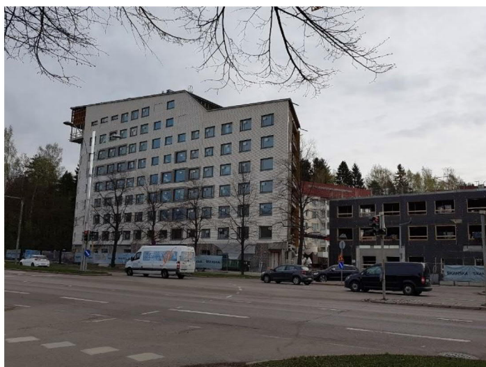
Rakuunantien risteuksen pohjoispuolelle on rakentamassa uusia kerrostaloja olemassa olevan rakennusrivin jatkoksi. Kuva huhtikuulta 2019.
