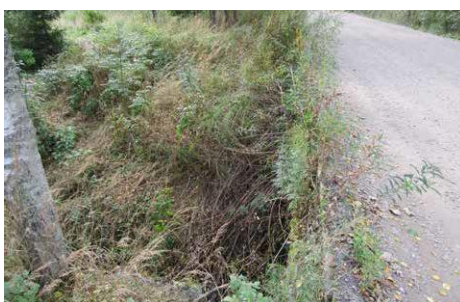
Uutelantien allittavan rummun kohdalla ei ole kaiteita vaikka tieltä ojaan on syvä pudotus.
