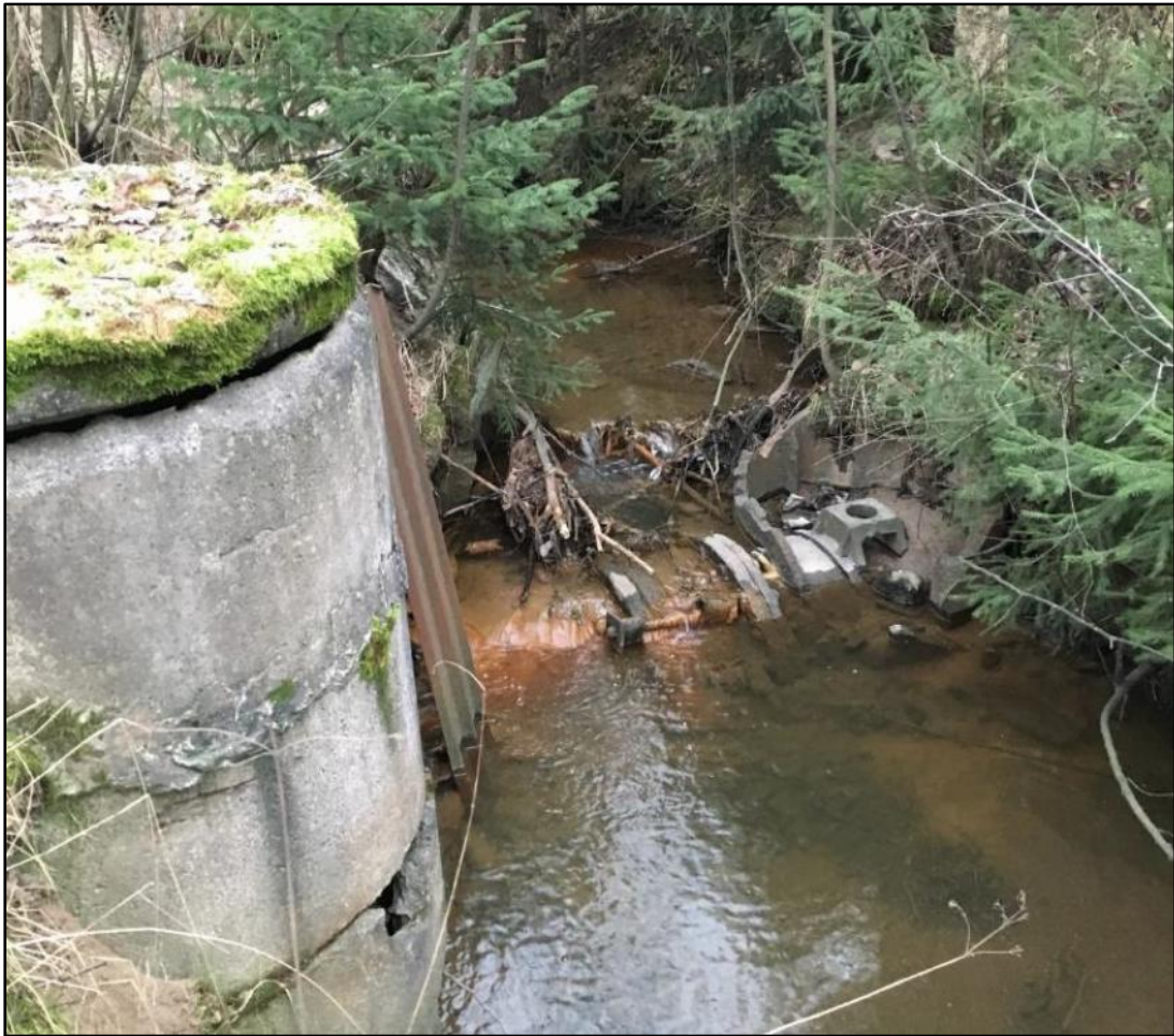
Kuva 14. Käytöstä poistettu vesijohto purku-uomassa.
