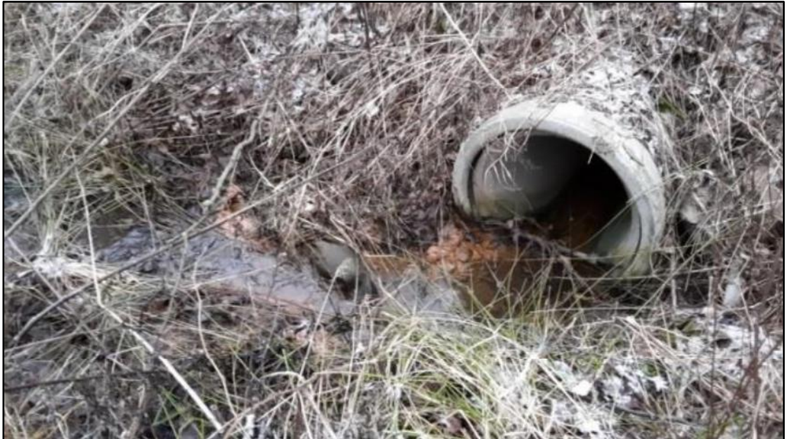
Kuva 10. Viilarintien 1000B viemäriin liittyvän 500B viemäriin suu.
