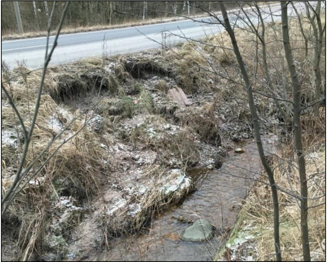
Kuva 13. Purku-uomassa on kulkenut suuria virtaamia lähes Viikintien tasossa, jotka ovat aiheuttaneet eroosiovaurioita.
