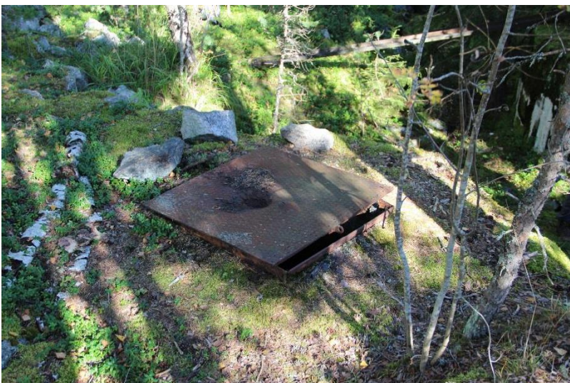
AKDG 4877:157. Itä-Villinki, kaapelikaivo. Kuvaaja: J. Lagerstedt.
