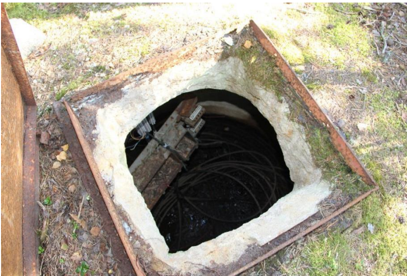
AKDG 4877:155. Itä-Villinki, kaapelikaivo. Kuvaaja: J. Lagerstedt.
