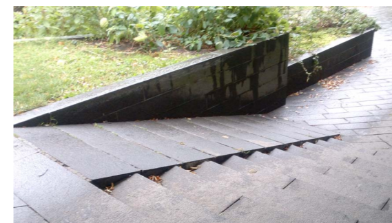
Alkuperäiset muurit, portaat ja luiskat ovat hyvin säilyneet. Kaava mahdollistaa tarpeellisten muutosten tekemisen kulkuyhteyksien parantamiseksi.
