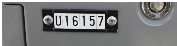
Kuva 13. Esimerkki ulkovalaistuskeskuksen merkitsemisestä.
