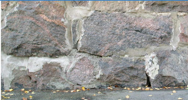
Luonnonkivisokkelin saumoja on paikattu sementtipitoisella laastilla. Kosteutta huonosti läpäisevä sementtilaasti ei aina kovuudestaan huolimatta kestä säärasitusta.
