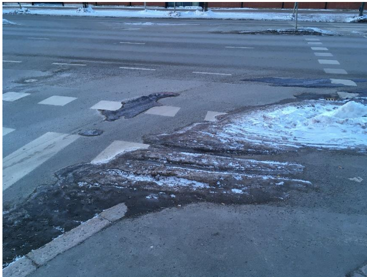
Kuva 30 Teollisuuskatu. Kunnossapito ei ole pystynyt auraamaan lunta notkosta, jolloin kohdalle muodostuu turvallisuusriski.
