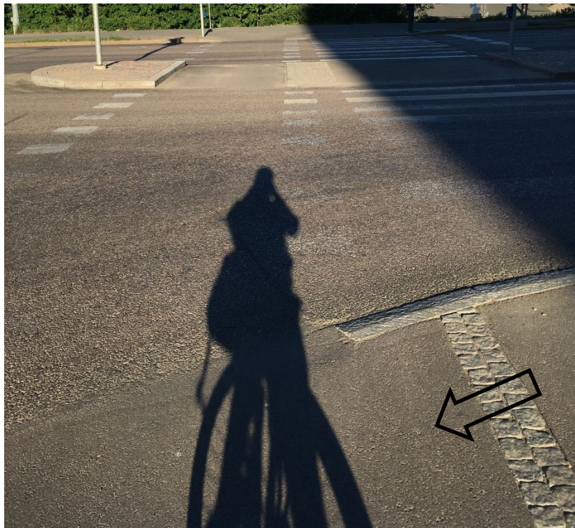
Kuva 49 Erotuskaarekkeen (kivetty alue jalankulun ja pyörätien välissä) puuttuminen saa reunakiven näyttämään rakennusvirheeltä
