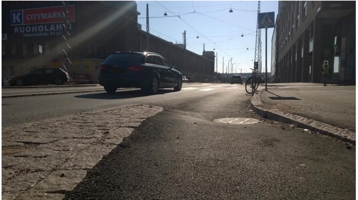
Kuva 10 Kuivatuksen suunnittelussa tulee ymmärtää pyöräliikenteen kannalta haitalliset valinnat. Kuvan kohdalle muodostuu yli 19 % sivukallistus.
