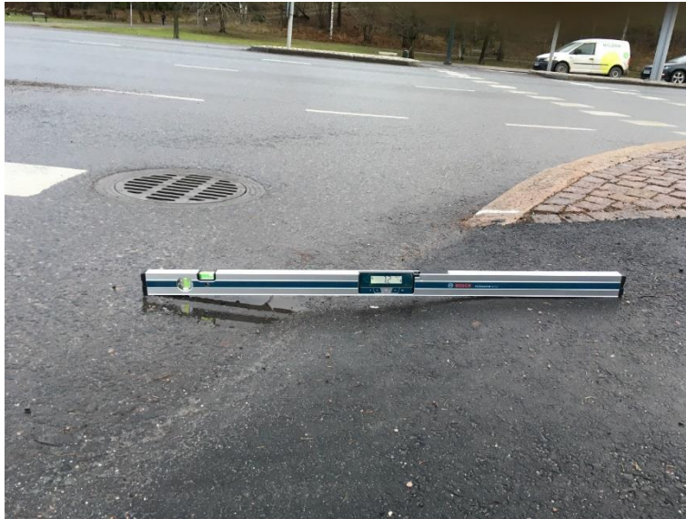
Kuva 29 Pyörätien siirtymä on erityisen jyrkkä ajoradan ja pyörätien saumakohdassa. Huopalahdentie.
