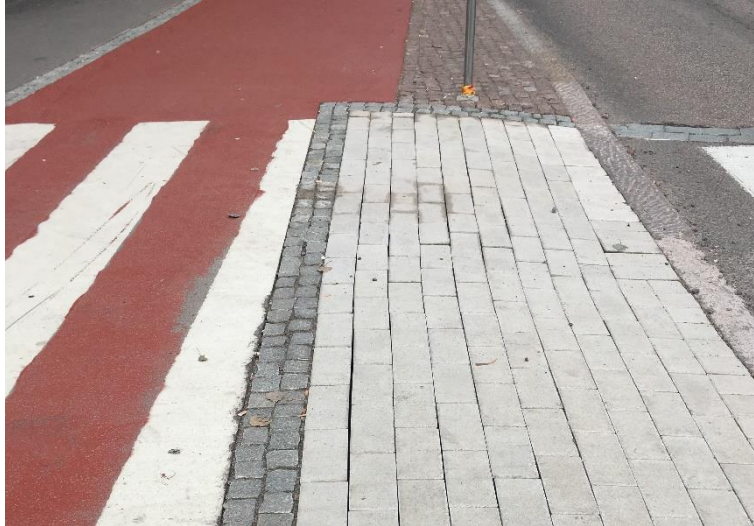
Kuva 51 Epäsiisti korjaustoimenpide Kalasatamassa. Kohteen taustat eivät ole tiedossa.
