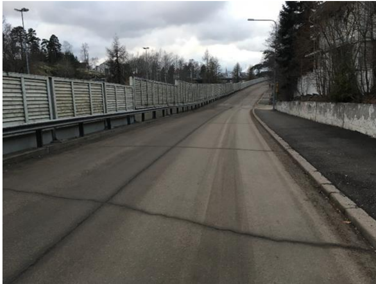
Kuva 4 Poikittaishalkeama Kulosaaren puistotiellä. Halkeamat näkyvät selkeästi, mutta tärähdys on vähäinen (todettu joulukuussa 2018). Todennäköisesti alempi asfalttikerros on vielä ehjä, eikä pinnan muoto ole muuttunut. Rengas kulkee halkeaman yli melko miellyttävästi
