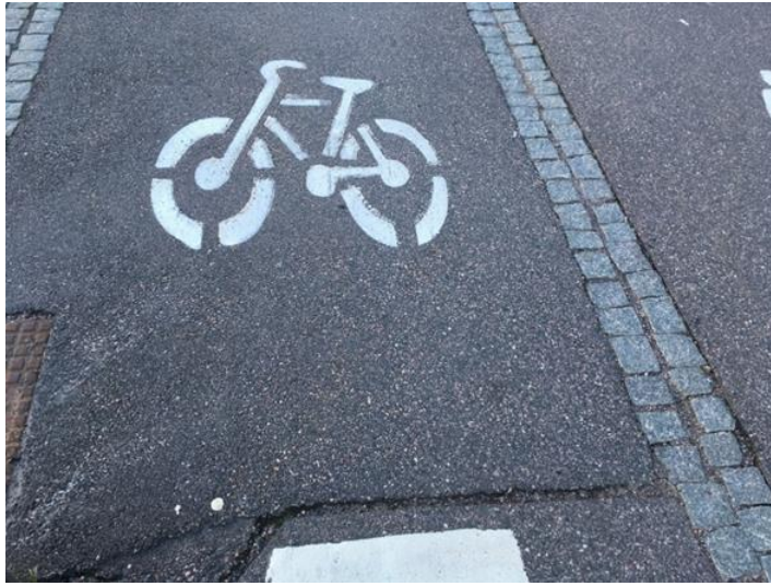
Kuva 8 Kahden asfaltin saumakohta vetäytyy ja kohdalle syntyy poikittaishalkeama ja pieni painanne.
