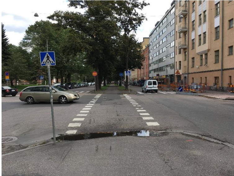
Kuva 39 Pyörätien alla rakenteet ovat painuneet eikä kuivatus toimi enää. Pyörätiestön korjausvelka Helsingissä on merkittävä
