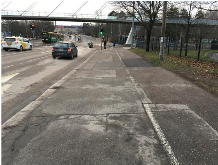
Kuva 7 pyöräteiden pintavauriot johtuvat katuverkolla yleisimmin suoraan tai välillisesti kaivannoista
