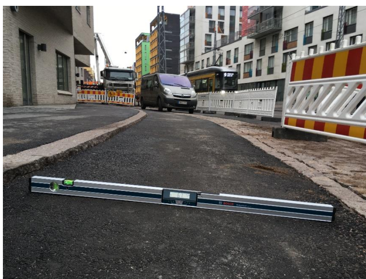
Kuva 22 Välimerenkadun linjaosuudella havaittiin 6,7 % kallistus
