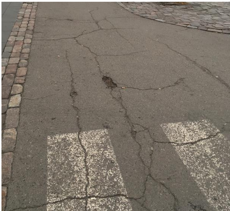
Kuva 2 Rikkoutunutta asfalttia Mannerheimintiellä
