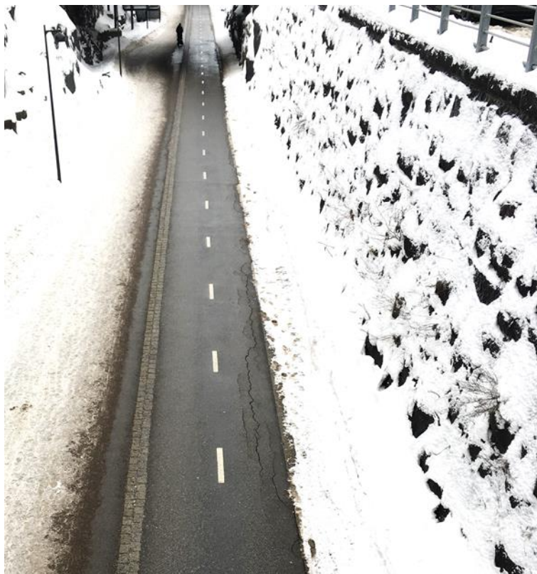
Kuva 3 Baanan asfalttipinta on osalta kohtaa pahoin vaurioitunut. Baana otettiin käyttöön v. 2012 ja se on perustettu vanhan satamaradan rakenteiden päälle. Oletettavasti pohjarakenteet olisi pitänyt rakentaa kestävämpiä ajoneuvoja.
