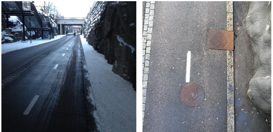
Kuva 9 Pyöräilijä väistelee kaivon kansia. Baanalla on asfaltti urautunut kahden kaivon välissä
