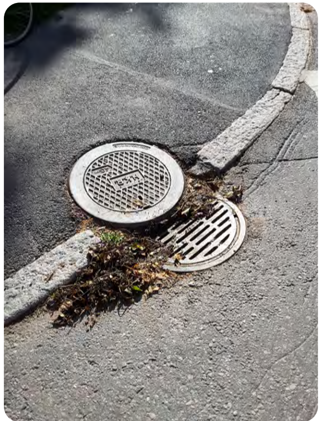
Kuva 46. "Limputettuja" sadevesikaivoja Susitiellä.
