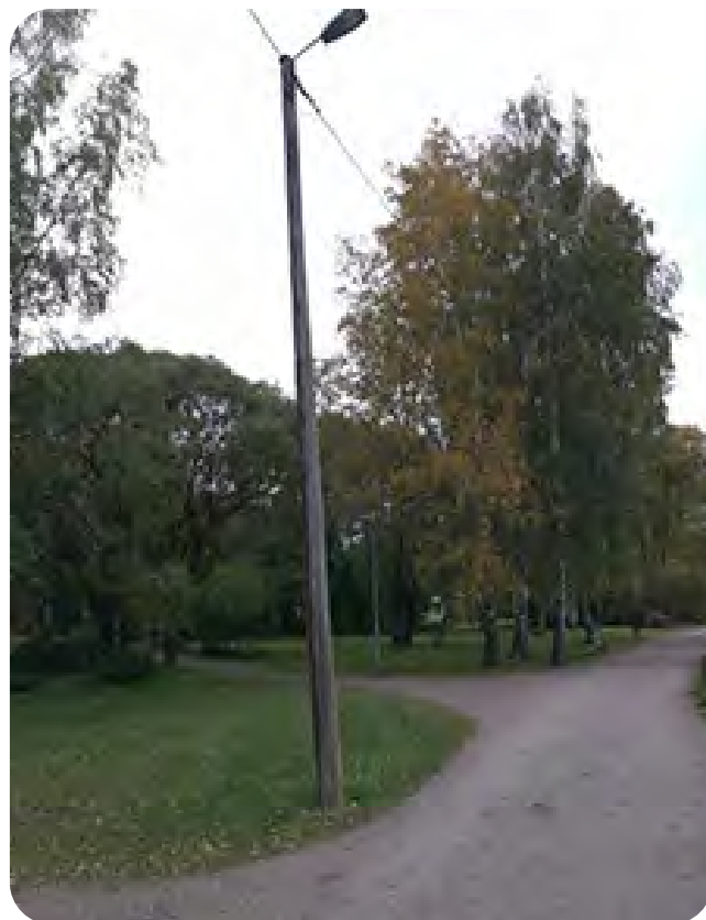
Kuva 71. Valaistus on uusimisen tarpeessa.
