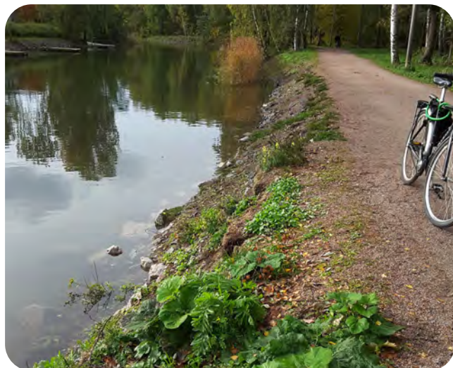
Kuva 70. Nykyisessä luiskassa ei ole suojausta.
