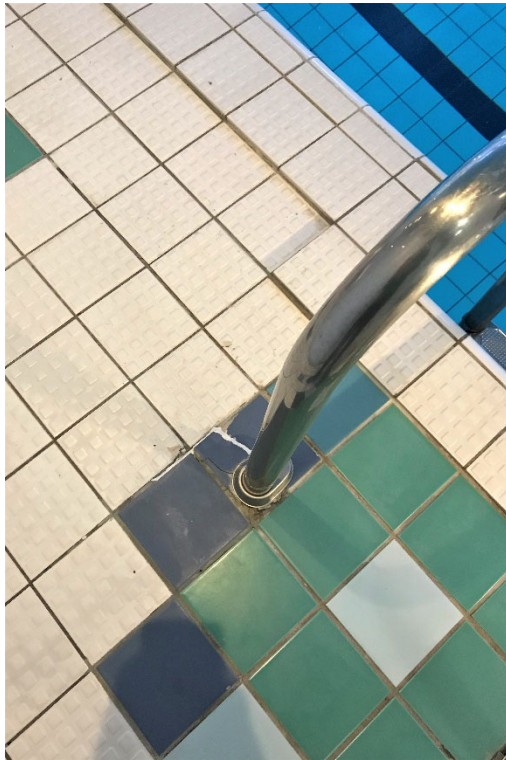
Kuva 15. Rikkinäistä ja kulunutta pintaa allastiloissa. LK.
