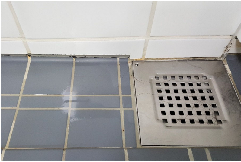
Kuva 22. Likainen lattiakaivo, jonka kansi kiinnitetty ruuveilla. SF.
