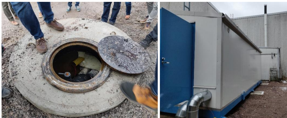
Kuva 8. Espoon Koskelon 1,3 km keskisyvä geotermisen energiakaivo ja lämpöpumppulaitos. Kuva: Sweco Talotekniikka Oy.
