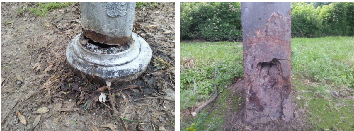
Kuva 29. Koiranvirtsan aiheuttama korroosio valaisinpylväissä Kallion Pengerpuistossa. Kuva 30. Lauttasaaren Isokaaressa koiranvirtsan tuhoama pylväs. Kuvat Hermann Ijäs 2018.
