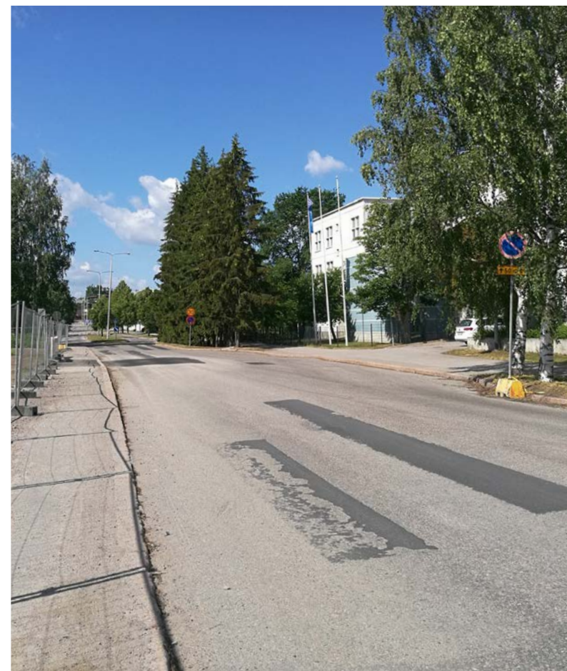
Kuva 32. Vilppulantiellä jalankulku on toissijaisessa asemassa autoiluun nähden. Jalankululle ja pyöräilylle varatut alueet ovat kapeita ja päällysteiden kunto on heikko.
