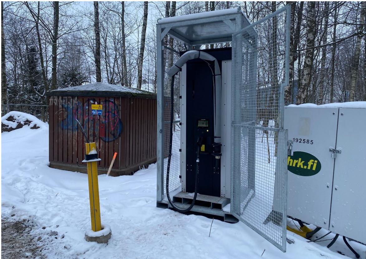
Kuva 3. Riskupuiston työmaalla 18 tonnin kaivinkoneen latauslaite pystytettiin rakentamaan muuntajan viereen. (Kuva: Johanna Nyberg, WSP)
