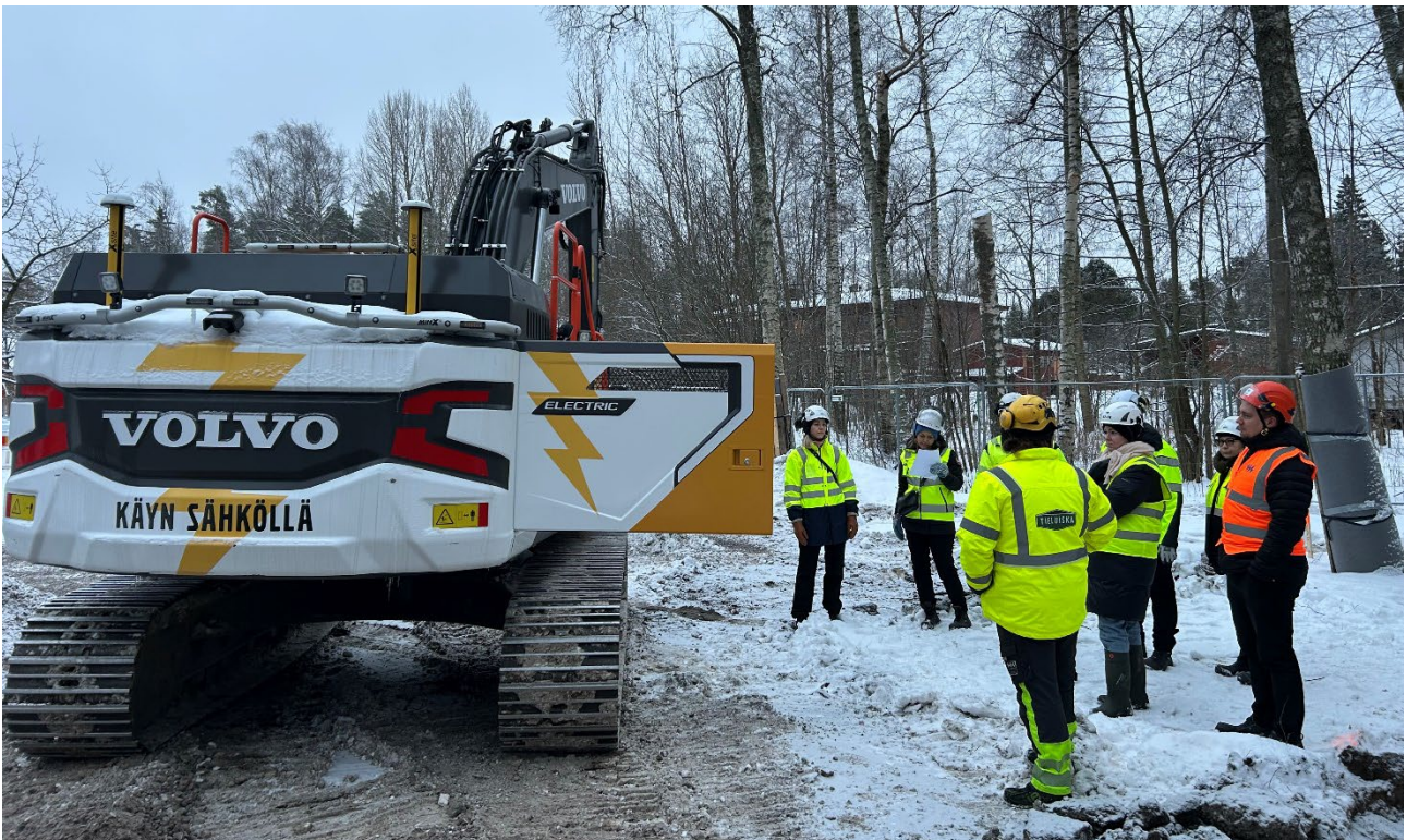
Kuva 1. Työn ohjausryhmän vieraillessa Riskupuiston työmaalla, jossa oli käytössä sähkökäyttöistä kalustoa. (Kuva: Timo Yliniemi, Tieluiska Oy)
