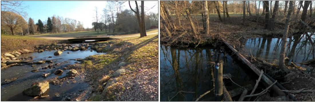
Kuva 14. Talin golfkentän kastelualtaan pato poistettiin vuonna 2013 ja korvattiin pohjakynnyksillä (vas.). Mätäjoen uoman poikki kulkevan putken havaittiin maastokäynnillä huhtikuussa 2025 keränneen oksia ja roskaa putken ylävirtaan (oik.) (kuvat: Sitowise, 2025).
