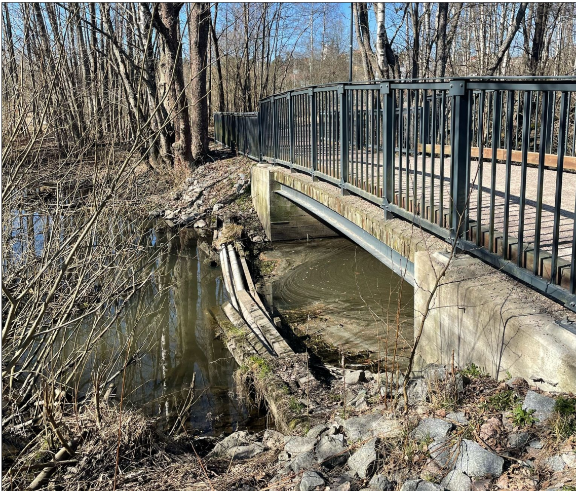
Kuva 33. Maastokäynnillä huhtikuussa 2025 Löydöspuiston kohdalla havaittiin, että sillan vieressä mene- vän putken kotelointi on rikkoutunut ja pudonnut uomaan.
