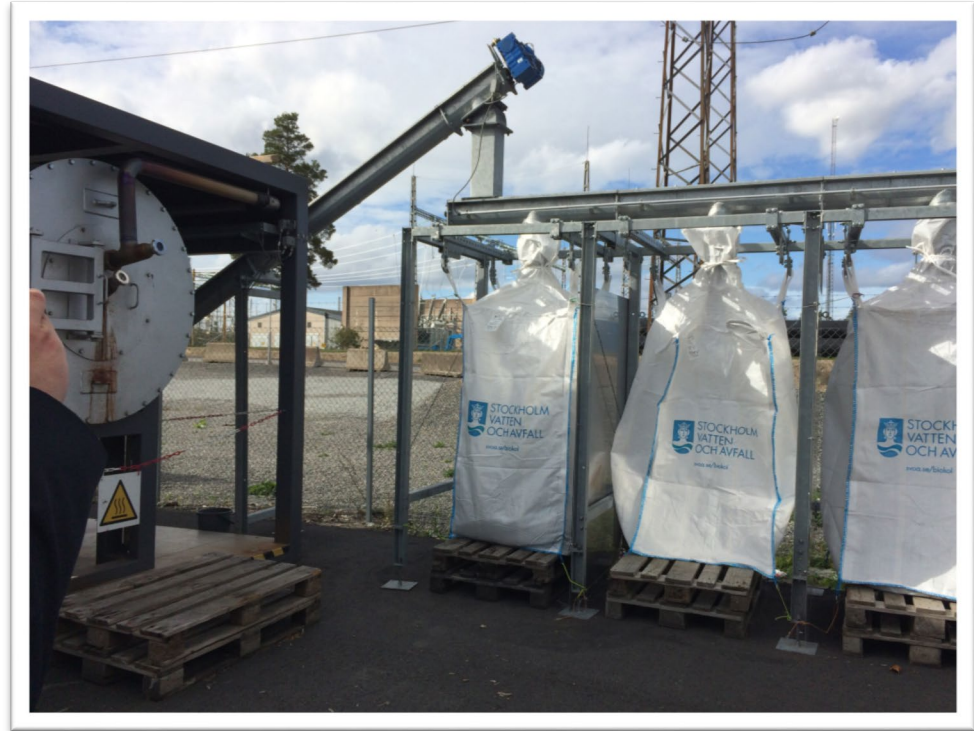
Kuva biohiililaitokselta Tukholmassa.
