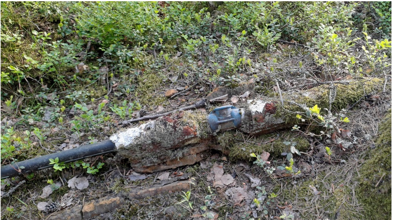
Kuva 3-15. Vesijohtoa ympäröivät solumuovieristeet ovat monin paikoin murentuneet ja putki on maastoutunut aluskasvillisuuden alle.
