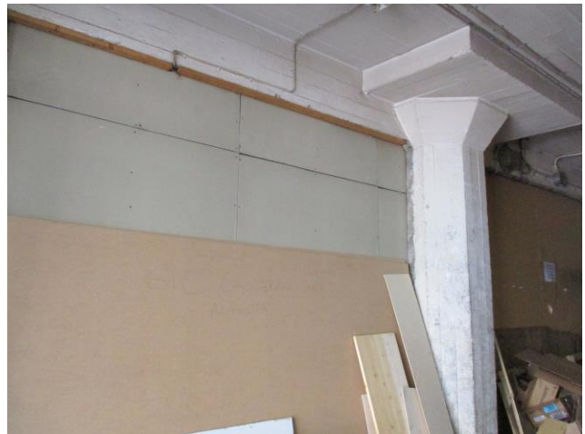
kuva 4. Kuvassa oleva kuitulevy seinässä oli uudempaa ja asbestitonta (ristipääruuvit).
