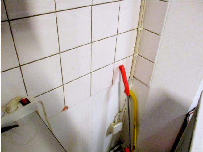
kuva 1. Näyte 4. Pienessä määrässä laatoitusta havaittiin asbestia.
