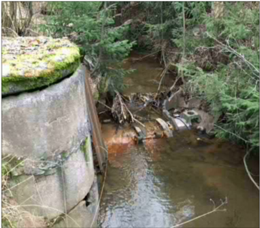
Kuva 14. Käytöstä poistettu vesijohto purku-uomassa.
