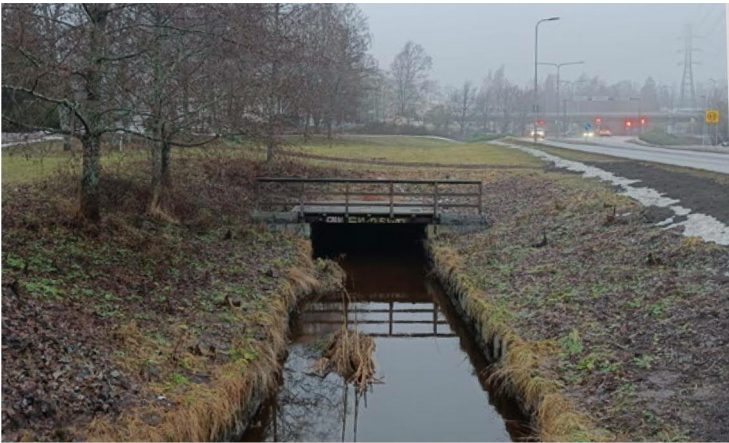
Mellunkylänpuron purkukohta Länsimäentien alituksen eteläpuolella
