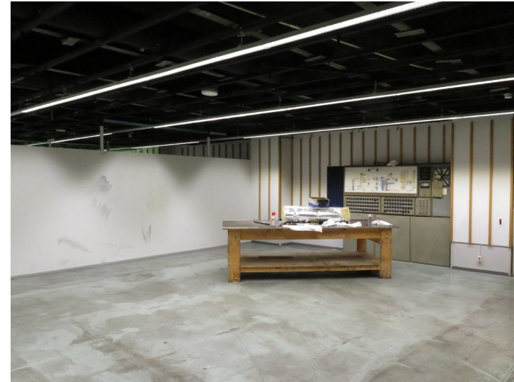
Alkuperäinen valvomotila on nykyisin pääosin tyjillään, vailla käyttöä, mutta muutamia ohjaustauluja (mm. ilmanvaihtoa koskein) on reliikkeinä jäljellä.
