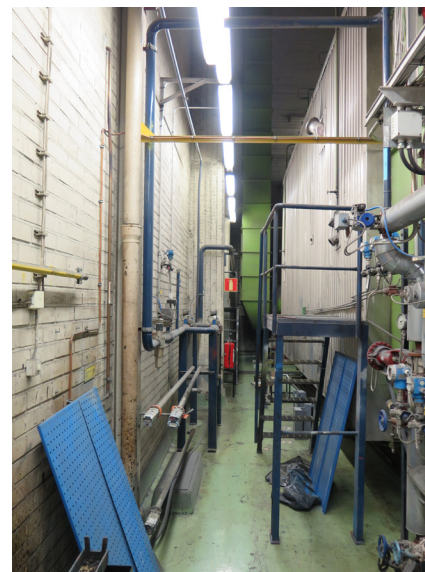
Päätasolla sijaitsee omassa umpinaisessa ja ahtaassa tilassaan Wärtsilän valmistama apukattila öljypolttimeen.
