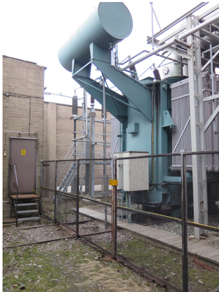
Muuntajatila (aidattu ulkotila).
