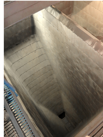
Tyhjä n. 40 metriä korkea suippeneva silo, jonka pohjalla hiilimylly.
