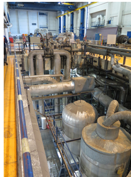
Välipohja-aukko ja kaukolämpökeskuksen putkistoja.
