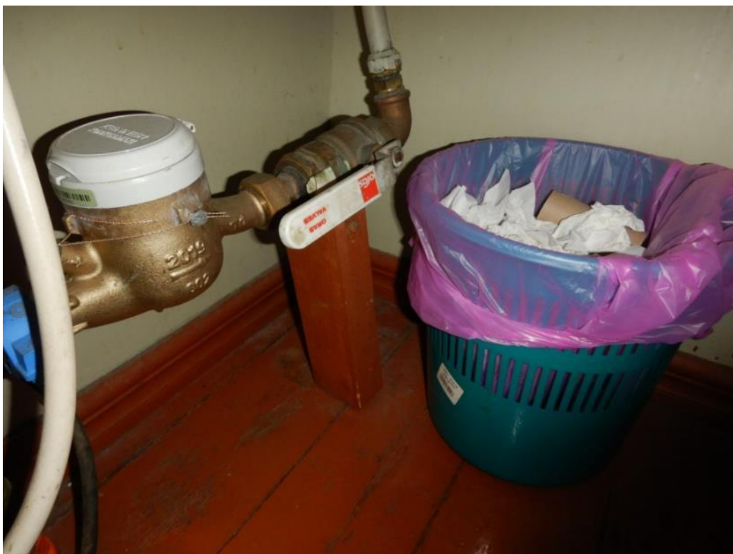
Kuva 68. Vesimittari on tuettu puupalikalla.
