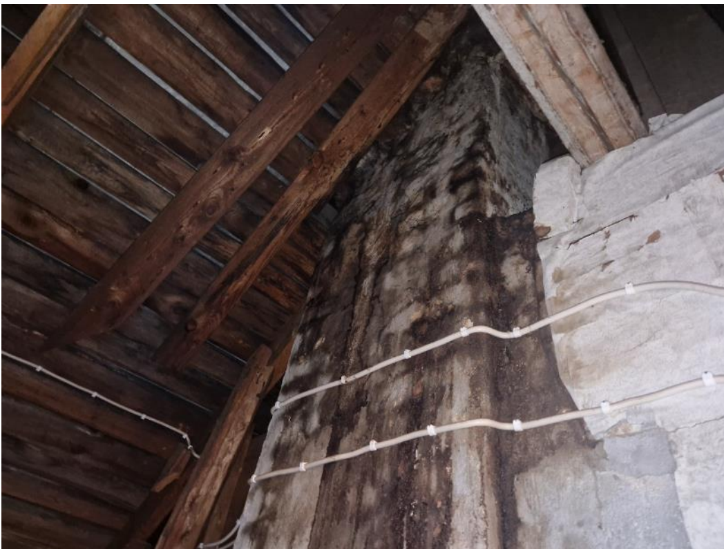
Kuva 48. Ullakkotilaa 2. kerroksen huonetilojen keskellä, hormissa havaittiin runsaasti kosteusjälkiä.
