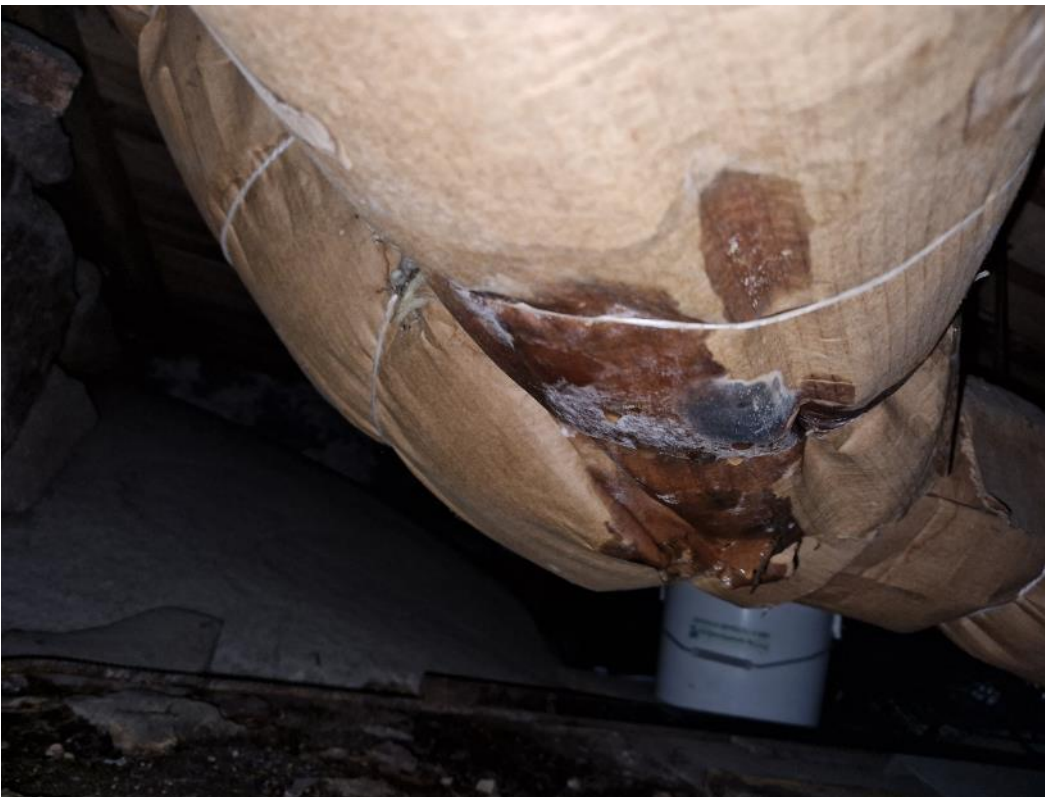
Kuva 34. Ryömintätilassa pesuhuoneen läheisyydessä havaittiin viemäriputken ympärillä olevassa paperissa kosteusjälkiä ja kosteutta.
