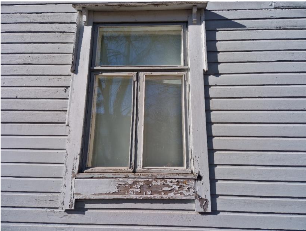
Kuva 35. Ikkunat ovat 2-kertaisia puuikkunoita. Ulkopuoliset maalipinnat ja kittilistat ovat kuluneet ja lohkeilleet.
