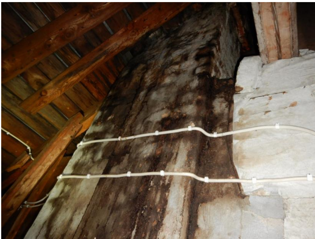
Kuva 75. Hormien kunto on suositeltavaa selvittää tarkemmin mahdollisia kunnostuksia varten.
