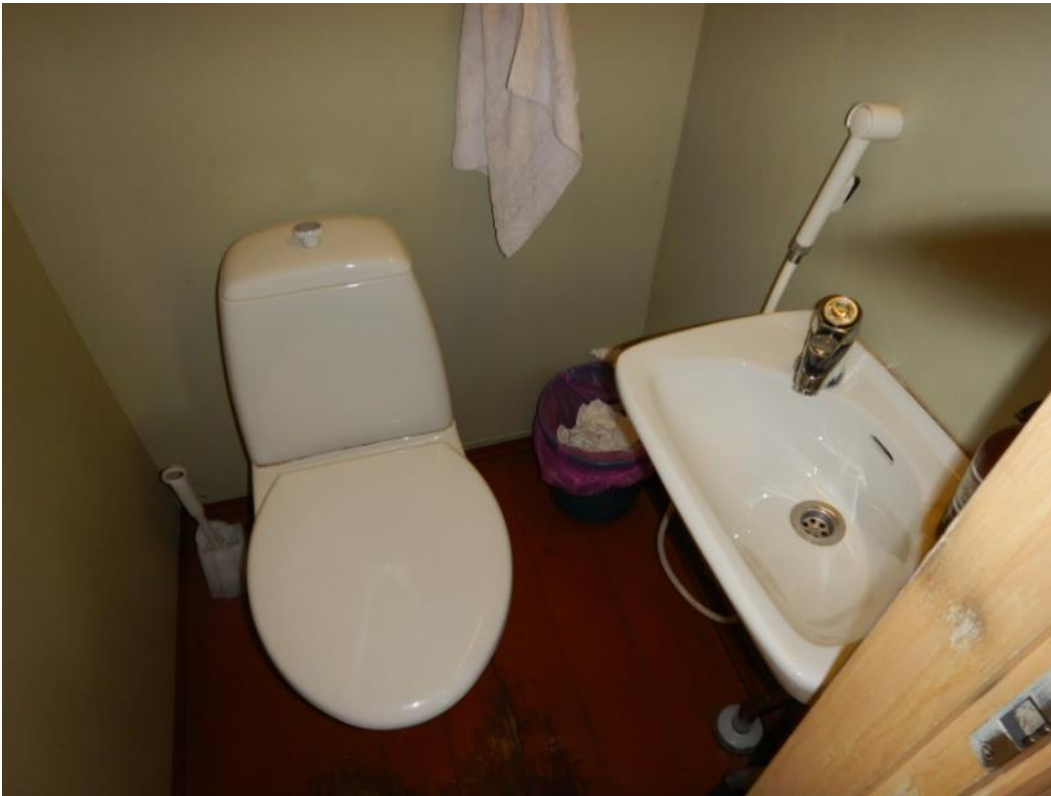
Kuva 73. Yleiskuva vesi- ja viemärikalusteista.
