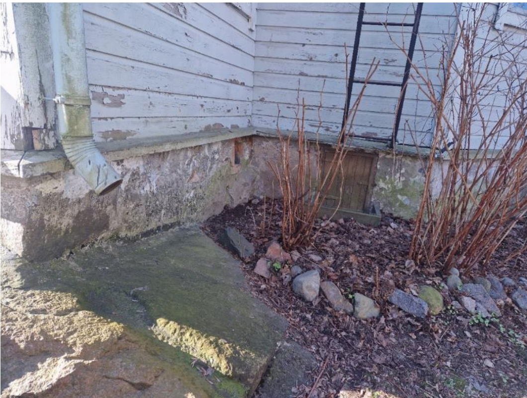
Kuva 10. Rakennuksen vierustaa sisäänkäynnin vieressä. Rakennuksen vierustalla on pensas, sokkelipinta on kulunut ja julkisivuverhouksen vaakalista osin irronnut.
