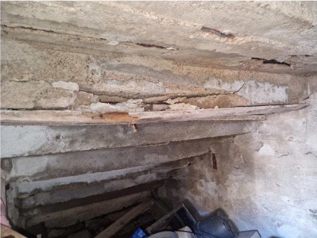
Kuva 18. Rakennuksen portaissa havaittiin lohkeamia alapuolelta tarkastettuna.
