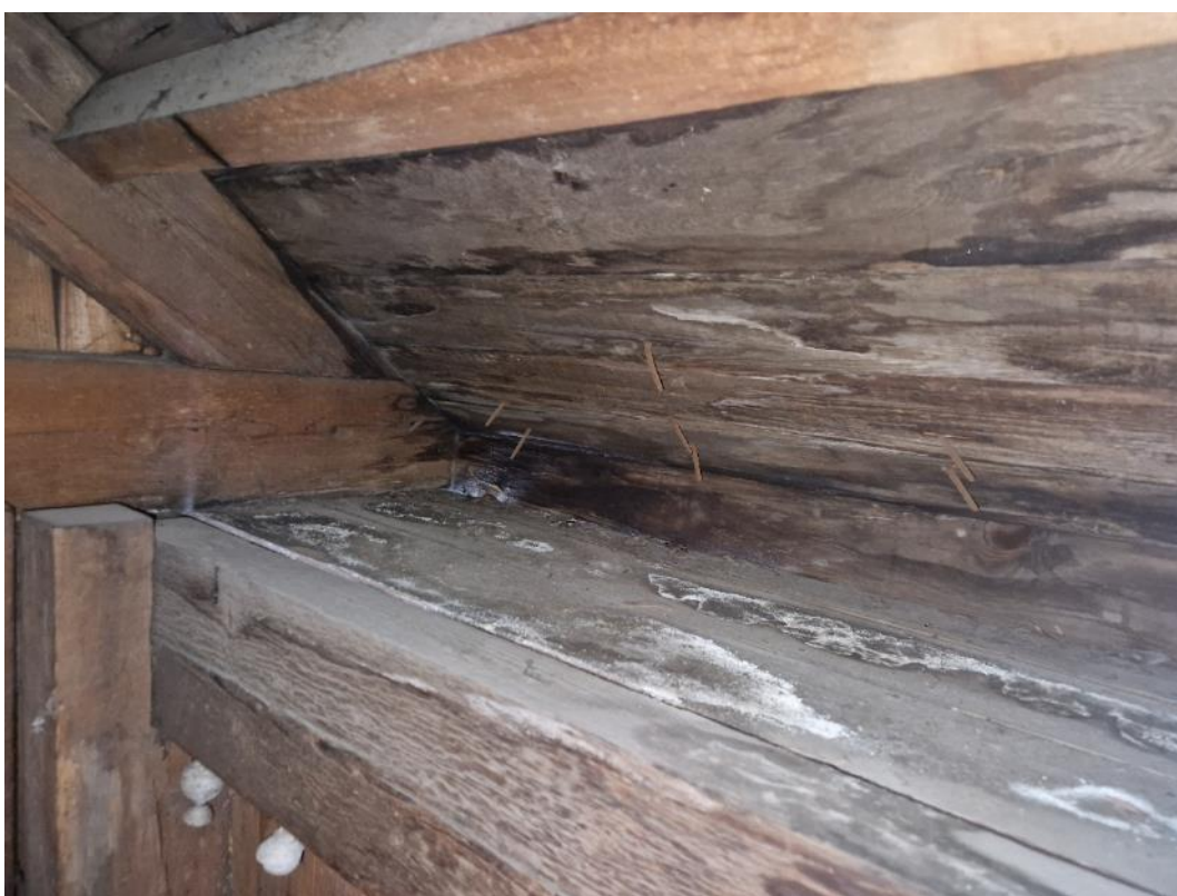
Kuva 46. Sivu-ullakkotilaa yläkertaan johtavien portaiden oikealla puolella, räystäällä havaittiin kosteusjälkiä.
