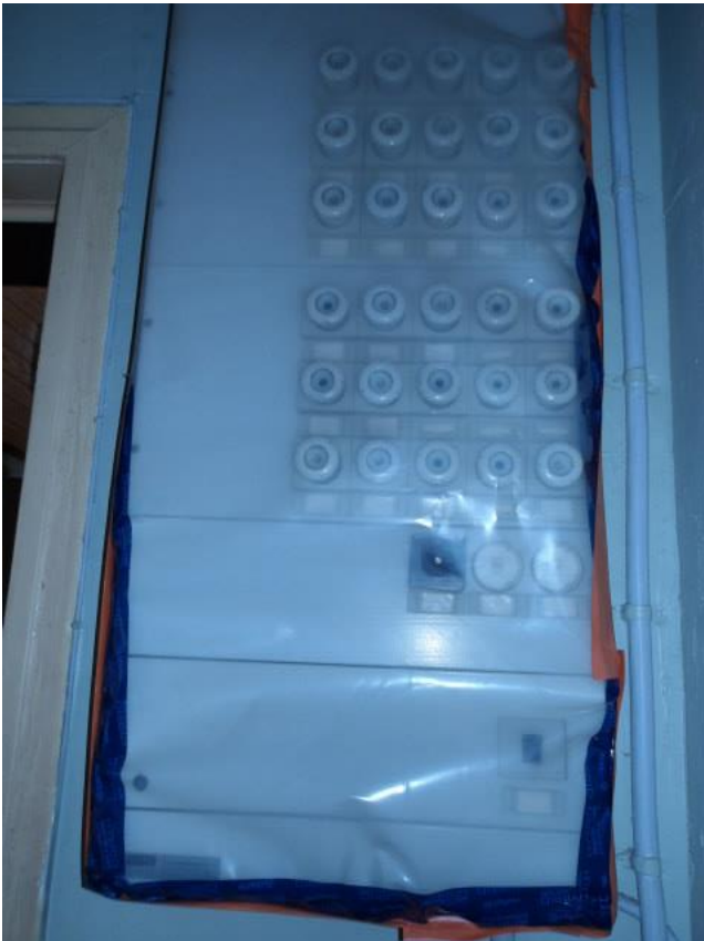
Kuva 80. Yleiskuva remonttialueella olevasta ryhmäkeskuksesta.
