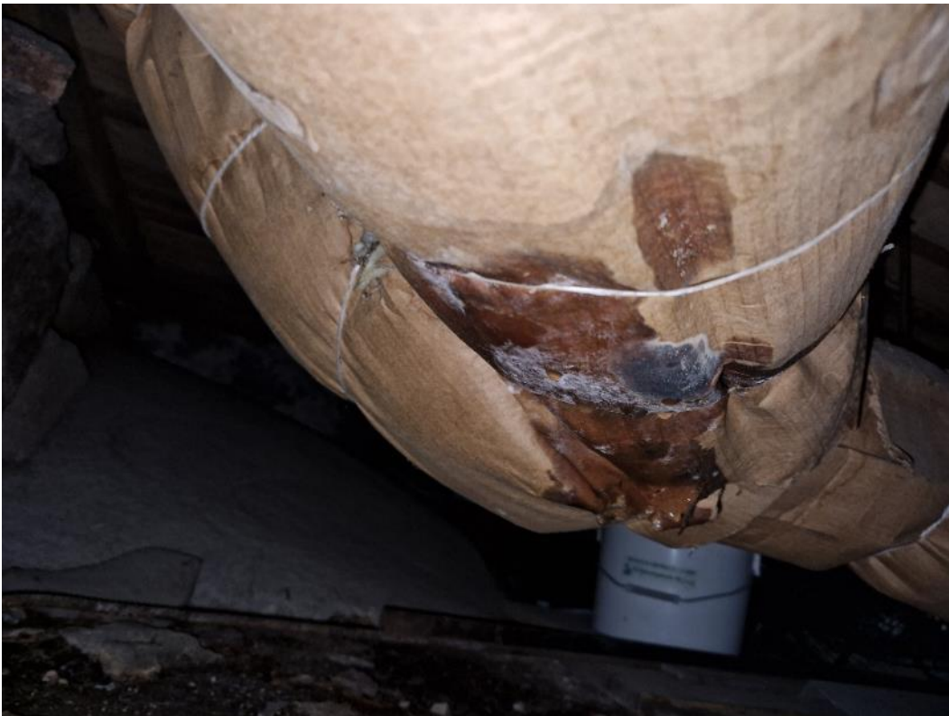
Kuva 70. Viemäriputkessa havaittiin vuotojälkeä.
