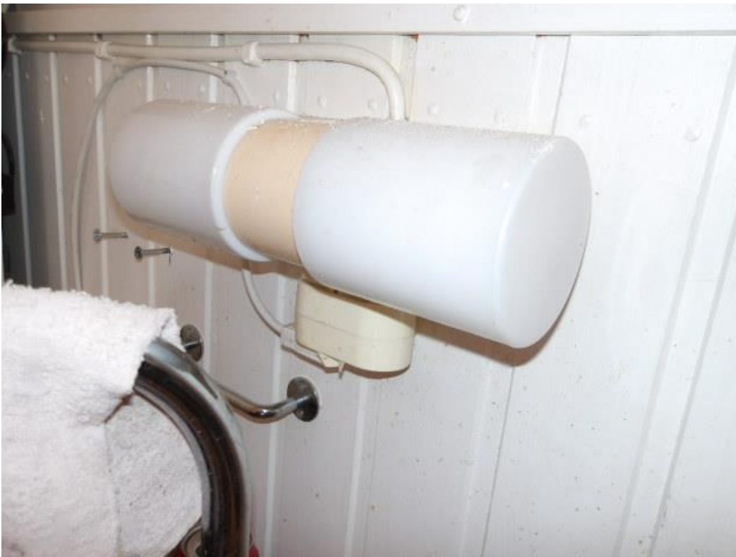
Kuva 86. Yleiskuva märkätilan valaisimesta.
