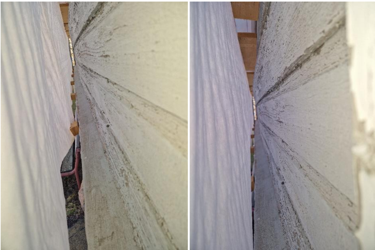
Kuva 7. Ulkoseinän alaosa rakennuksen luoteissivulla. Puuverhouksessa on havaittavissa pientä pullistumaa ulospäin.
