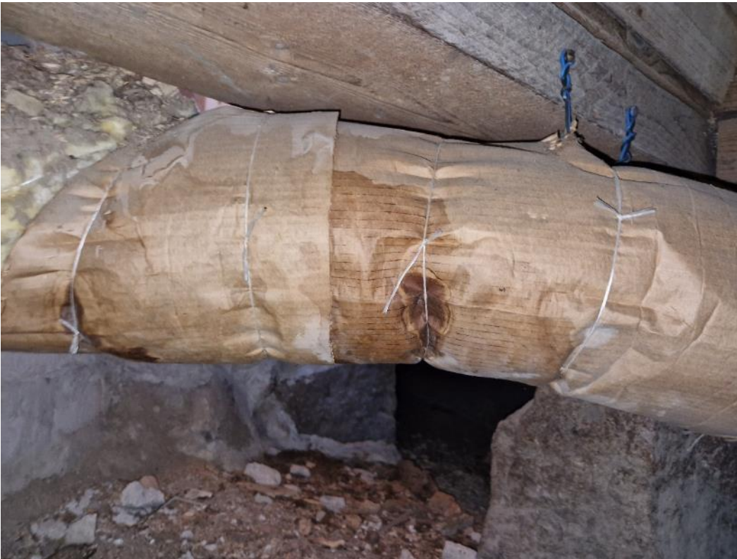
Kuva 33. Ryömintätilassa pesuhuoneen läheisyydessä havaittiin viemäriputken ympärillä olevassa paperissa kosteusjälkiä.
