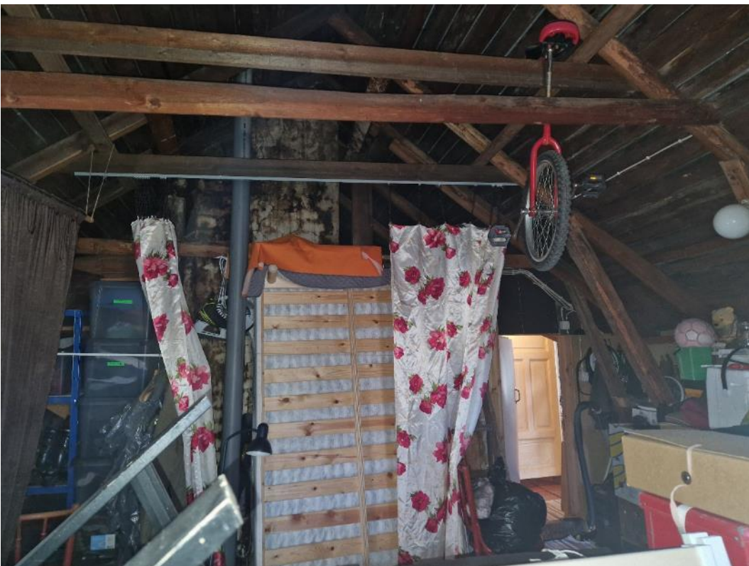
Kuva 52. Ullakkotilaa yläkertaan johtavien portaiden vasemmalla puolella, viemärin tuuletusputki on eristämätön ja hormissa havaittiin runsaasti kosteusjälkiä.
