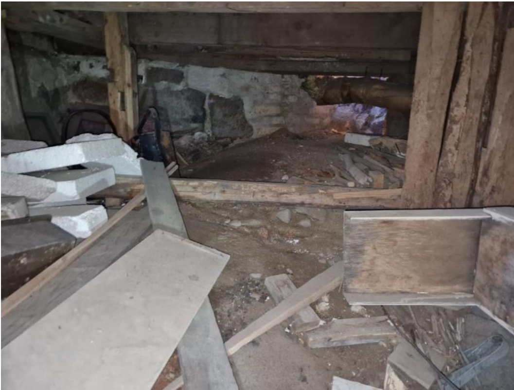
Kuva 21. Ryömintätilaa. Maapohjan päällä on ylimääräistä tavaraa.
