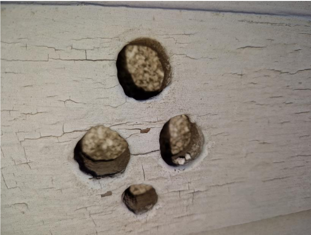
Kuva 9. Talotikkaiden kohdalla julkisivun puuverhouksessa havaittiin reikiä, joiden kautta havaittiin puuverhouksen takana olevan EPS-eriste.
