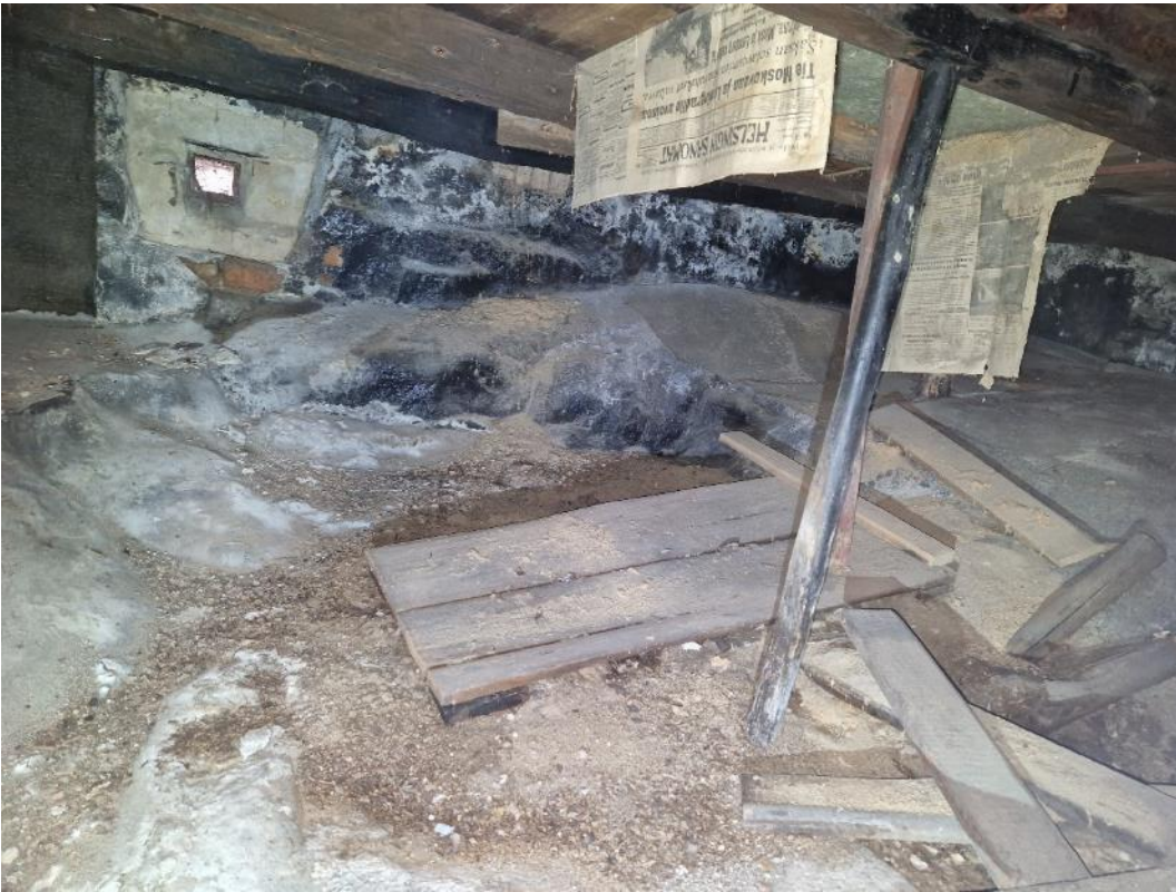
Kuva 27. Ryömintätilaa koillispäädyssä. Alapohjan alapuolinen laudoitus puuttuu osin ja villaeriste on näkyvissä.
