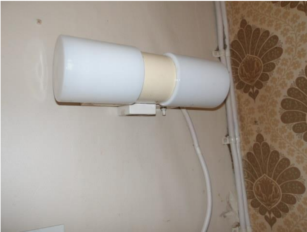
Kuva 85. Yleiskuva keittiön työpistevalaisimesta.
