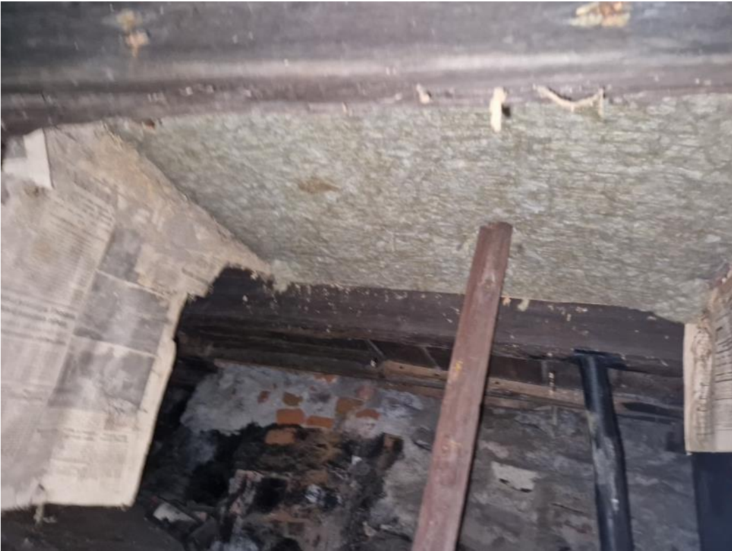
Kuva 28. Ryömintätilaa koillispäädyssä. Alapohjan alapuolinen laudoitus puuttuu osin ja villaeriste on näkyvissä.
