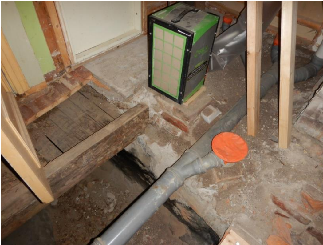
Kuva 71. Yleiskuva viemäreistä puretussa kylpyhuonetilassa.
