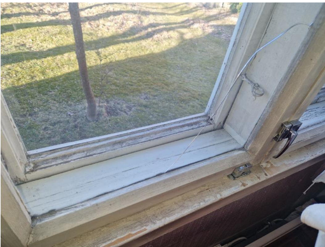
Kuva 36. Ikkunoiden osalla on kunnostustarvetta. Ikkunan sisälasissa on halkeama. Kuva on 1. kerroksesta.
