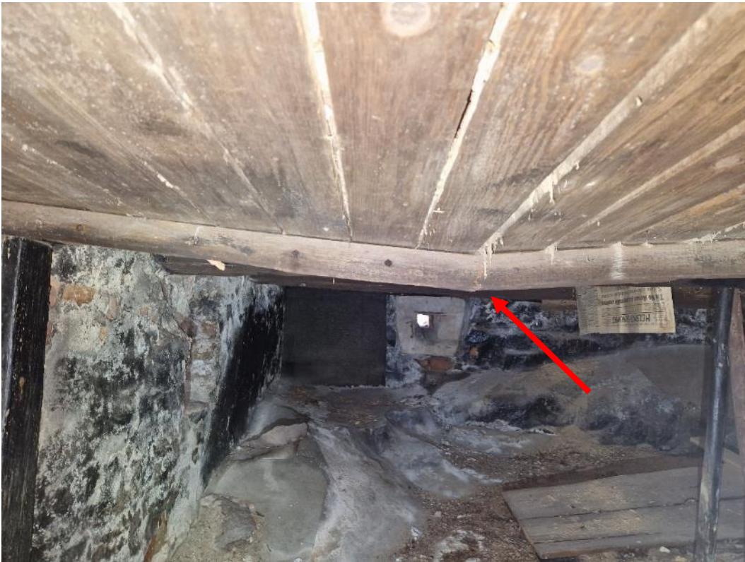
Kuva 25. Ryömintätilaa koillispäädyssä. Alapohjarakenne on painunut ja vaakasuuntainen tukipuu murtunut.
