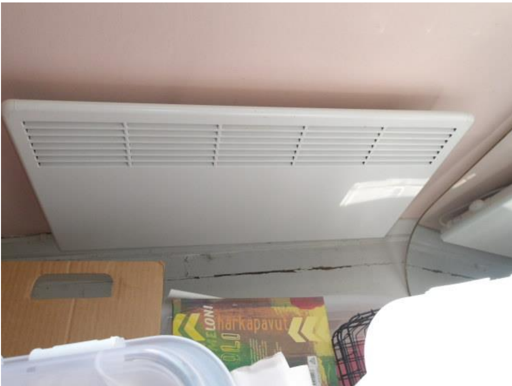
Kuva 88. Yleiskuva sähköisestä tasolämmittimestä.
