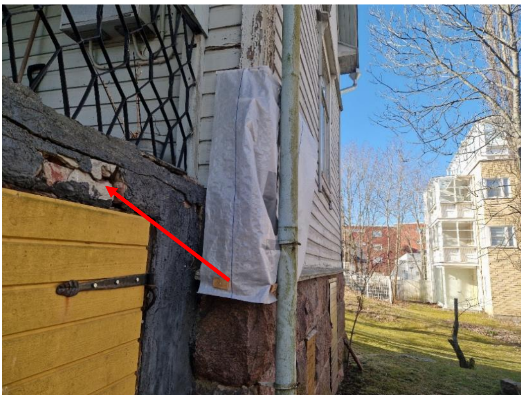
Kuva 16. Rakennuksen porrastasanteen pinnoite on lohkeillut ja reunassa havaittiin murtumaa.
