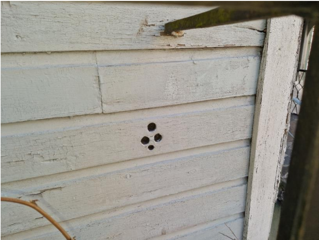
Kuva 8. Talotikkaiden kohdalla julkisivun puuverhouksessa havaittiin reikiä, joiden kautta havaittiin puuverhouksen takana olevan EPS-eriste.
