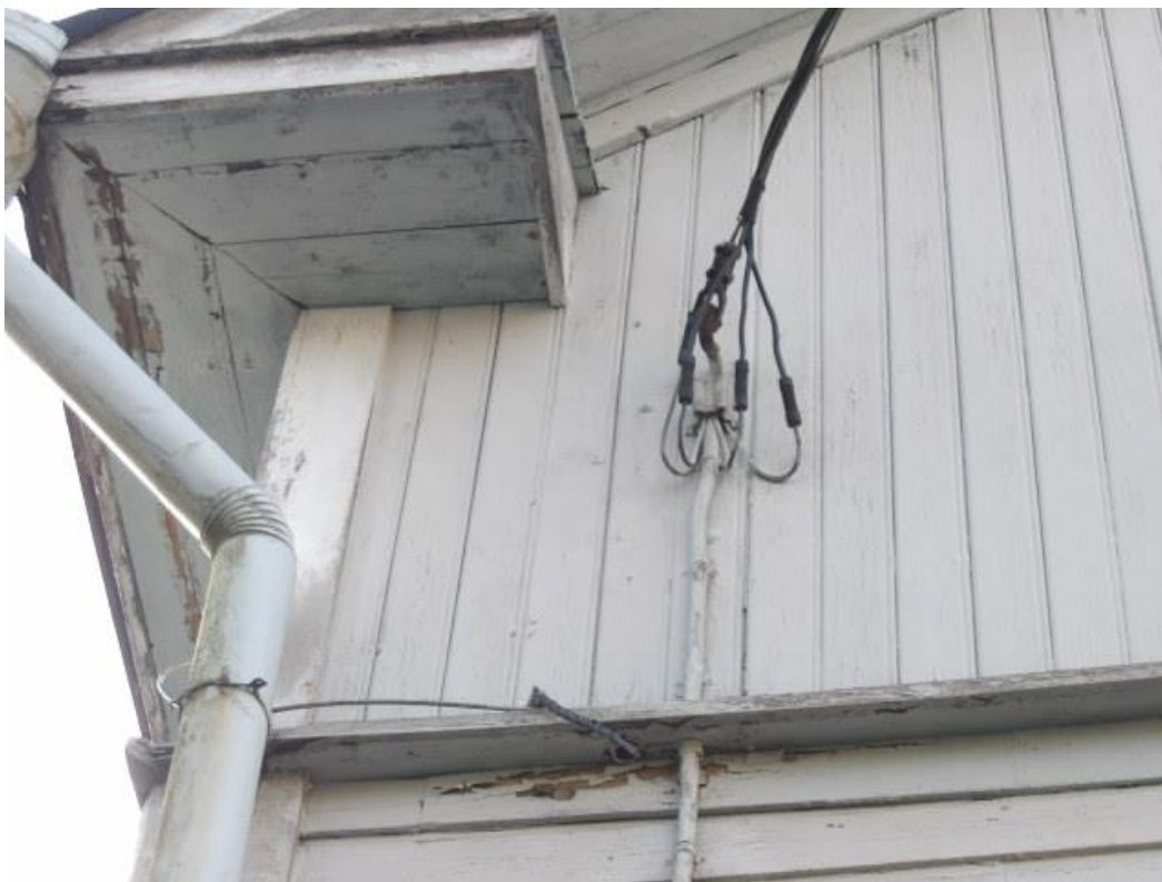
Kuva 81. Yleiskuva sähköliittymän liitäntäpisteestä (listan alla katkaistu puhelinliittymä).
