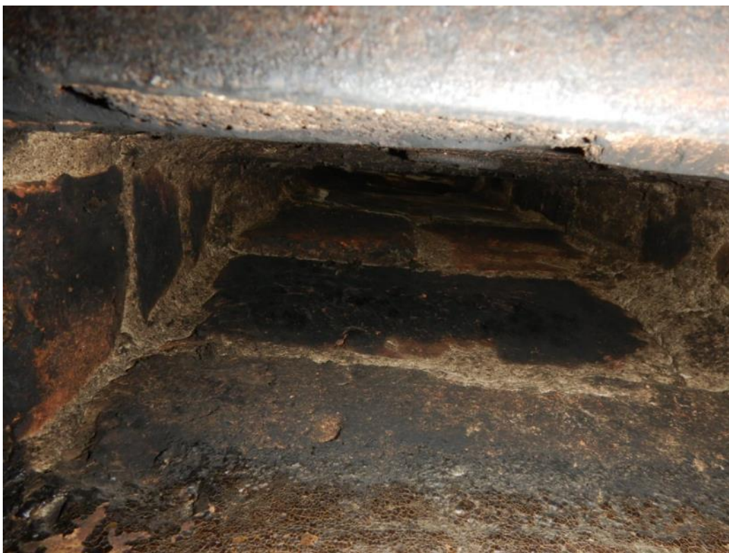
Kuva 76. Hormien kunto on suositeltavaa selvittää tarkemmin mahdollisia kunnostuksia varten.
