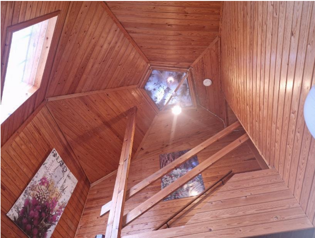
Kuva 59. Portaikko yläkertaan, portaikossa on putoamisen vaara (kaiteiden väli on liian suuri).
