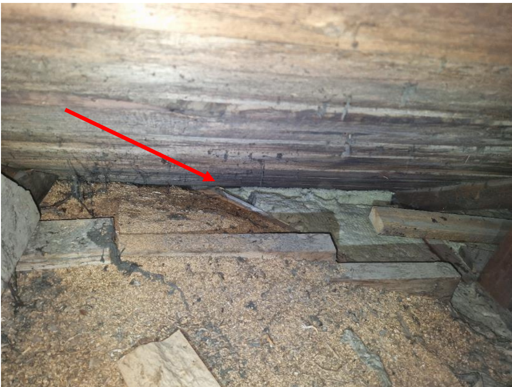
Kuva 56. Vinon osan tuuletusraot ovat osin ummessa.
