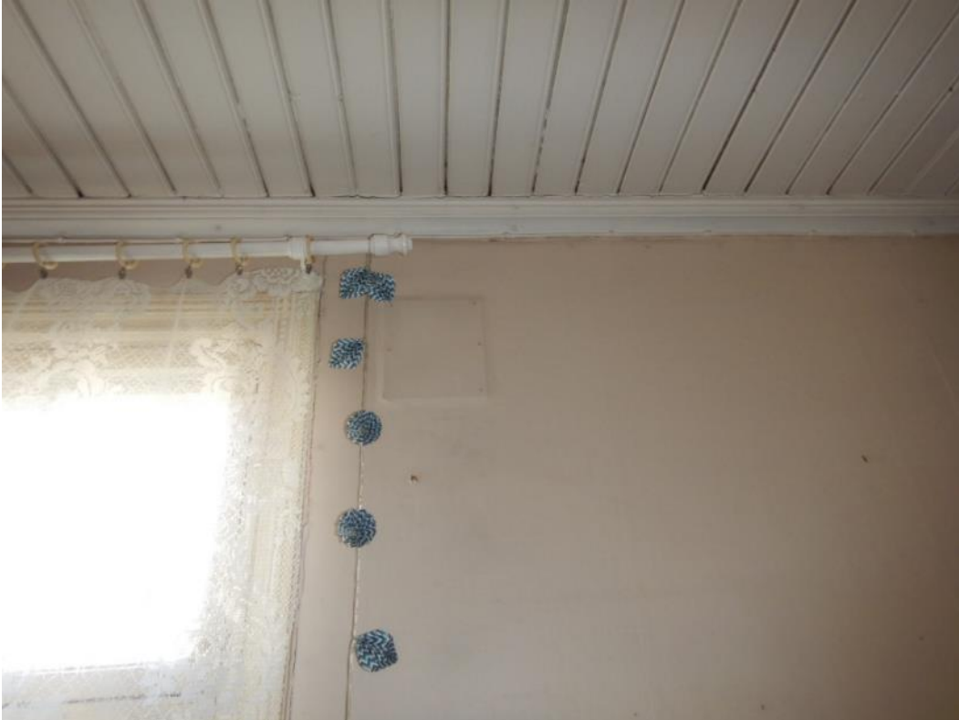
Kuva 72. Korvausilmareitit on tukittu pääasiassa.
