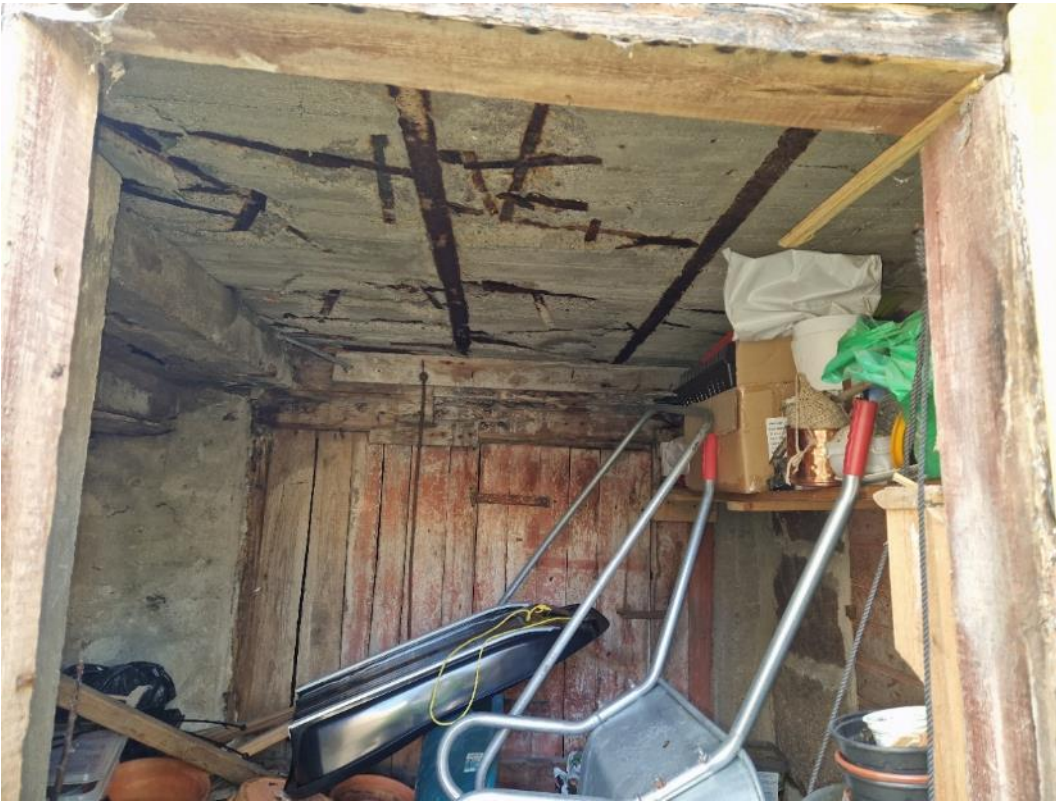
Kuva 17. Rakennuksen porrastasanteen raudoitteet olivat näkyvissä ja ruosteessa alapuolelta tarkastettuna. Portaiden alustilassa olevan luukun kautta on myös kulku ryömintätilaan.
