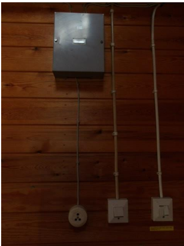
Kuva 82. Yleiskuva puhelinristikytöntäkotelosta ja puhelinpisteestä.
