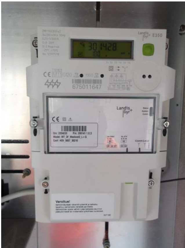
Kuva 79. Yleiskuva uusitusta kWh-mittarista.
