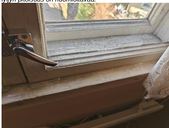
Kuva 15. Ikkunat, sisäpuolen puuosien maalit sisältävät raskasmetalleja.
