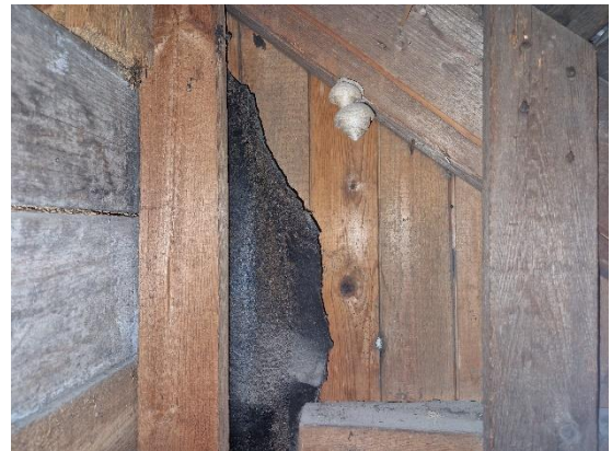
Kuva 6. 2.krs US/VK välissä bitumikermi ei sisällä asbestia, sisältää PAH-yhdisteitä.
