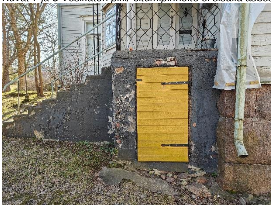
Kuva 9. Ulkoportaan maali ja musta sivele eivät sisällä asbestia, mutta sisältää PAH-yhdisteitä.
