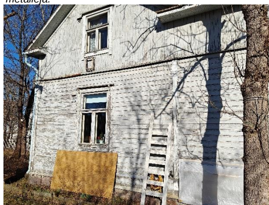
Kuva 16. Ikkunoiden ulkopuolen puuosien ja julkisivujen maalit sisältävät raskasmetalleja, lyijyn pitoisuus korkea.
