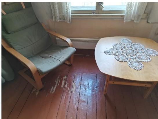
Kuva 13. Lattialankkujen maali sisältää raskasmetalleja, lyijyn pitoisuus on huomioitavaa.
