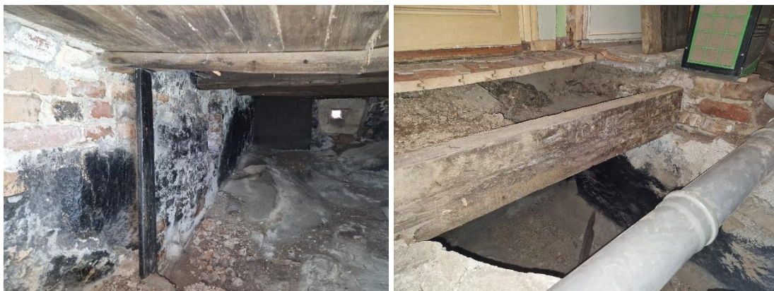
Kuvat 1 ja 2. Perustusten piki-/bitumisively sisältää asbestia sekä PAH-yhdisteitä.
