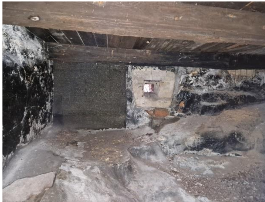
Kuva 11. Alapohjassa kallion päällä oleva bitumikermi ei sisällä asbestia, sisältää hieman PAH-yhdisteitä.
