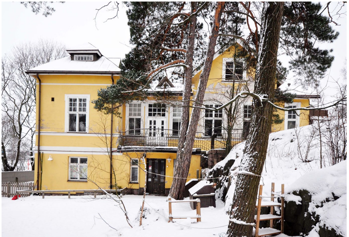
Eteläjulkisivu 2017. Julkisivu on eniten kärsinyt ja rappaus maalipintoineen on paikoin irronnut. Edessä sijaitsee lasten leikkipiha.
