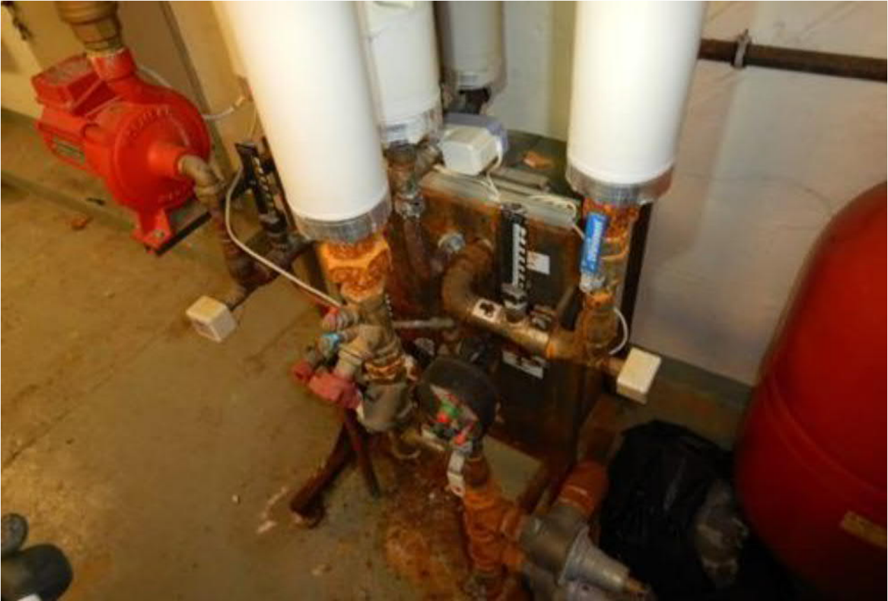
Kuva 59. Yleiskuva kaukolämmön alajakokeskuksen laitteista
