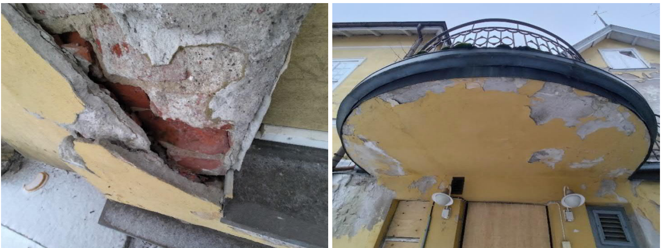
Kuva 11 ja Kuva 12. Julkisivussa havaittiin erityisesti kaakkoisjulkisivulla laajoja vaurioita
