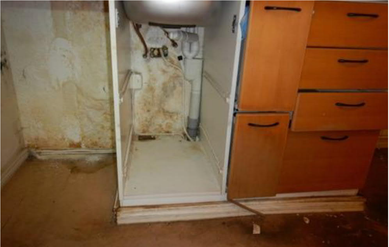
Kuva 75. Vesikalusteet irrotettu vesijohtoverkosta, rakenteissa on kosteusvauriojälkiä.
