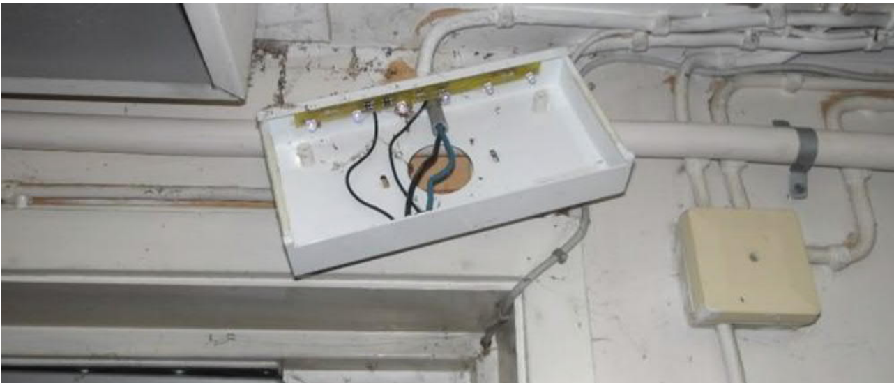
Kuva 85. Poistumistievalaisimet ovat huonokuntoisia.
