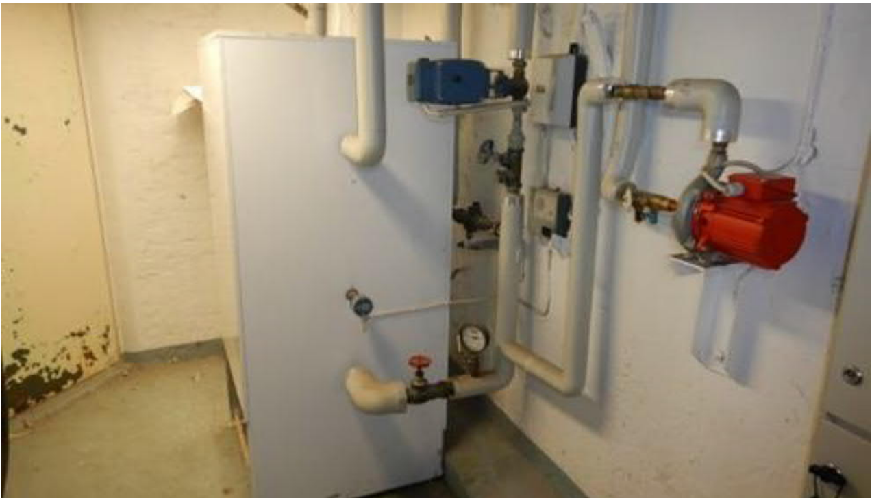
Kuva 60. Yleiskuva lämpimän käyttöveden varaajasta.
