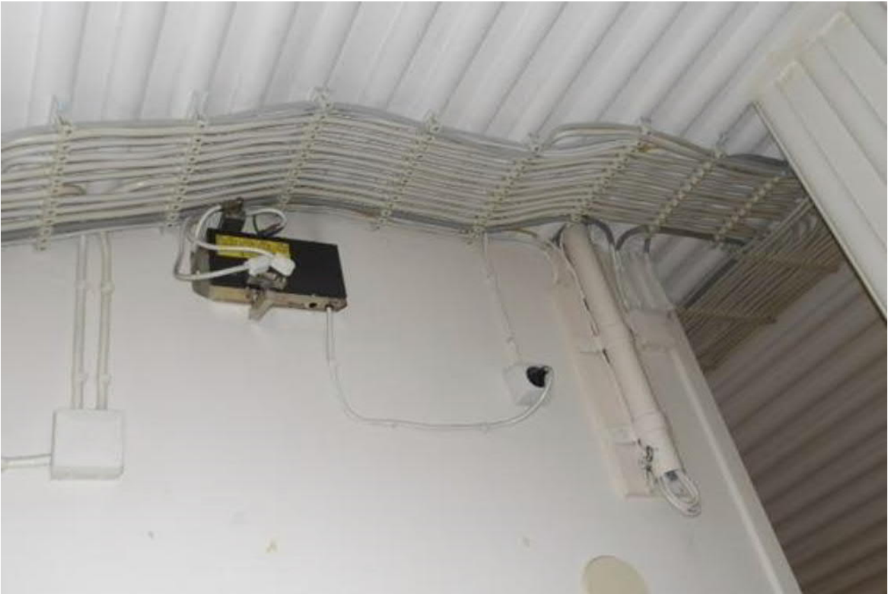
Kuva 80. Yleiskuva pinta-asennuksista ja Niedax-kiskoista.
