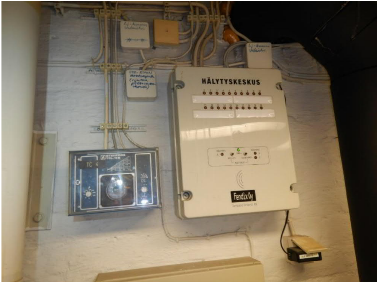
Kuva 90. Yleiskuva lämmönjaon säätö- ja hälytyskeskuksesta.
