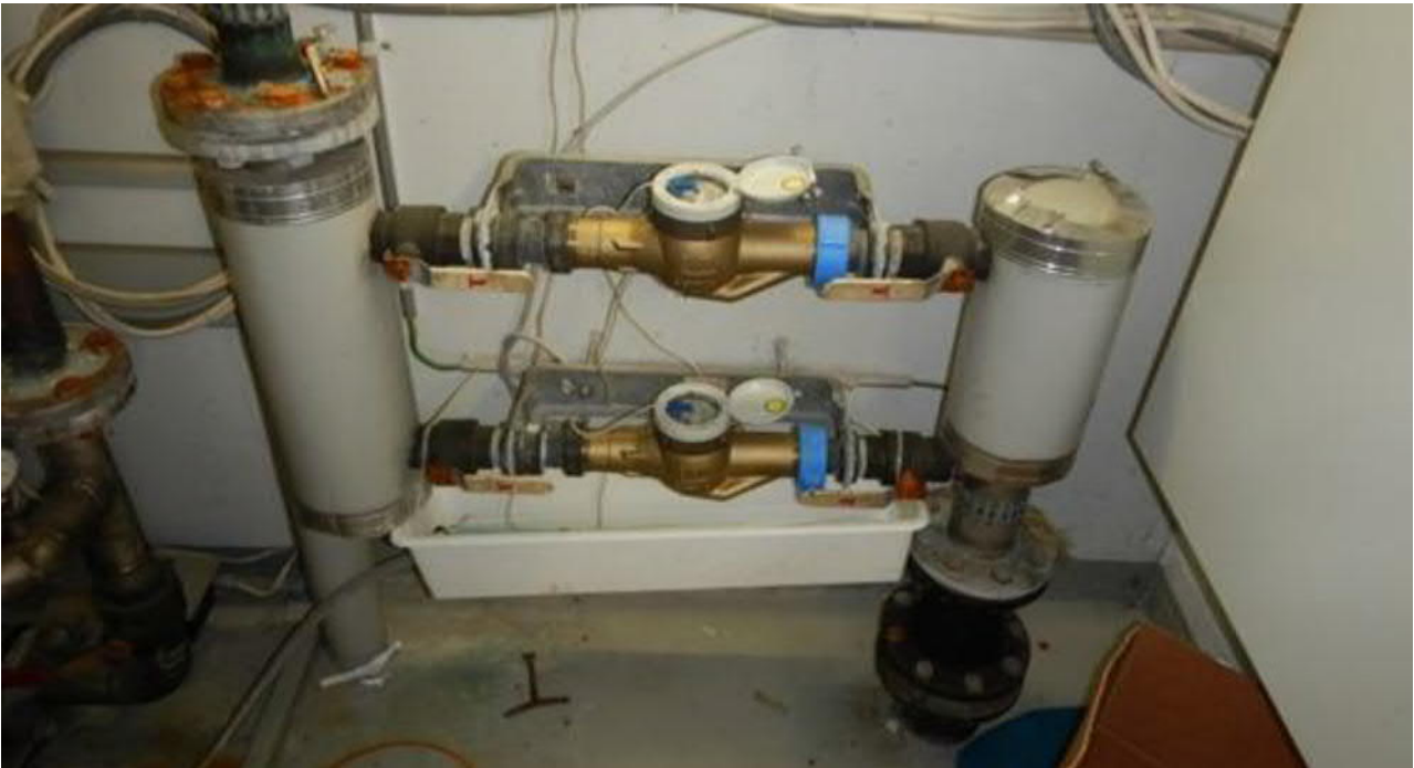
Kuva 65. Yleiskuva vesimittarista ja pääsuluista.
