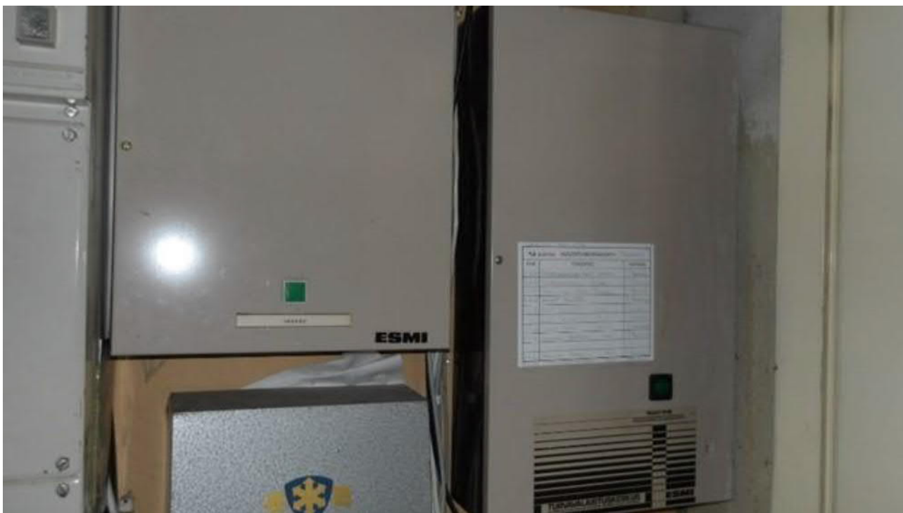
Kuva 89. Yleiskuva merkki- ja turvavalokeskuksesta.
