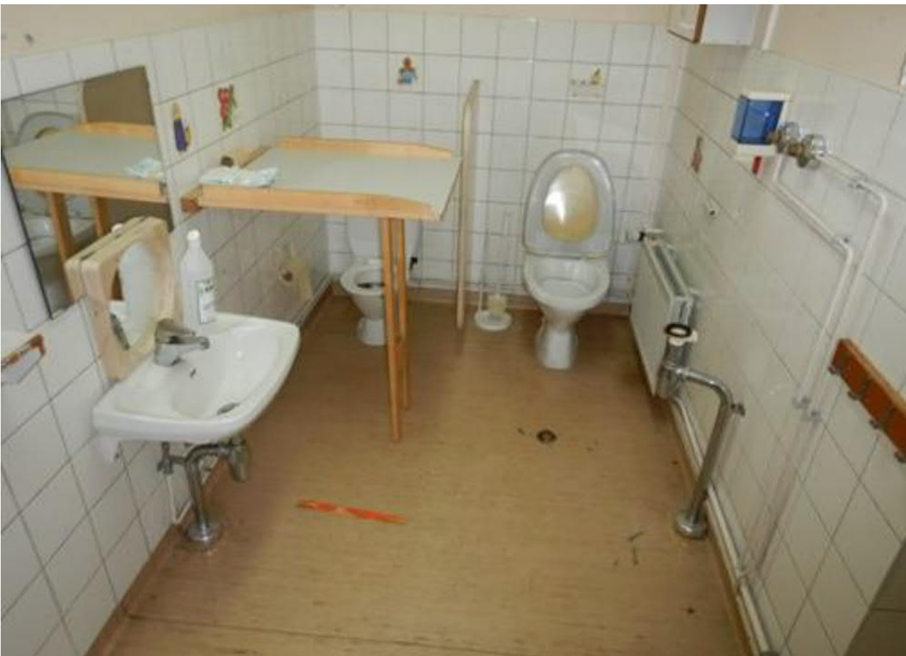
Kuva 66. Yleiskuva vesi- ja viemärikalusteista.
