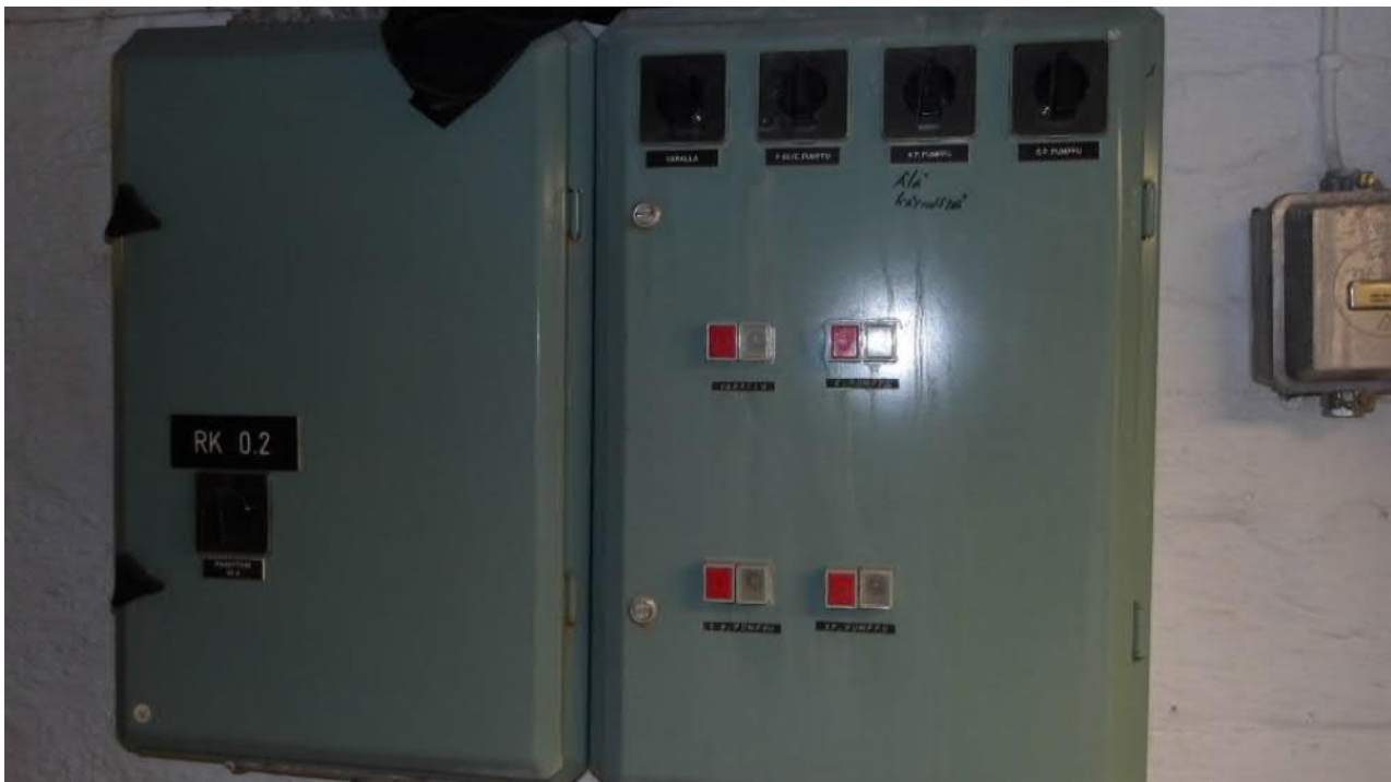
Kuva 79. Yleiskuva lämmönjakohuoneen vanhasta ryhmäkeskuksesta RK 0.2.
