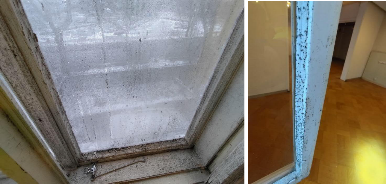
Kuva 29 ja Kuva 30. 1. kerroksen ikkunoissa havaittiin ulkopuitteen lasin pinnassa kondenssivettä ja sekä sisä- että ulkopuitteiden pinnoilla mikrobikasvua.
