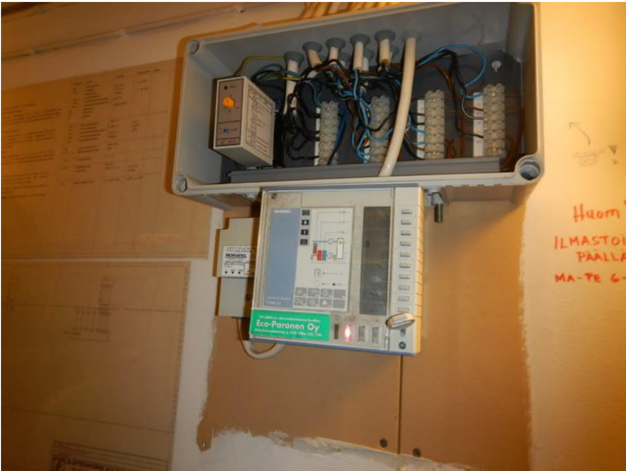
Kuva 91. Yleiskuva tuloilmakoneen säätökeskuksesta.
