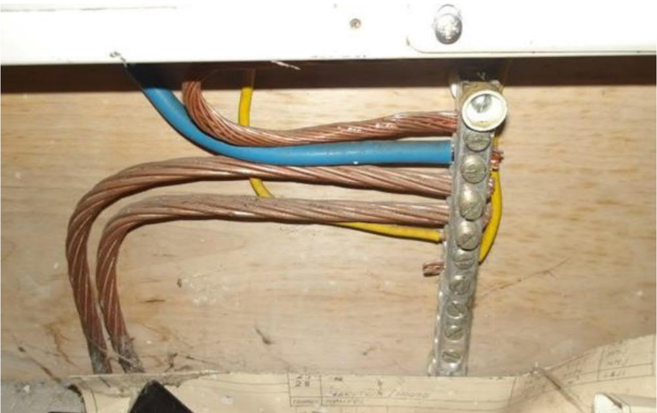
Kuva 81. Yleiskuva potentiaalintasauskiskosta ja johtimista.
