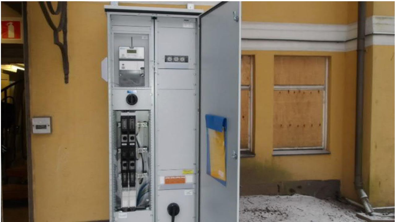
Kuva 78. Yleiskuva uusitusta keskuksesta MK1.
