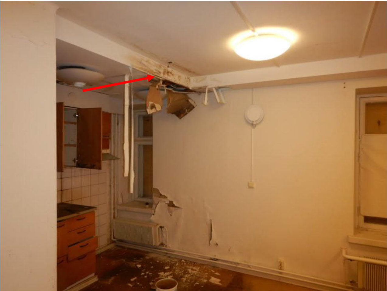
Kuva 61. Yleiskuva lämpöputkien ja pattereiden asennuksista. Katossa olevat vuotojäljet voivat johtua putki- vuodosta.
