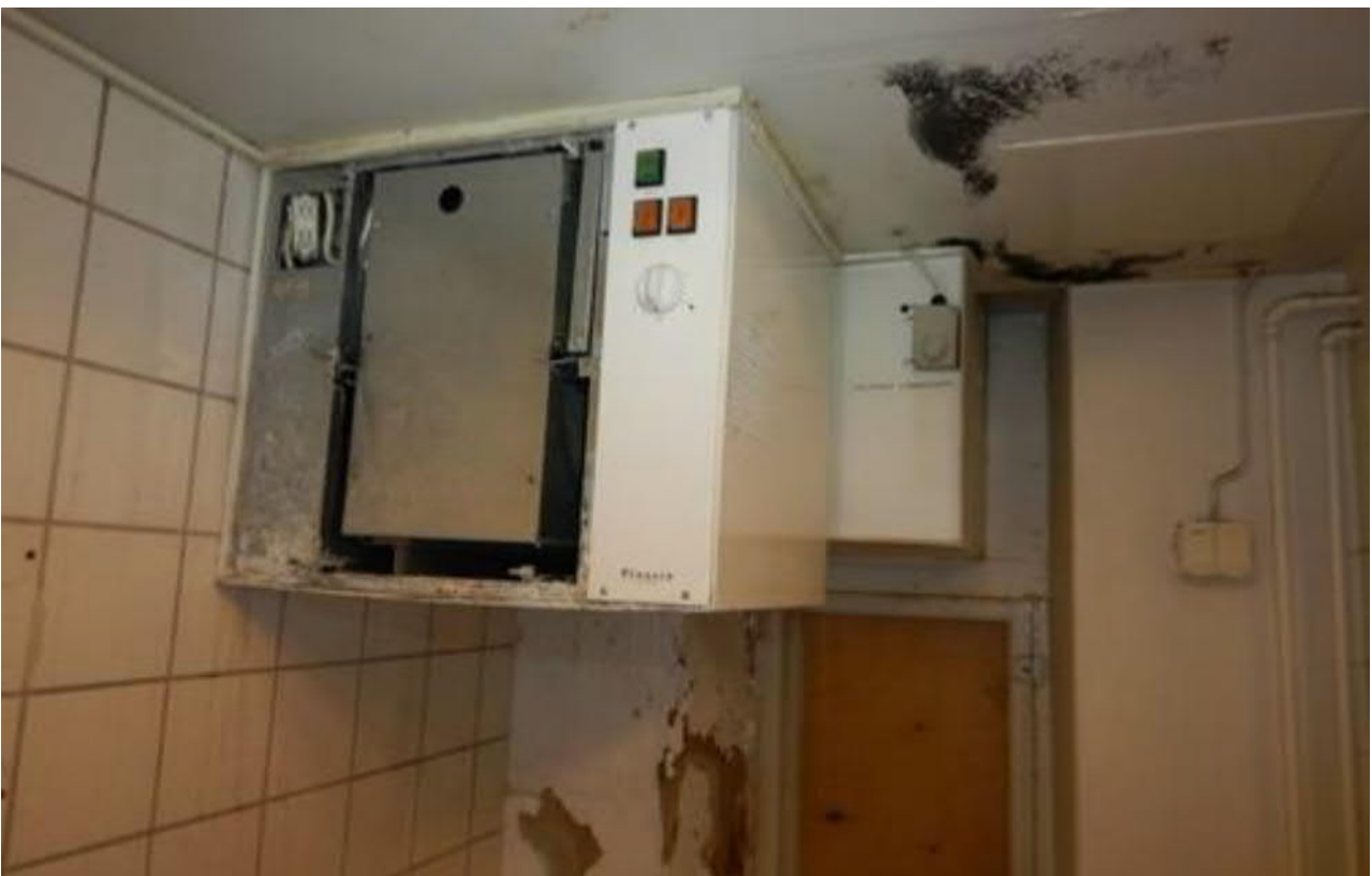
Kuva 68. Yleiskuva pohjakerroksen LTO-koneesta.
