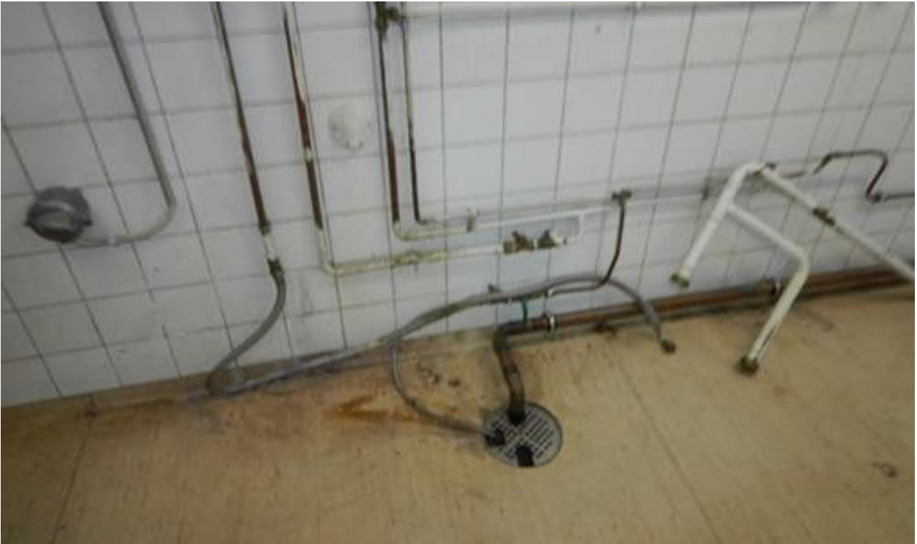
Kuva 67. Käyttövesiputket on tyhjennetty ja ainakin näkyvin osin ja päät osin avoimena.
