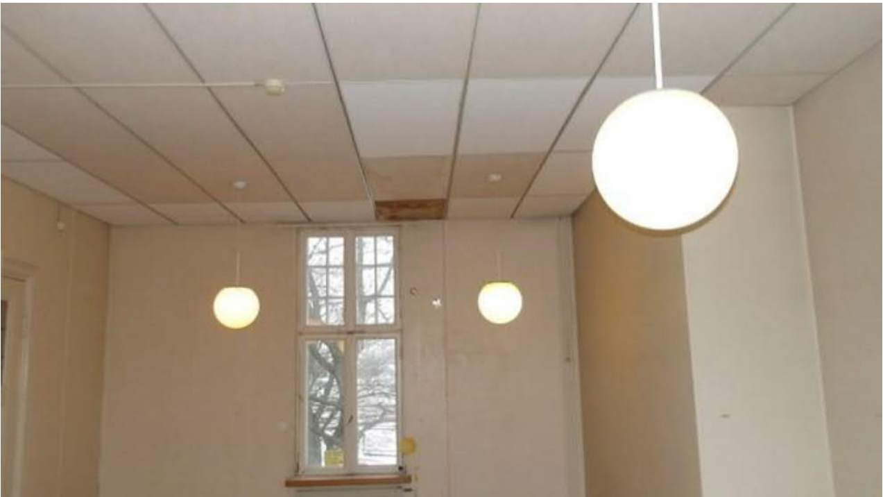
Kuva 83. Yleiskuva ensimmäisen kerroksen huonetilan valaisimista.
