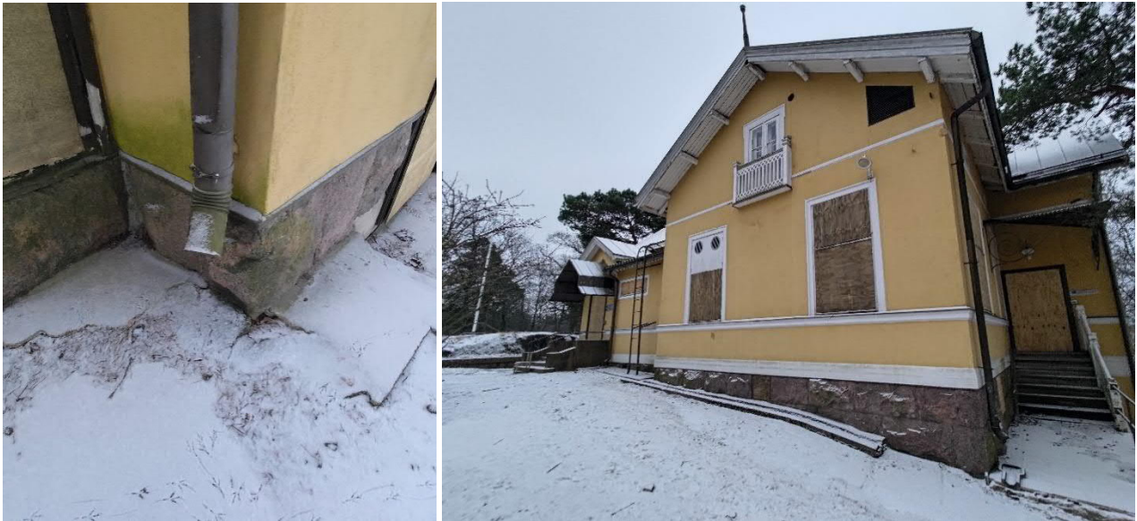
Kuva 10. Osittain sadevedet on ohjattu suoraan maahan (vas.). Syöksytorstista sadevedet on osittain johdettu betonikouruihin. Ikkunoita ja ovia on suojattu vanerilevyillä ilkeivallan ehkäisemiseksi (oik.).
