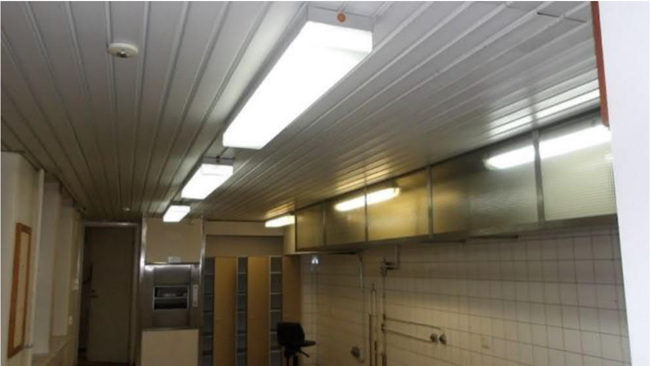
Kuva 82. Yleiskuva keittiötilan valaistuksesta.
