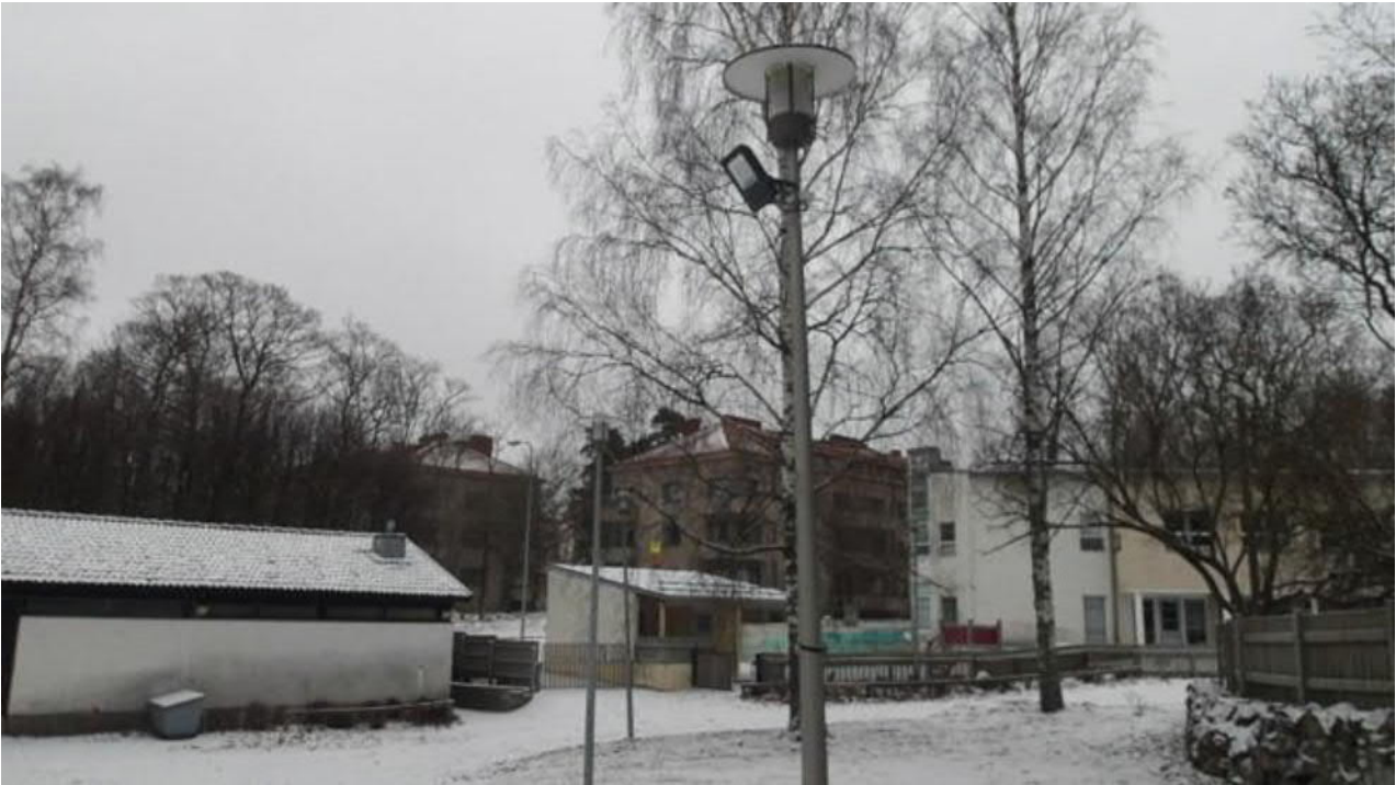
Kuva 76. Yleiskuva piha-alueen pylväsvalaistuksesta.
