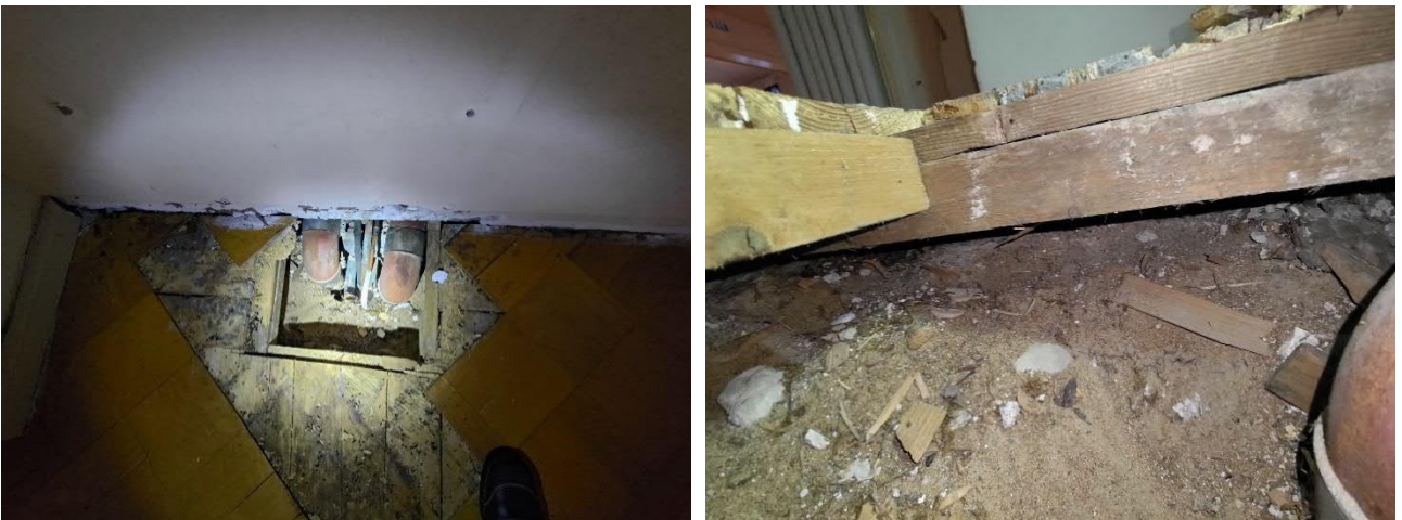
Kuva 31 ja Kuva 32. 1. kerroksen aulatilassa havaittiin avonainen rakenneavauskohta/tekniikkaläpivienti, josta voitiin tarkastella välipohjarakennetta. Avauksen ympärillä havaittiin jyrsijän ulostetta.
