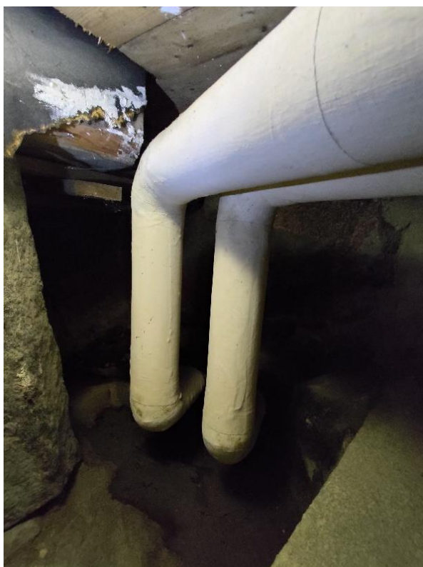
Kuva 1. Ryömintätilassa havaittiin putkia, joiden eristeissä todennäköisesti esiintyy asbestia.
