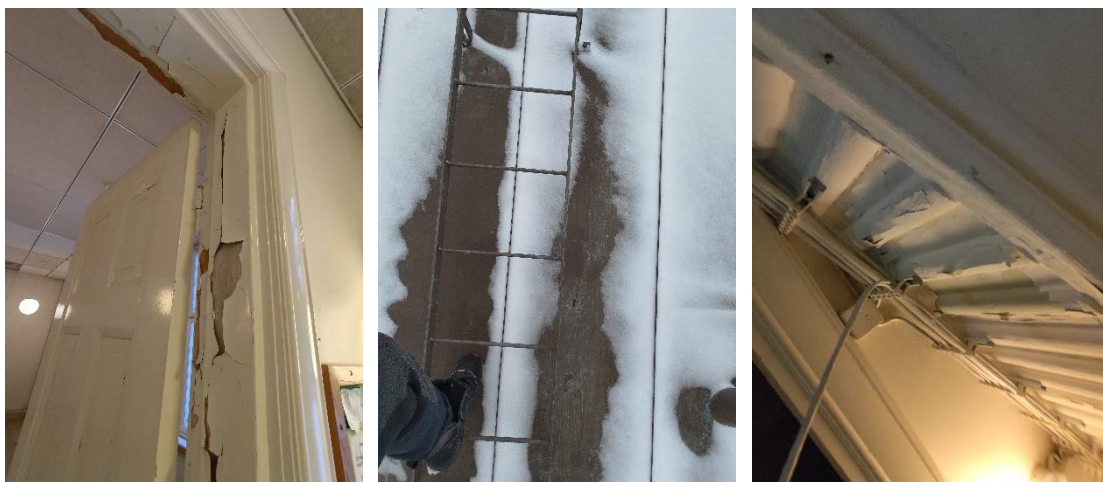
Kuva 7, Kuva 8 ja Kuva 9. Karmien, vesikatteen ja sisäkaton maalit todennäköisesti sisältävät raskasmetalleja.
