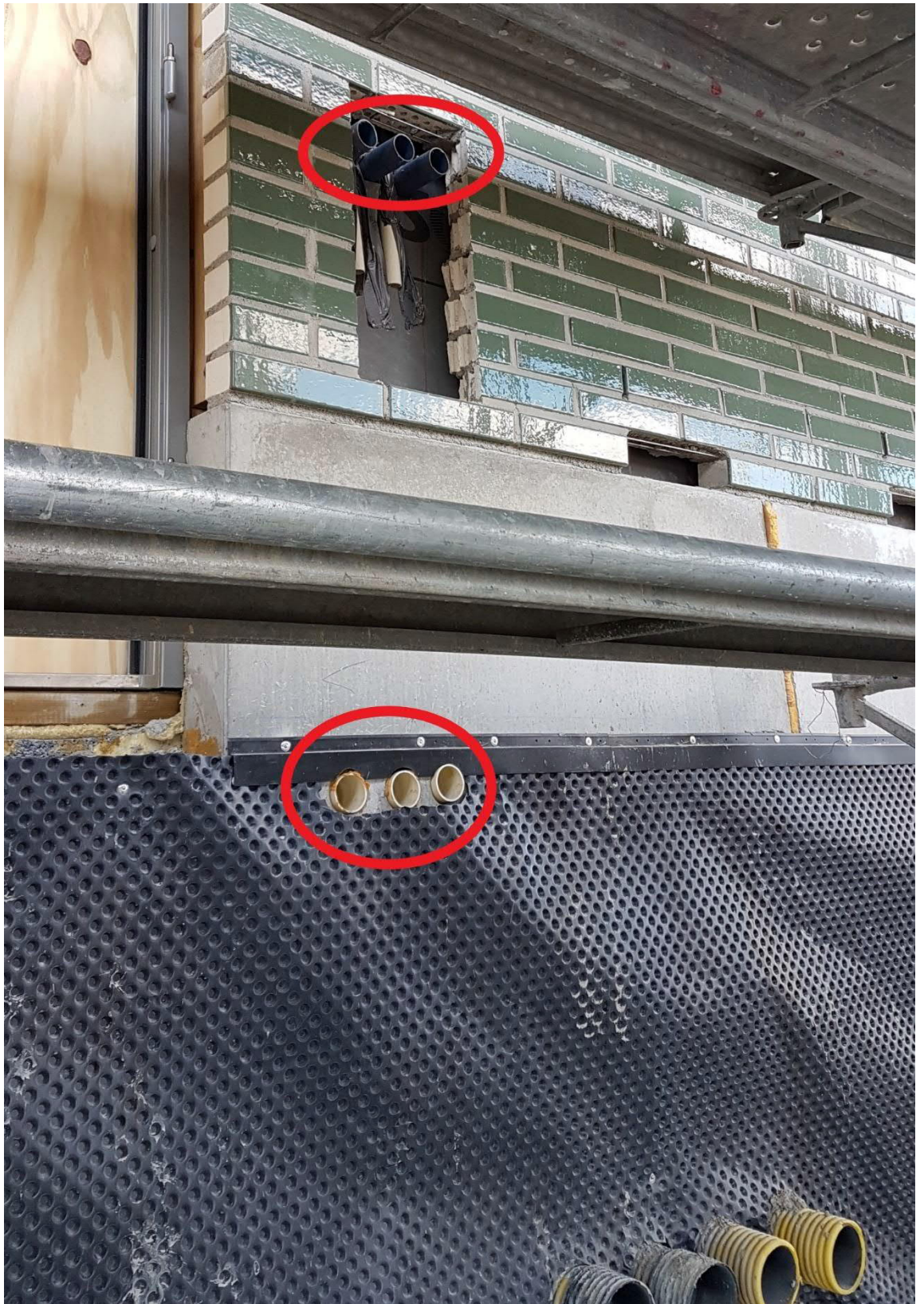
Suojaputket ovat katutasossa liian pinnassa ja putket tulevat koteloa nähden yläkautta
