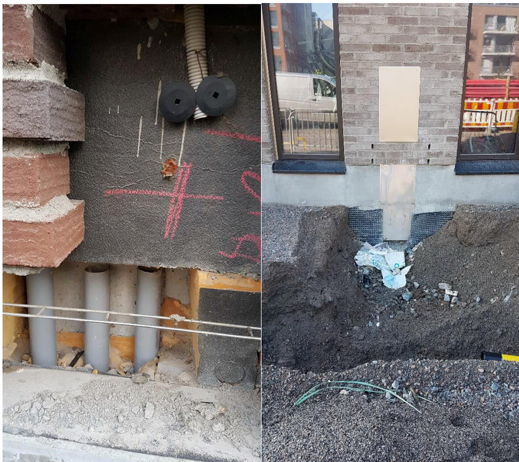
Koteloiden suoja-putket väärin asennettu tai puuttuvat kokonaan
