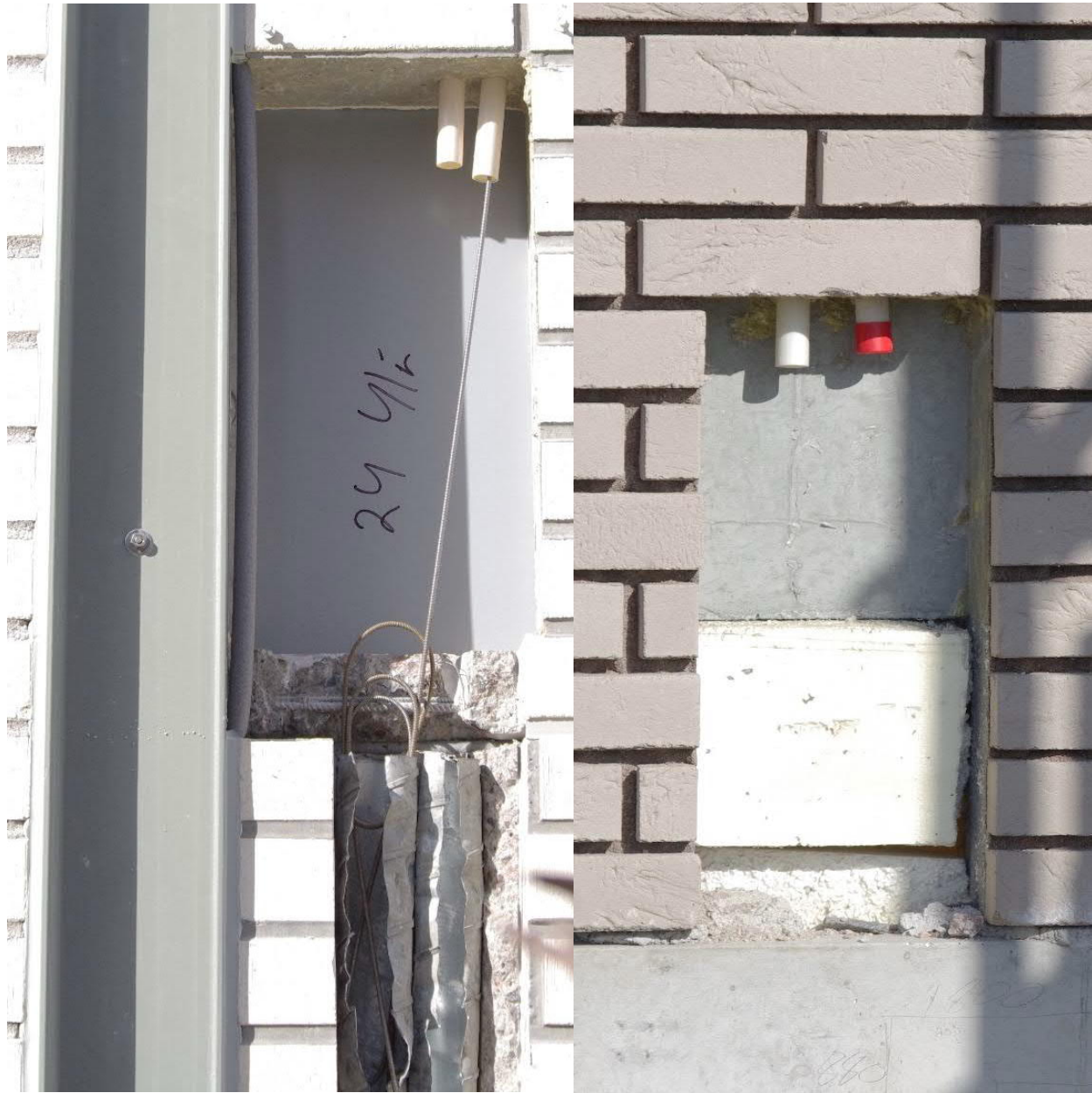
Putkitukset eivät ole määräysten mukaiset tai puuttuvat kokonaan
