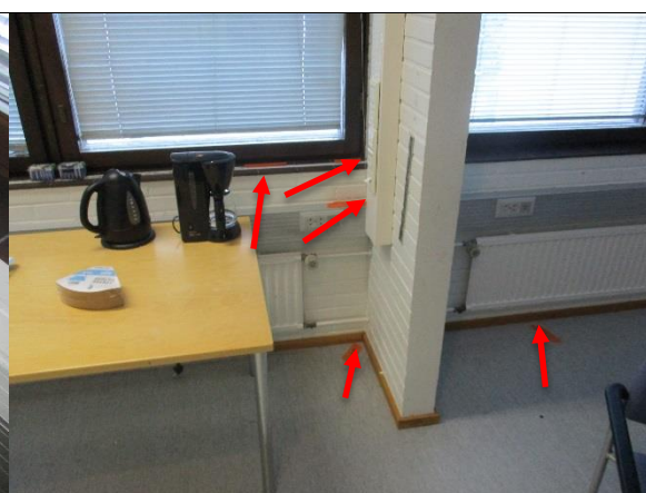
5.15 Ilmavuotokohtia studio-tilan lattia-, seinä ja ikkunarakenteiden liittymissä
