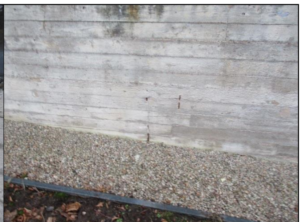
5.7 Sokkelirakenteessa paikoitellen raudoitukset näkyvillä.
