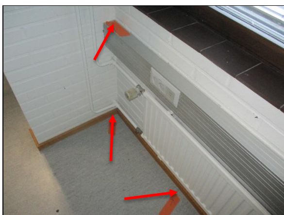
5.14 Ilmavuotokohtia studio-tilan lattia- sekä kotelorakenteissa.
