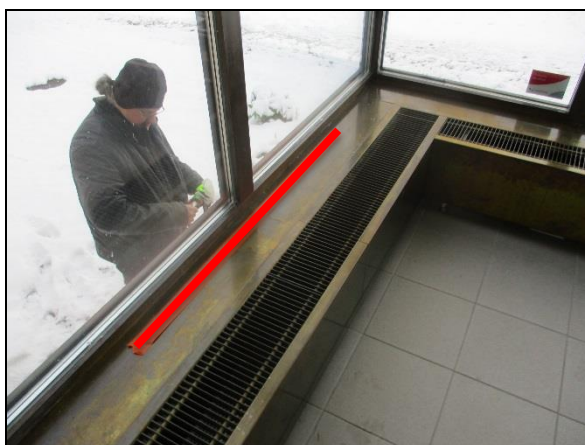
5.12 Ilmavuotokohtia vastaanottotilan kulmauksen ikkuna- ja seinärakenteiden liittymässä
