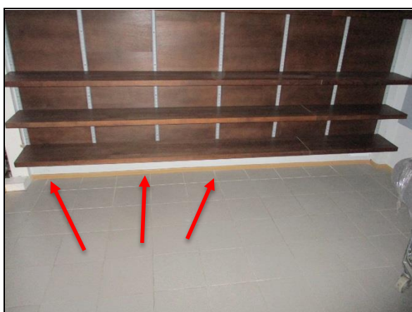
5.16 Ilmavuotokohtia aulatilan ulkoseinä- ja lattia-rakenteen liittymässä
