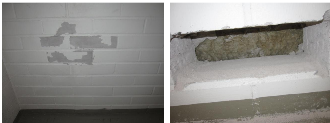
Kuvat 16 ja 17: Varastotila, maalin hilseilyä ja rakenneavaus ulkoseinällä
