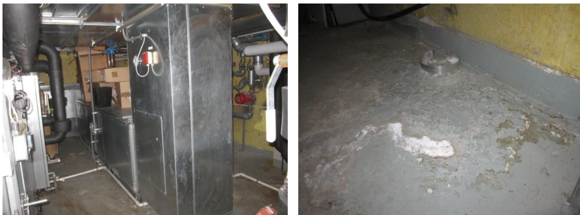
Kuvat 11 ja 12: IV-konehuone, oikealla lattian maalipinnan hilseilyä
