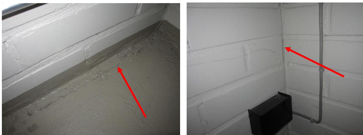
Kuvat 5 ja 6: Halkeamia taidevaraston lattialla ja nurkassa
