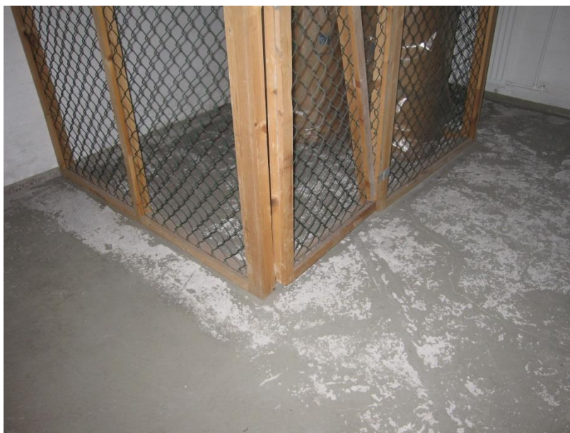
Kuva 13: Väestönsuojan lattiamaalin hilseilyä
