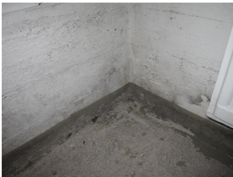
Kuva 21: Maalin hilseilyä väestönsuojassa
