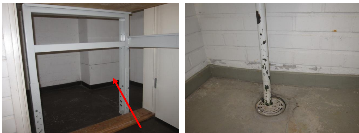
Kuvat 22 ja 23: Kotelo takaseinällä, oikealla seinämaalinhilseilyä
