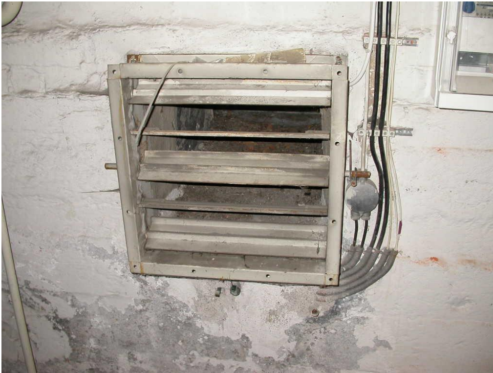
Kuva 5. Kellaritilaan virtasi korvausilmaa suuren venttiilin kautta. Ryömintätilassa tuuletusaukkoja ei havaittu.
