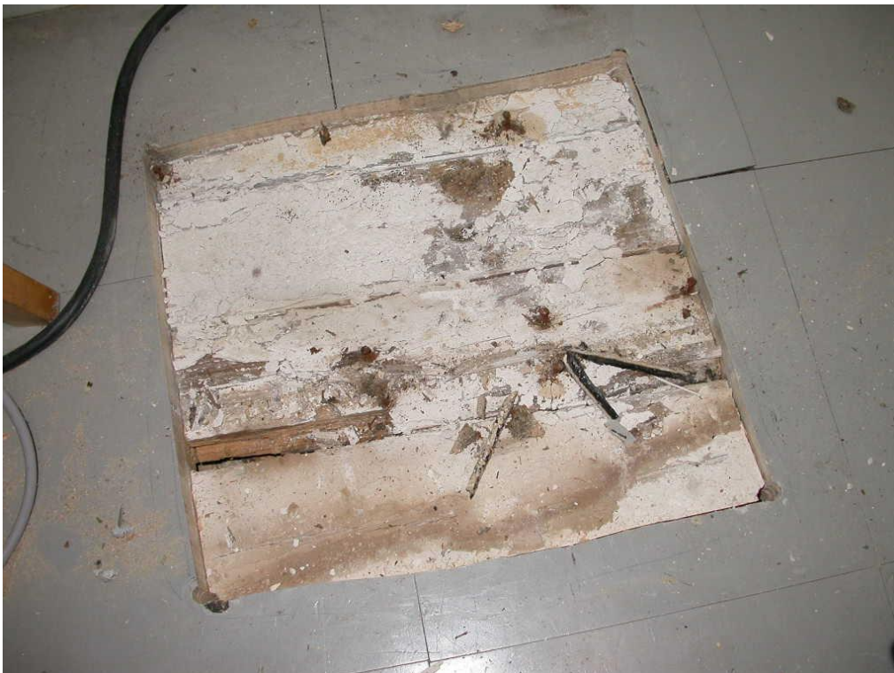
Kuva 10. Alapohjan lastulevyn ja ponttilaudan välissä on tasoitekerros, jonka vuoksi puurakenteet ovat tummuneet.
