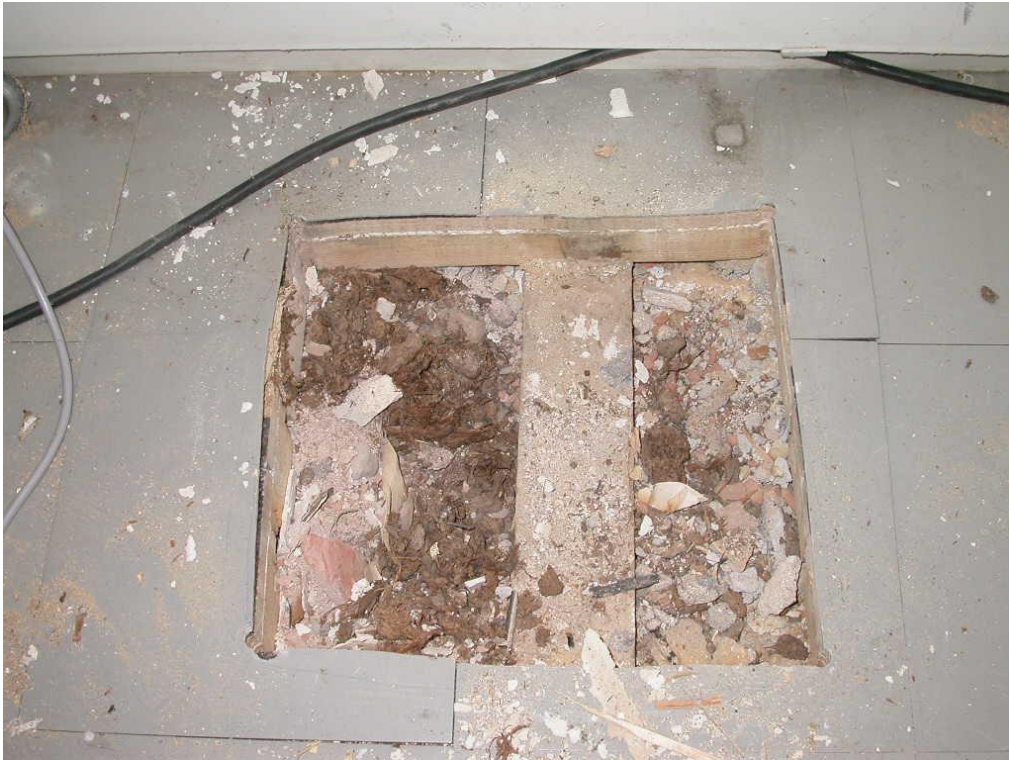
Kuva 11. Alapohjan lämmöneristeenä on turvetta. Turpeen päälle on levitetty sementtijätettä ja hiekkaa. Puurakenteet olivat avauskohdassa hyvässä kunnossa
