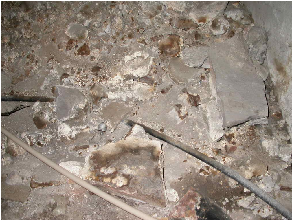
Kuva 3. Ryömintätilan maapohjanpintaa kertyneitä suoloja.
