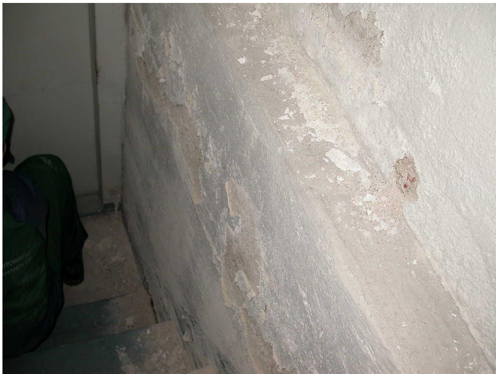
Kuva 1. Kellarin rapatun seinän vaurioita.
