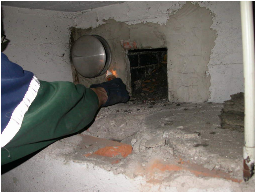
Kuva 6. Kellaritilan poistoilma virtaa osittain avoimen hormin kautta katolle.
