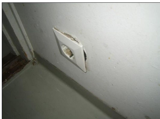
Keittiön eteistilan maadoitettu pistorasia, puutteellinen kiinnitys
