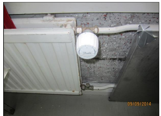
Patteriventtiilit ja termostaattianturi
