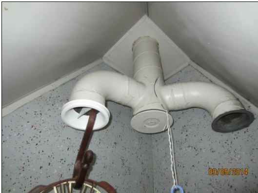
Huuvan sisällä sijaitsevia IV-putkituksia
