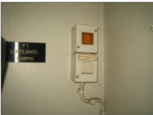
Putkiston saattolämmityksen kytkin
