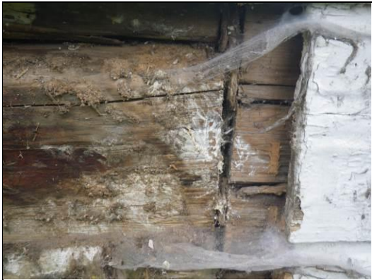
Hirressä lahovaurioita ja sienikasvustoa.
