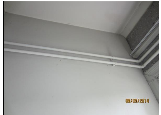
Näkyvillä kulkevia lämmityksen kytkentäjohtoja
