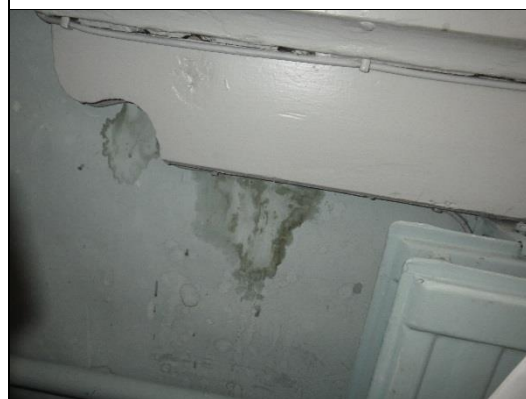
Vuotojälki ikkunan alla.
