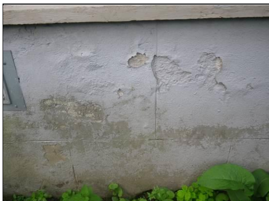
Vaurioita sokkelin ulkopinnassa
