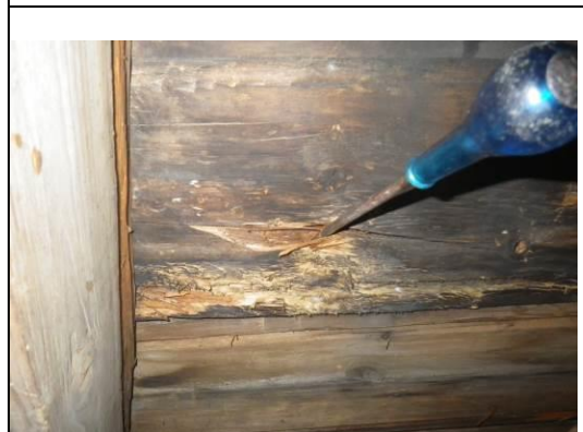
Vanhaa (lahoa) vesikatteen aluslaudoitusta.
