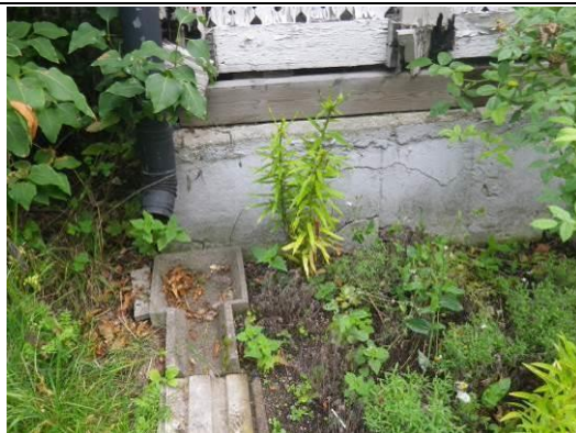
Syöksytorven asemointi on virheellinen.
