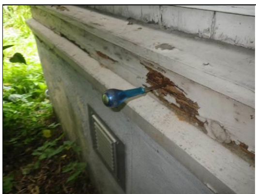
Alimmassa hirressä lahovaurio.
