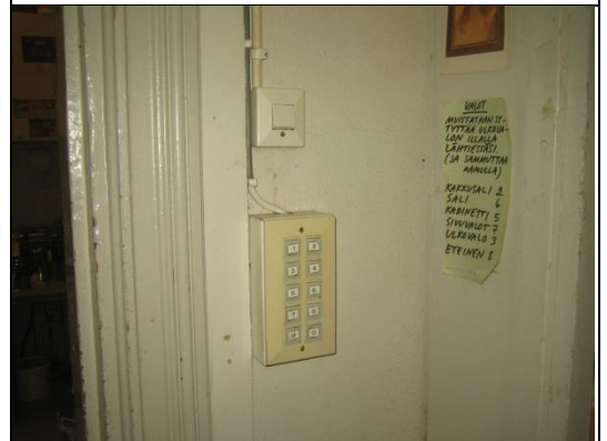
Valaistuksen pienoisjänniteohjaus ja perinteinen kytkinohjaus
