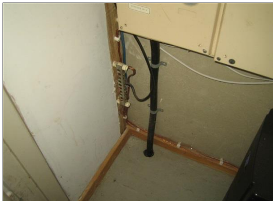
Potentiaalintasauskisko ja keskuksen nousukaapeli
