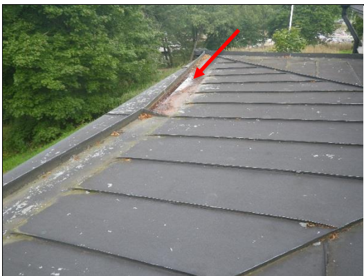
Takakuistin katto, lammikoitunutta vettä.
