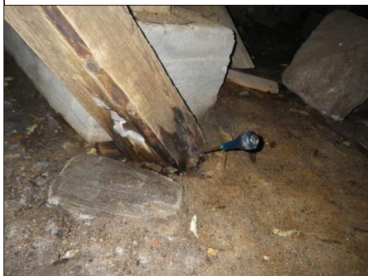
Alapohjan vanhaa puurakennetta
