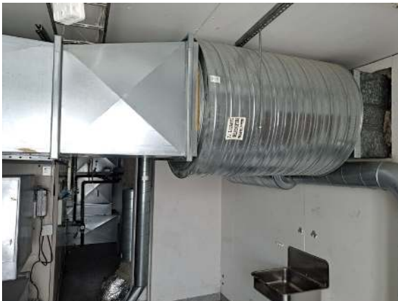
114. Ilmanvaihtokanavaa IV konehuoneessa.
