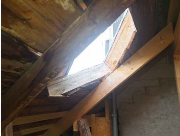
1. Vesikatolle johtava luukku oli avoinna.
