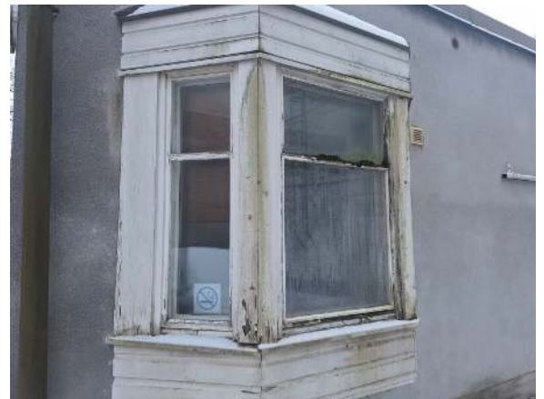
48. Osassa ikkunoita laaja-alaisia vauriota.
