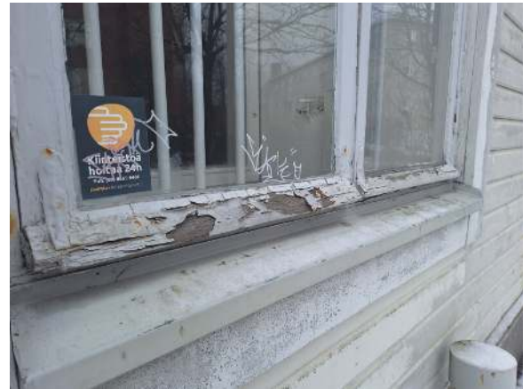
50. Ikkunoissa vähäisempiä vauriota.
