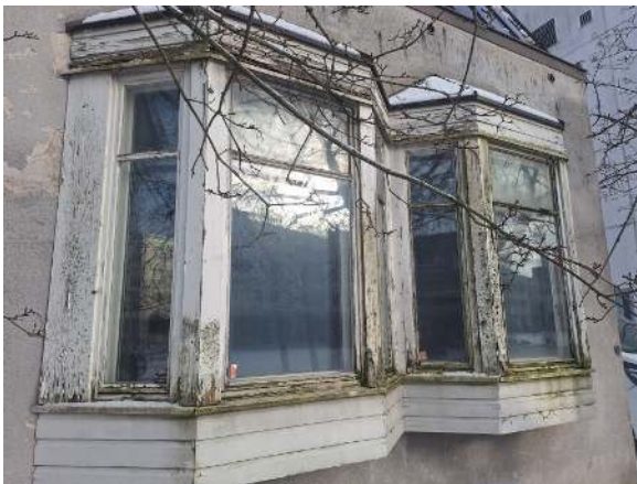
47. Osassa ikkunoita laaja-alaisia vauriota.
