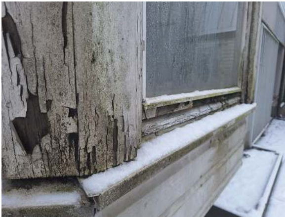
49. Osassa ikkunoita laaja-alaisia vauriota.
