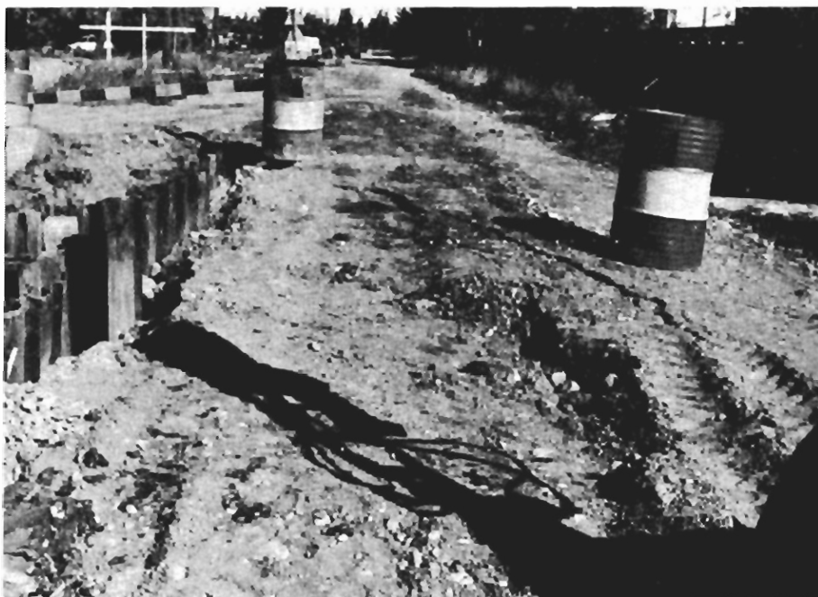
Kuva 13. Kaivannon pohjan noustessa viereinen katu on painunut. Suutarila Pohjantähdentie.
