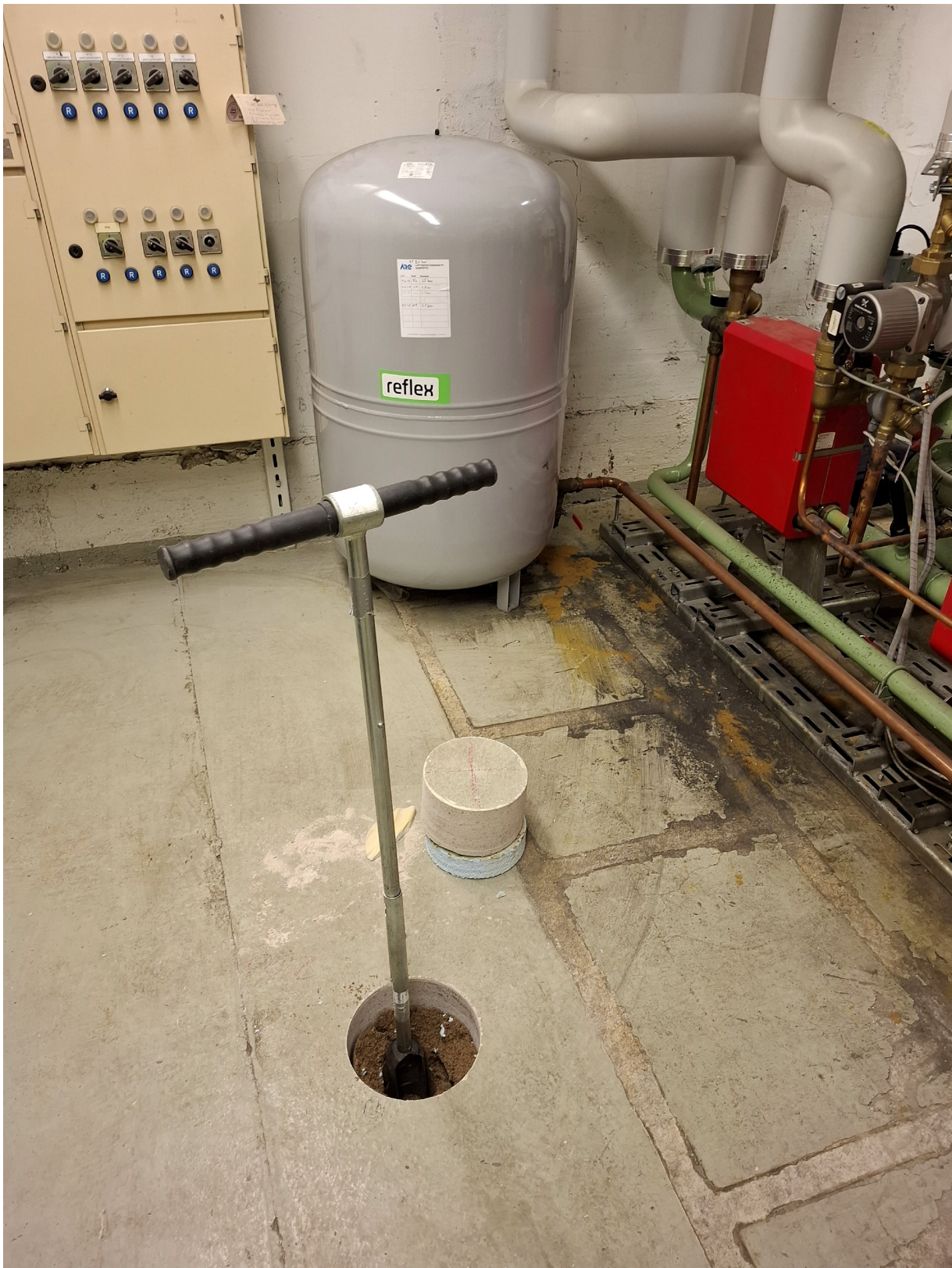
Kuva 7. Lämpösiirrin ja näytteenottoväline nähtävissä näytepisteessä SE7. Lämpösiirrin halkaisija oli 200 mm.
