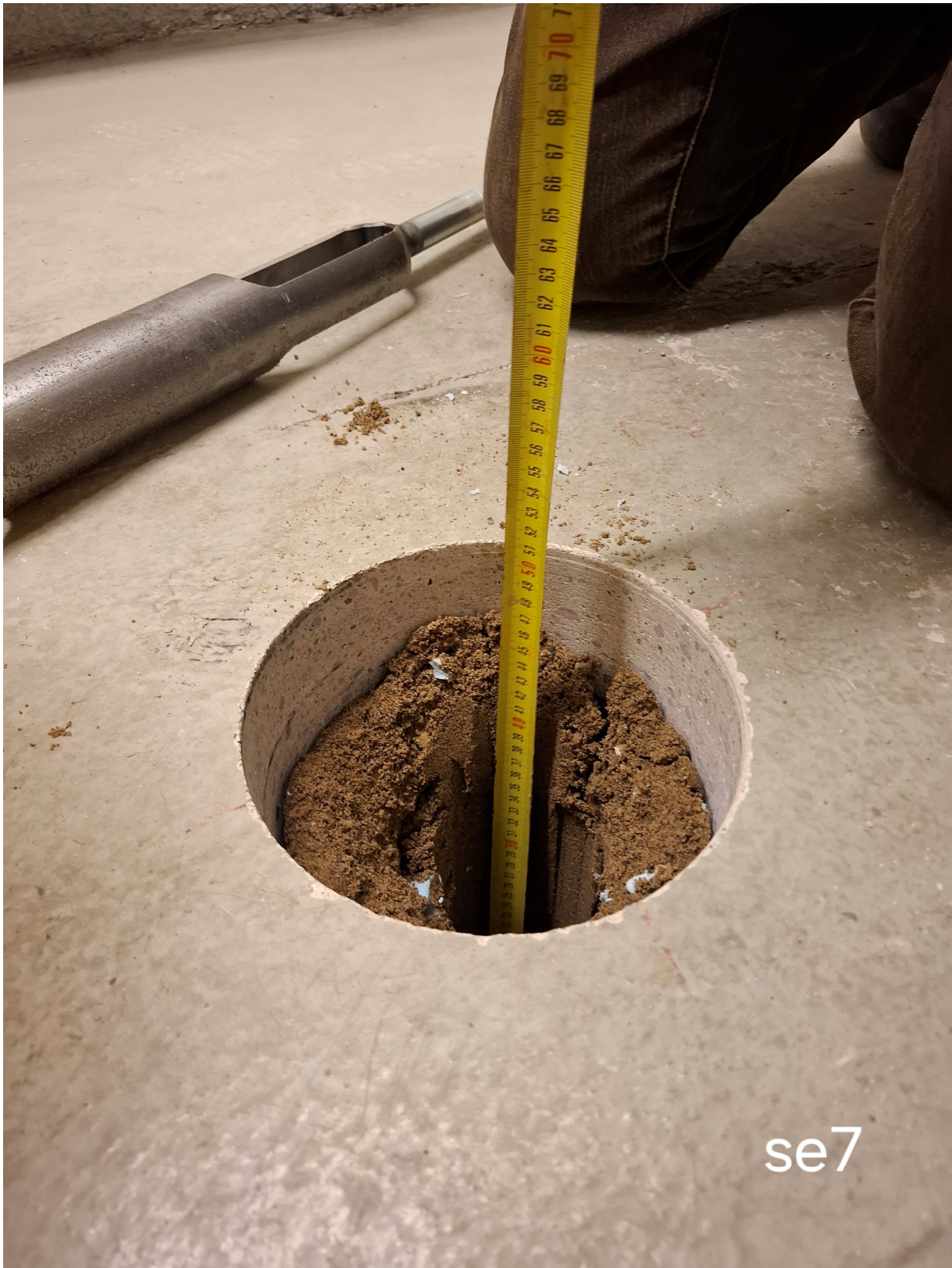
Kuva 6. Näytepisteen SE7/0,0-0,5 m näytteenottopiste. Näyte saatiin käsikairan avustuksella noin 0,5m syvyydestä. Maaperää vasten routamatto, jonka päällä betonilaatta.
