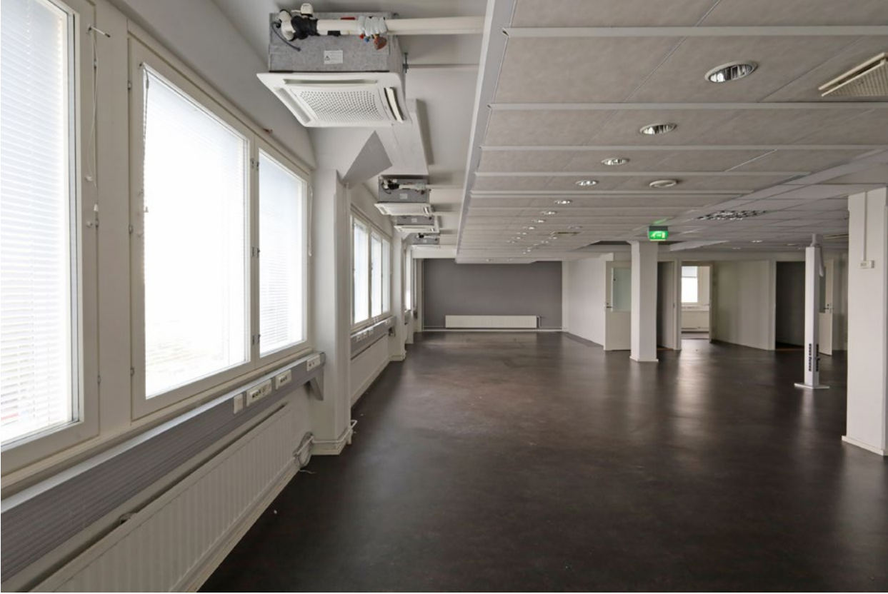
Jäähdytyskojeet on sijoitettu lähelle ikkunaseinää.
