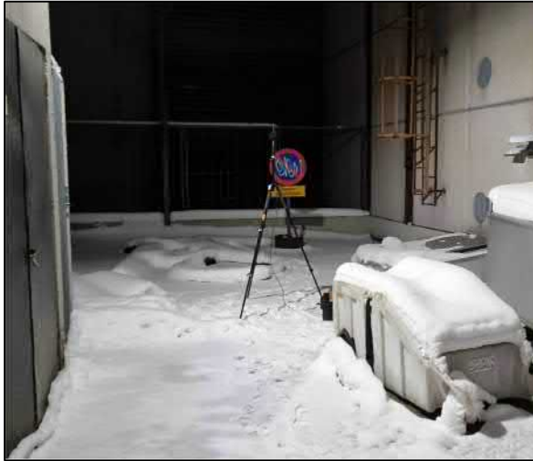
Kuva 3. Lämpökeskuksen mittauspiste 1A.
