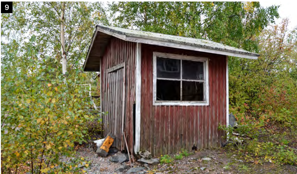
↑ Valkosaaren telakka -juhlailan vieressä saaren itärannalla on pieni huonokuntoinen vajarakennus telakkatoiminnan ajalta.
