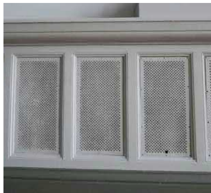
Keskiakselissa tuloilmanvaihto on koriste-verkon takana.
