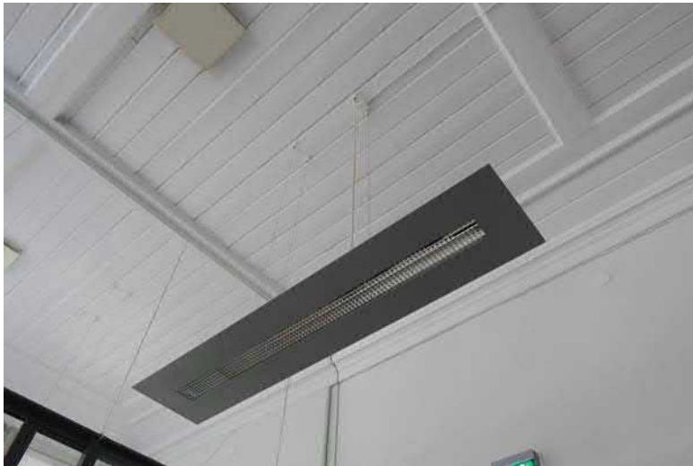
Toimistuhuoneissa Louis Poulsenin vaijeriripusteiset loisteputkivalaisimet antavat osin epäsuoraa valoa ylös, osin suoraa valoa alas.
