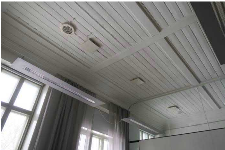
Kolmannessa kerroksessa ilmanvaihto tulee katon kautta. Kuvassa sekä tulo- että poistoelimet.
