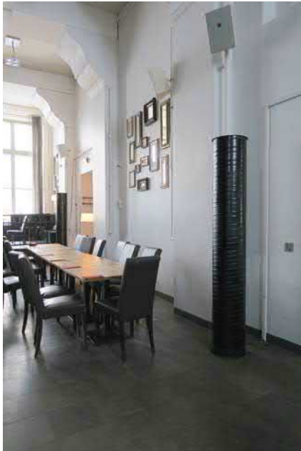
Ravintolasalin tuloilmaa varten on kaksi syrjäytävän ilmanvaihdon mustaksi maalattua putkea.
