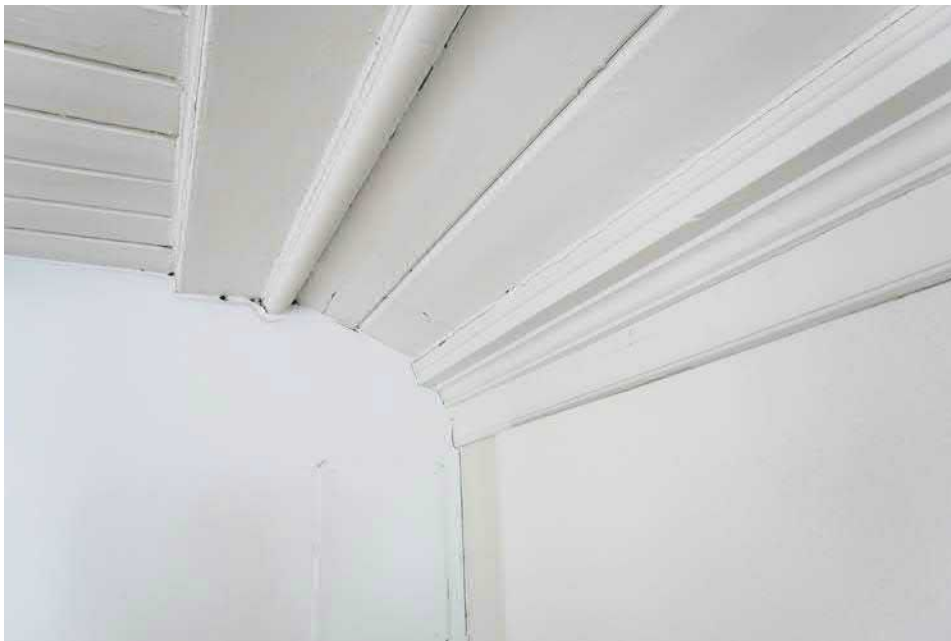
Tilan 218 moniosainen kattolista (”vanha friisi”), joka kohtaa levyseinärakenteisen IV-kuilun, missä listaa ei suunnitelmien mukaan ole lisätty koteloa kiertämään (tms.)-
