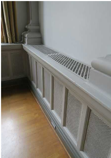
Vanha pedestaalirakenne, jonka taakse piilotettuna talotekniikkaa.
