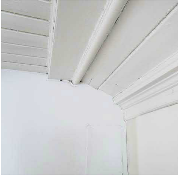
Vanha moniosainen kattolista kohtaa pystyn IV-kotelorakenteen seinän.
