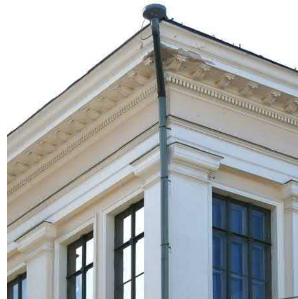
Räystään ulkonurkan rappausvauriota lukuun ottamatta julkisivujen yleisilme on huomattavan siisti ja ehjä. 4/2024.
