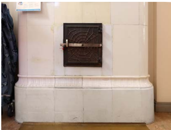
↑ Rak. 14. Kaakeliuunin etuseinämän kaakelipinnoissa näkyvät muutosjäljet. amoy 2024
